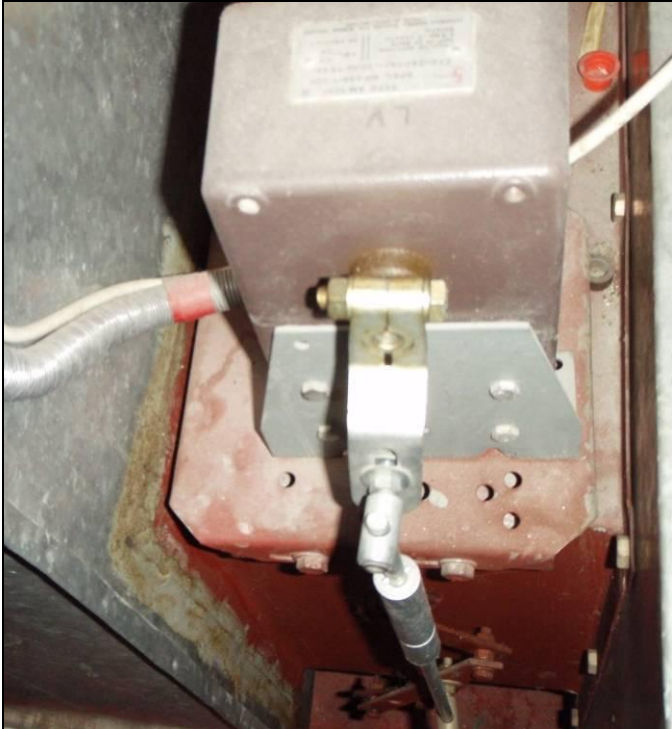
S-kuva 26 Yleiskuva ilmanvaihtojärjestelmän kenttälaitteista.
