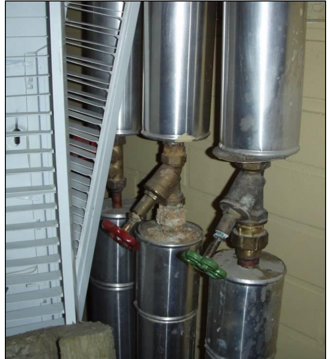
LVI-kuva 8 Käyttövesiverkoston runkolinjat lähtevät lämmönjakohuoneesta lattiarakenteen sisälle.
