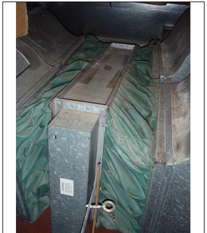
LVI-kuva 18 Yleiskuva lämmöntalteenottokennosta
