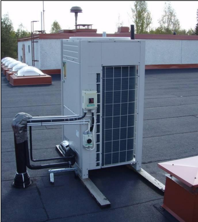
LVI-kuva 19 Yleiskuva suuremmasta jäähdytyskoneesta
