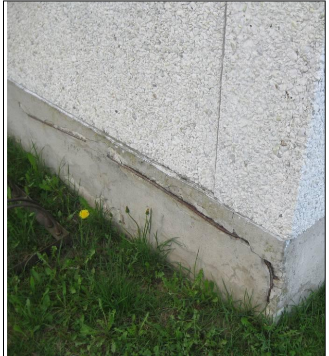
RAK-kuva 10 Sokkeliosalla betoniteräksiä näkyvillä
