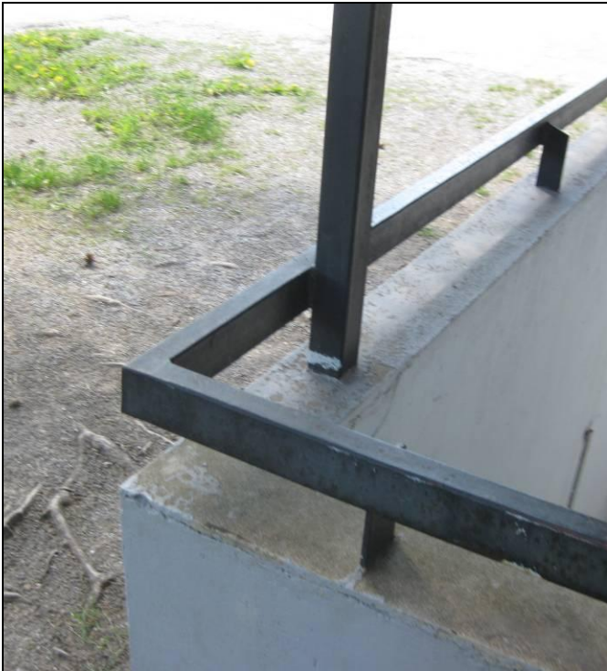
RAK-kuva 5 Kellariportaan päällä oleva n ka- toksen ja suojakaiteen teräsosat ovat ruosteisia.
