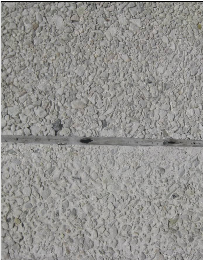
RAK-kuva 19 Elementtien välisissä elastisissa saumauksissa on reikiä.
