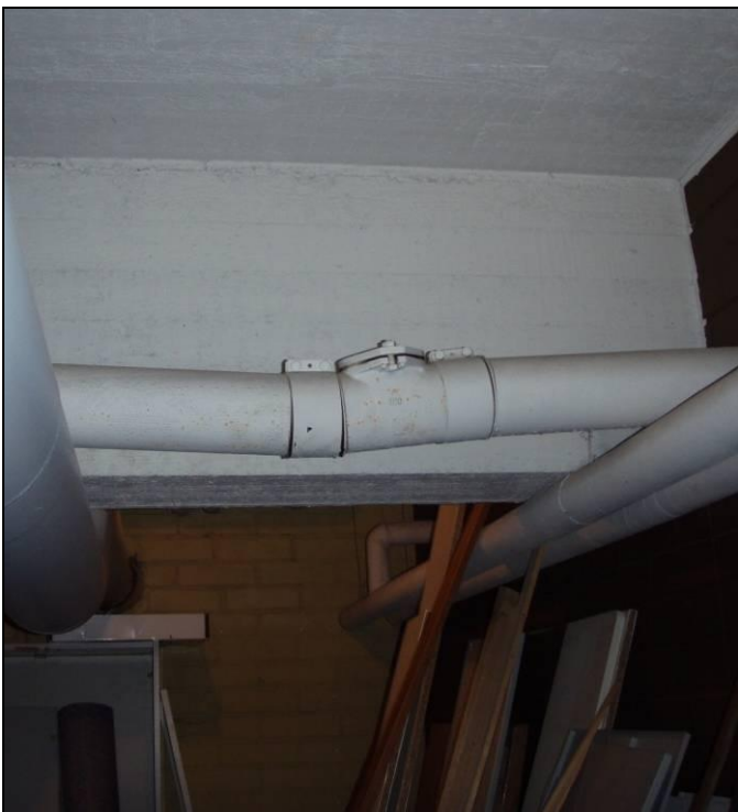
LVI-kuva 13 Viemäreiden kannakoinnissa havaittiin puutteita.
