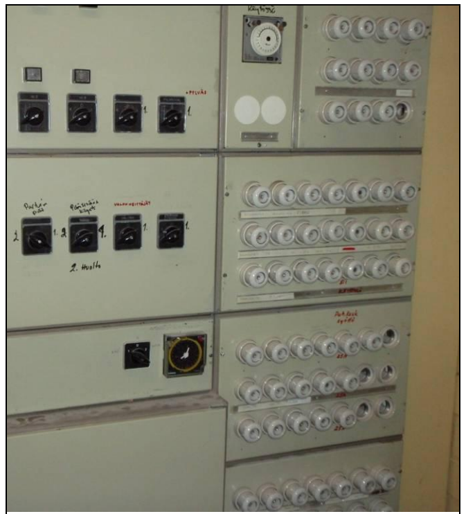
S-kuva 5 Sähkökeskuksissa havaittiin kosketussuojapuutteita.
