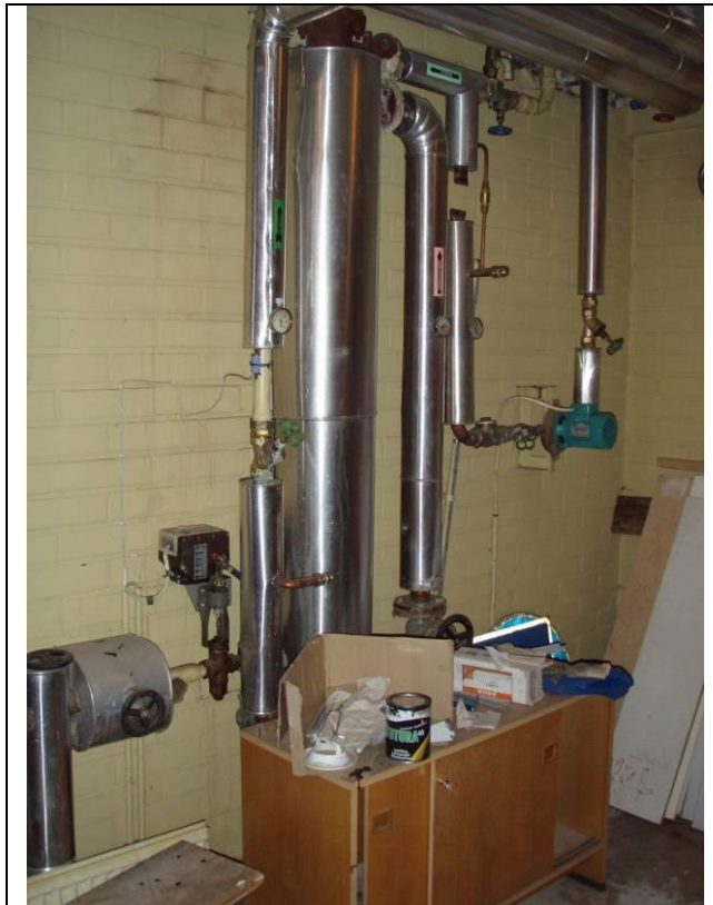
LVI-kuva 2 Yleiskuva lämmönjakohuoneesta
