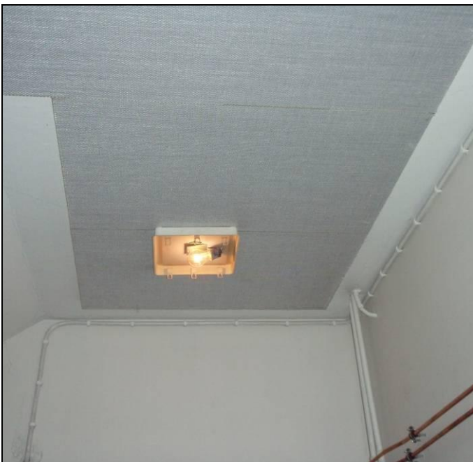
S-kuva 16 Yleiskuva porrashuoneen valaistuksesta
