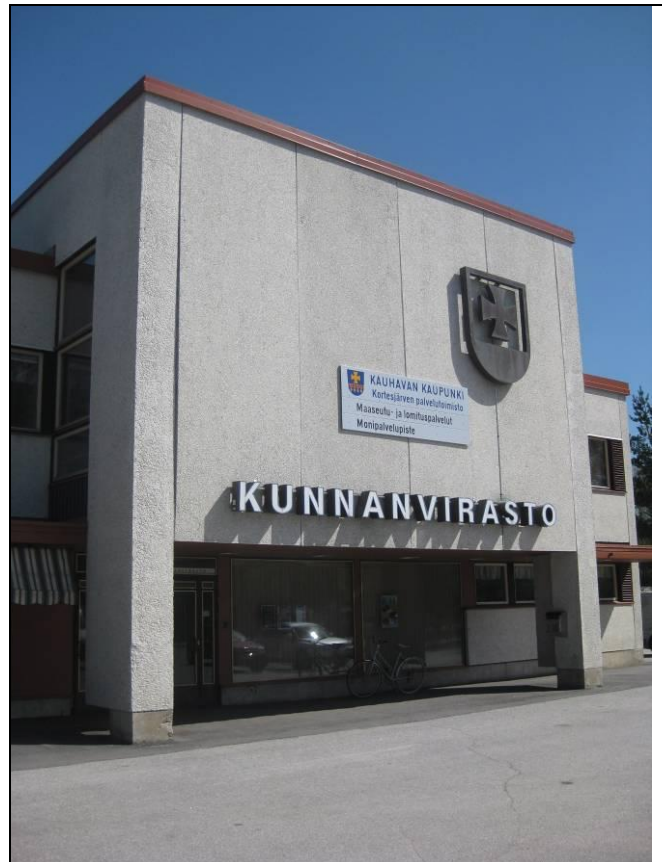
RAK-kuva 20 Valtuustosalin kohdalla kuorielementeissä esiintyy näkyvää käyritystä.
