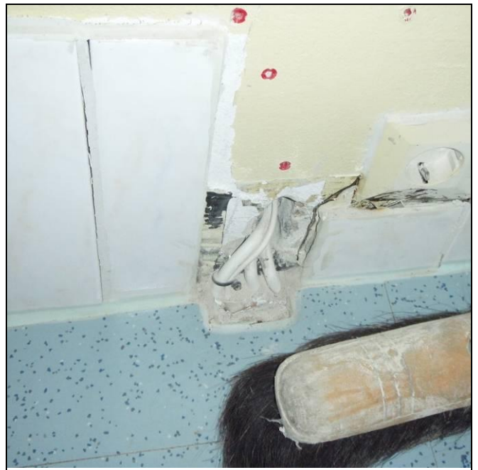
S-kuva 21 Lattialämmityksen suojaamattomat asennukset tulevat korjattua asianmukaisiksi.
