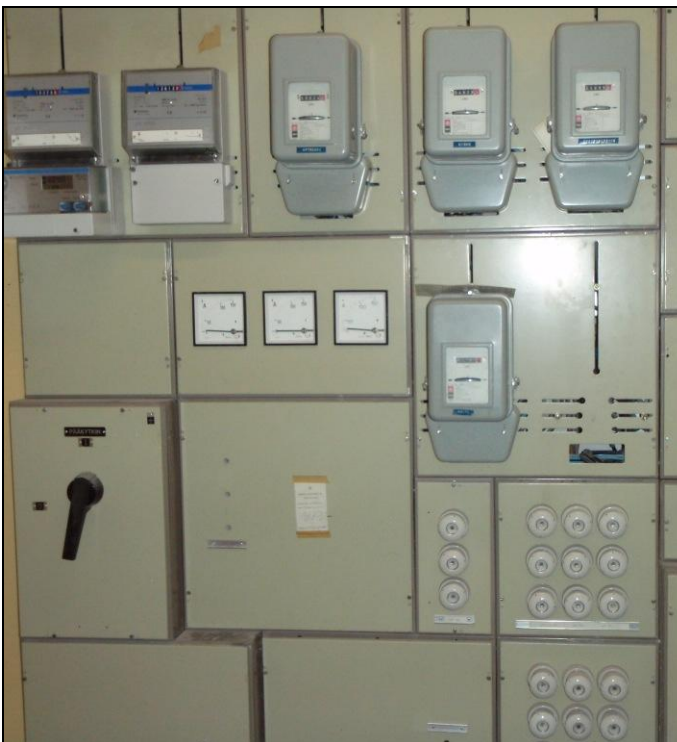
S-kuva 4 Yleiskuva sähköpääkeskuksesta
