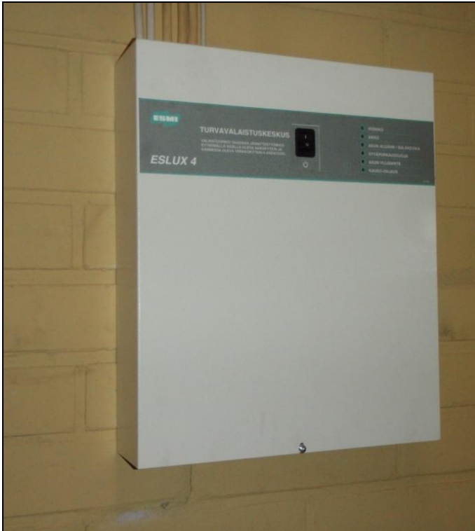
S-kuva 22 Yleiskuva turva- ja merkkivalaistuksen keskuksesta.
