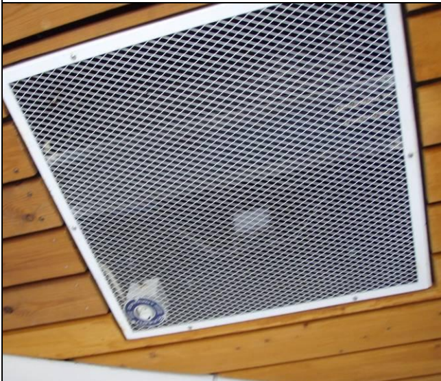
LVI-kuva 5 Puhallinpatterin toiminta tulee tarkastaa, koska kone oli päällä vaikka ulkolämpötila ei sitä olisi edellyttänyt.
