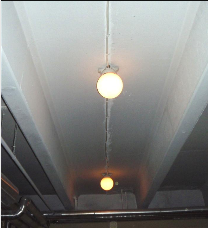
S-kuva 14 Yleiskuva kellaritilan valaistuksesta
