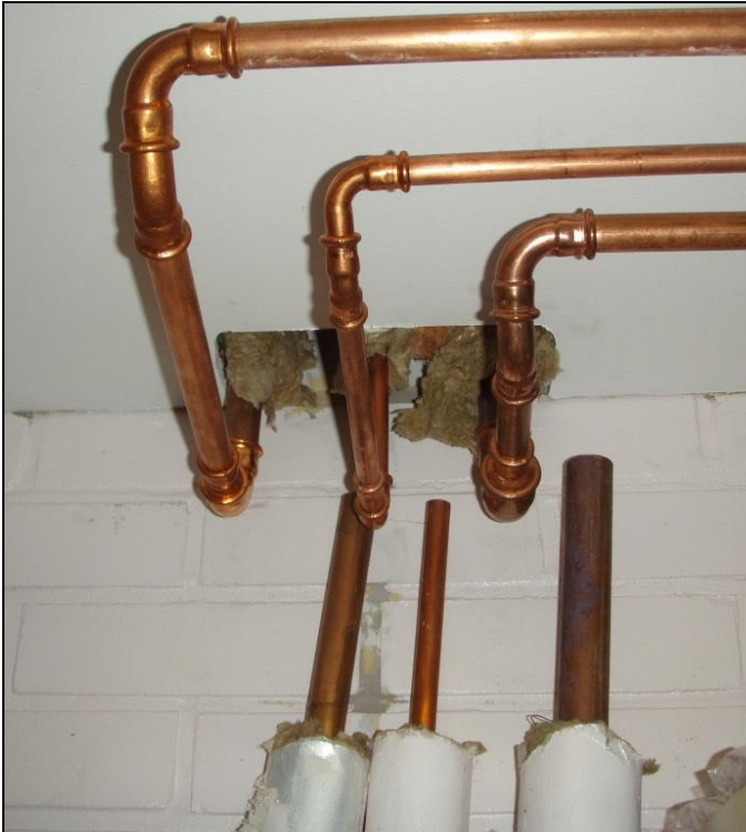
LVI-kuva 11 Uusitut runkolinjat ovat paikoin pienempiä mitä alkuperäiset nousulinjat.
