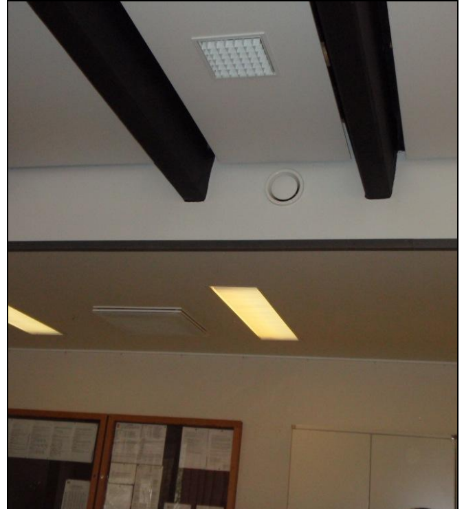
S-kuva 15 Yleiskuva sisääntuloaulan valaistuksesta
