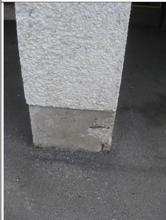
RAK-kuva 11 Etupihan puolen pilarin alaosassa teräksiä näkyvillä
