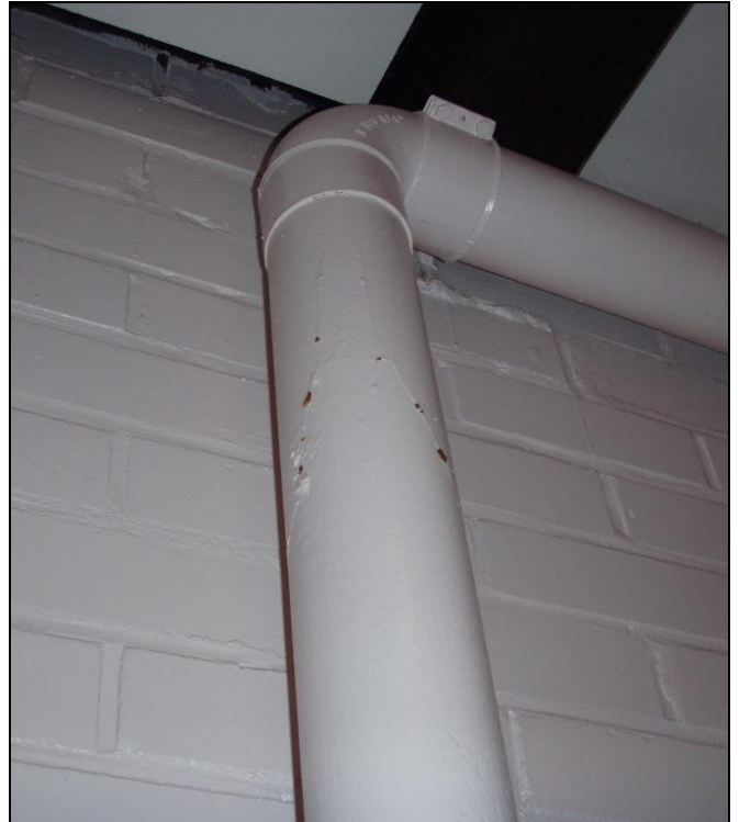
LVI-kuva 12 Viemäreissä havaittiin läpi syöpyneitä kohtia.
