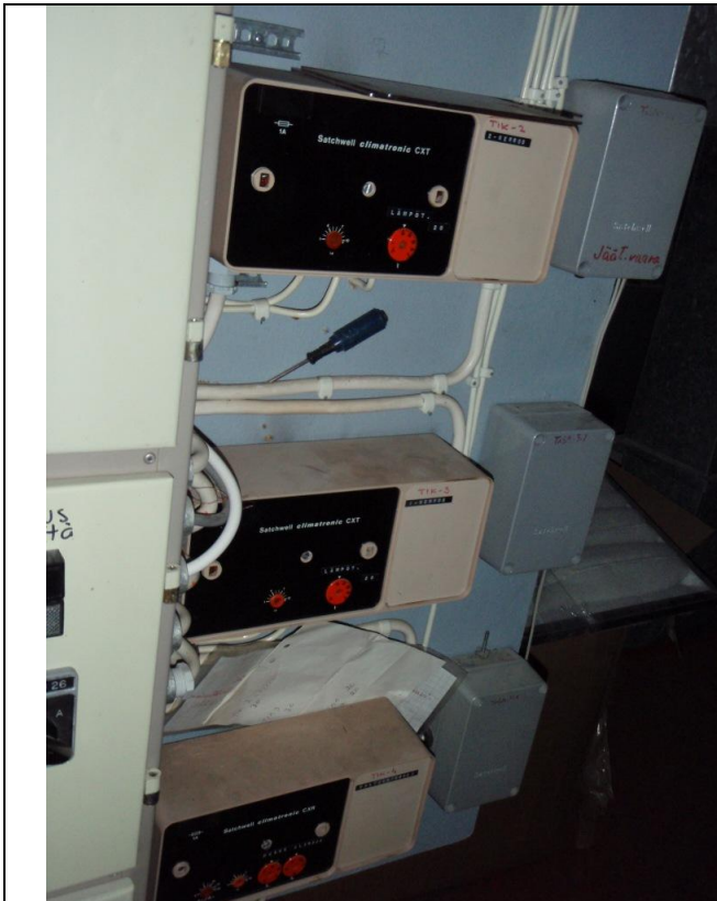
S-kuva 24 Yleiskuva säätöjärjestelmän alkuperäisestä säätökeskuksesta.
