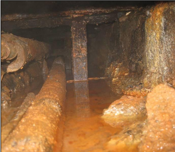
RAK-kuva 13 Putkikanaalin pohjalla vesi. Kanaalissa purkamattomia tuki puita ja muottilautoja. Puuosat lahovaurioituneet
