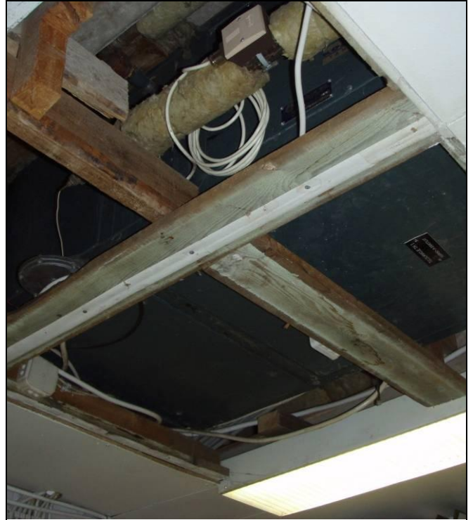
LVI-kuva 16 Yleiskuva nuorisotilan tuloilmakoneesta.
