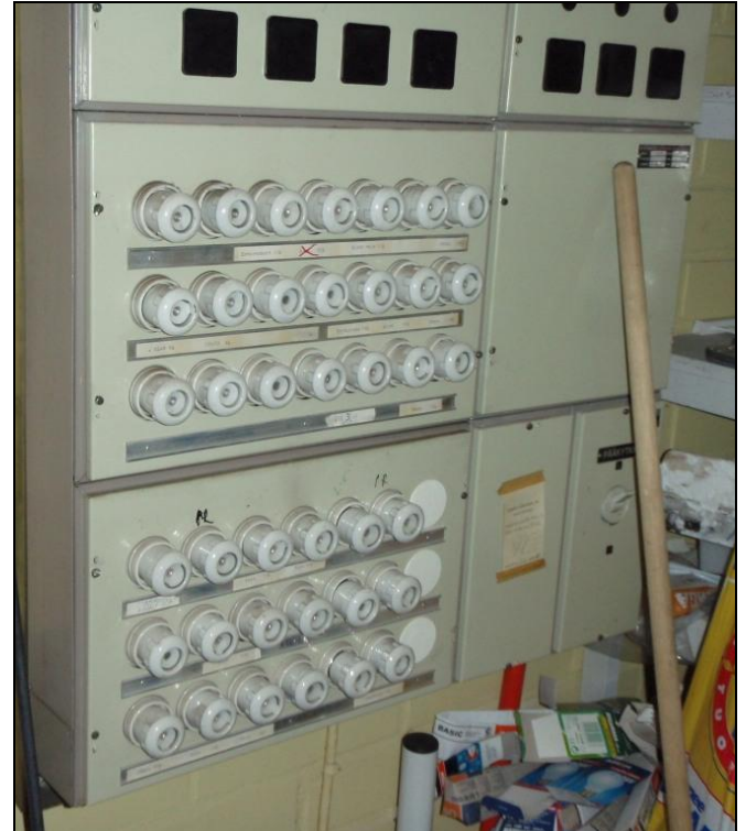
S-kuva 7 Yleiskuva ryhmäkeskuksesta. Keskuksilassa on ylimääräistä tavaraa
