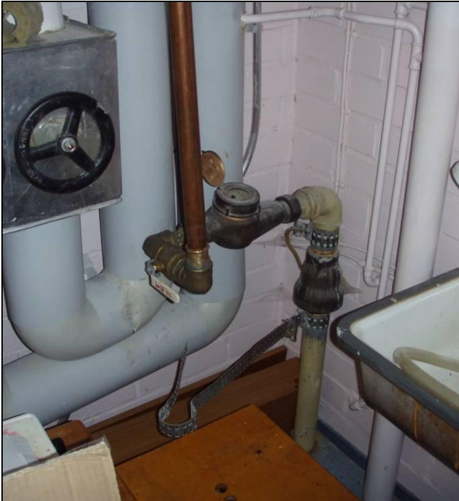
LVI-kuva 7 Yleiskuva vesimittarista ja pääsulkuventtiileistä.
