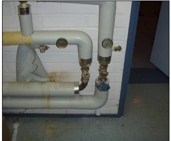
LVI-kuva 4 Lämpöverkoston venttiilit ovat alkuperäisiä.
