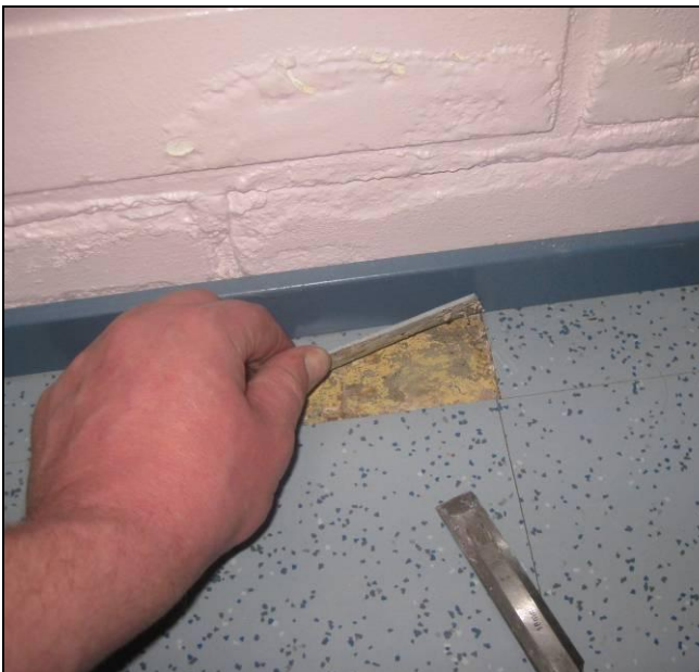
RAK-kuva 15 Nuorisotilan kerhohuoneessa vinyylilaatan alustan liima-aines on vettynyttä, betonipinta on märkä ja tiiliseinän alaosa on näkyvästi kosteusvaurioitunut ja märkä.
