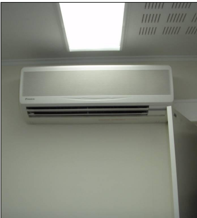
LVI-kuva 21 Yleiskuva huonetilan puhallinkonvektorista
