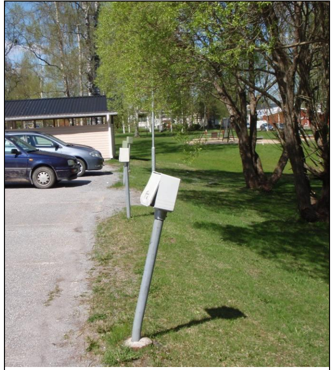
S-kuva 3 Autolämmityspistorasiakotelo tulee suoristaa.
