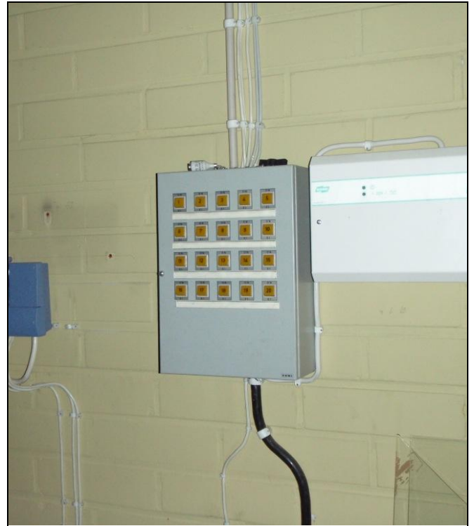
S-kuva 23 Yleiskuva säätöjärjestelmän uudesta säätökeskuksesta ja hälytyskeskuksesta.
