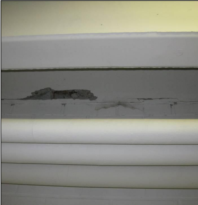
RAK-kuva 17 Kellarikerroksen varastohuoneessa kevyen tiiliseinän kohdalla TT-laatassa lohkeama.
