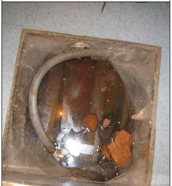
RAK-kuva 12 Kellarikerroksessa kahvion edustalla putkikanaalissa vesi lähes lattian tasolla
