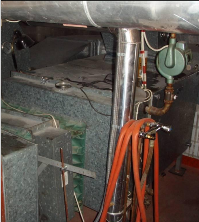
LVI-kuva 15 Yleiskuva ilmanvaihtokonehuoneesta.
