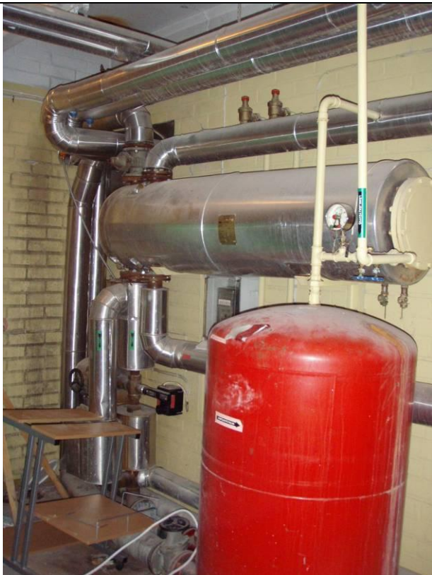
LVI-kuva 1 Yleiskuva lämmönjakohuoneesta.
