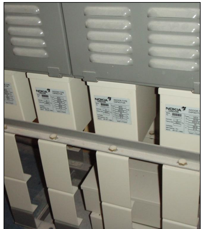
S-kuva 9 Yleiskuva kompensointiparistoista
