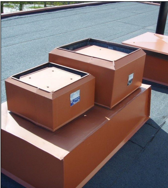
LVI-kuva 17 Yleiskuva huippuimureista.
