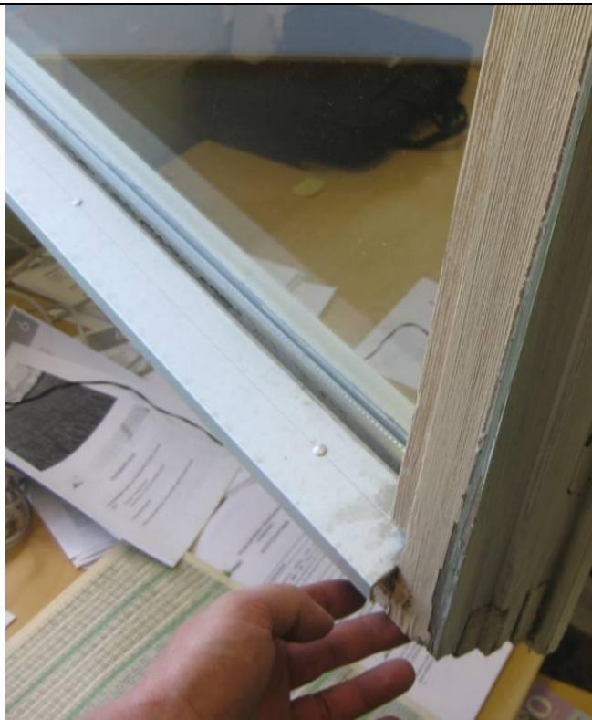
RAK-kuva Toisen kerroksen puuikkuna. Ulko- puolen maalauspinnaat ovat kuluneita 23
