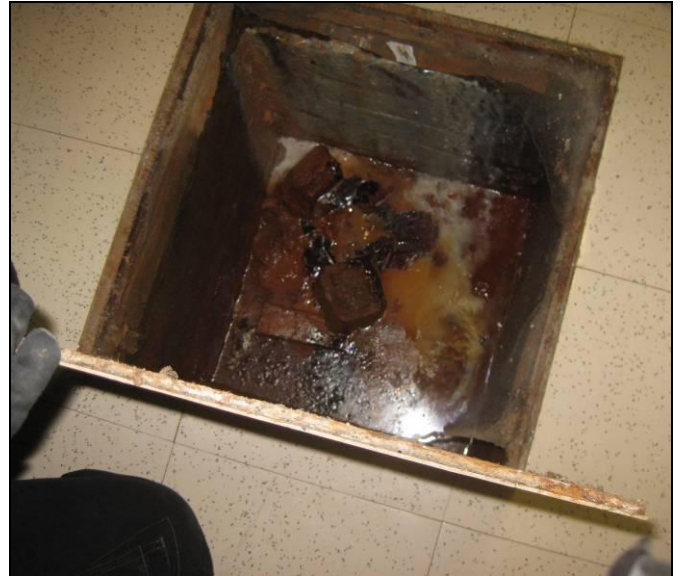
RAK-kuva 14 Kellarikäytävällä viemärin tarkastuskaivossa vesi. Lattialaatan alapinnan tasolta kaivoon valuu vettä
