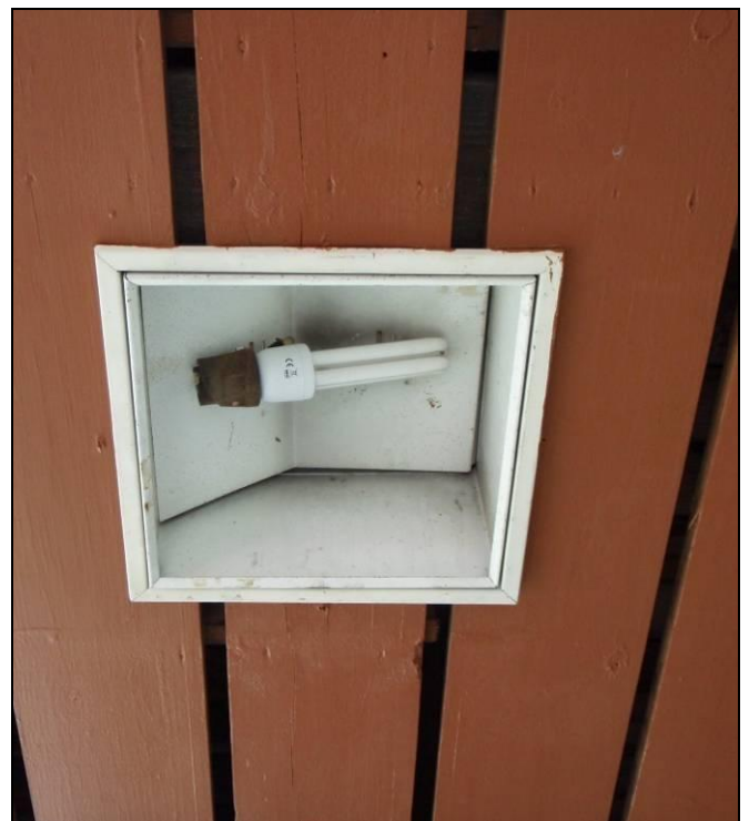
S-kuva 1 Yleiskuva sisäänkäynnin valaistuksesta.
