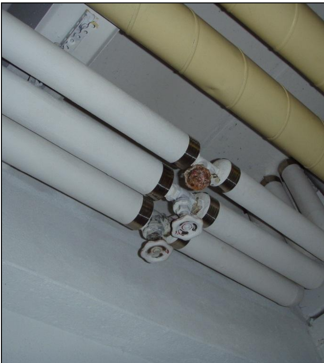
LVI-kuva 9 Käyttövesiverkoston venttiilit ovat alkuperäisiä ja huonokuntoisia
