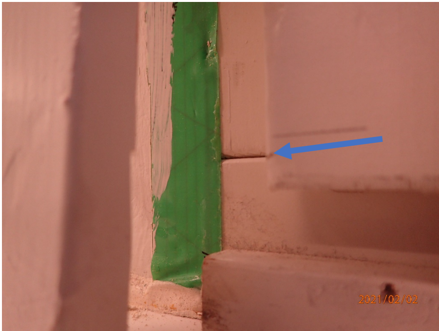
Kuva 1. Karmin ja ulkoseinän väli tiivistetty höyrysulkuteipillä. Karmin liitoksissa havaittiin säännönmukaisia vuotopaikkoja.
