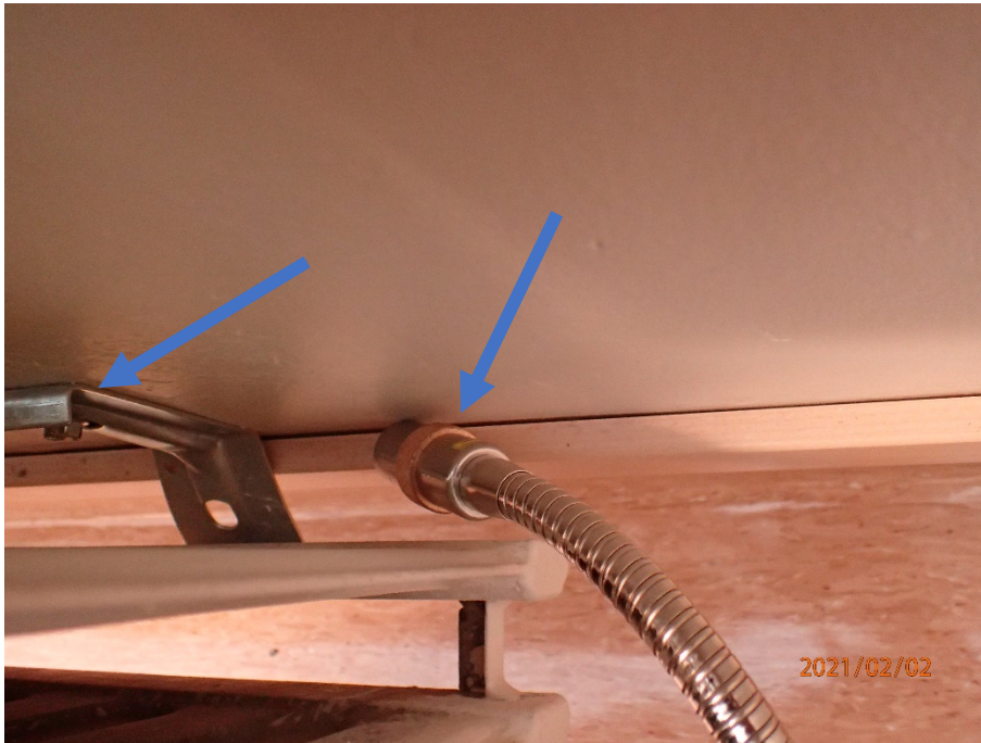
Kuva 2. Muutamissa kohdin havaittiin lievää ilmavuotoa maton ja seinän rajapinnalla. Suosituksena tiivistää maton ja seinän rajapinta vedeneristeellä, esimerkiksi Elaproof Indoor tiivistysaineella. Oikean puolen patterikannakkeen kohdalla havaittiin myös ilmavuotoa.
