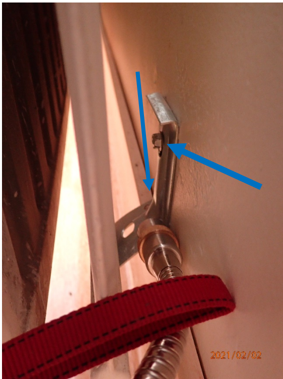
Kuva 7. Osassa pattereiden kiinnityskohdissa havaittiin vähäistä ilmavuotoa.
