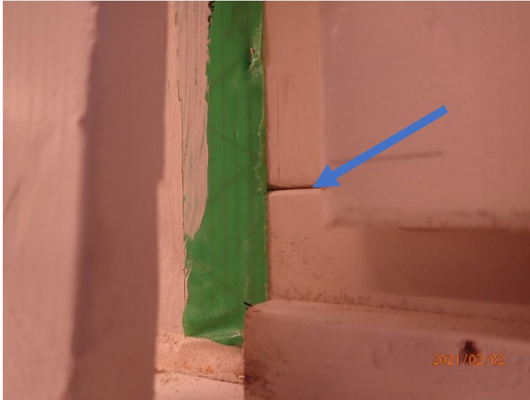
Kuva 6. Ikkunoiden ja ulkoseinien välit on tiivistetty teippaamalla ja asentamalla lista päälle. Karmin liitosten kautta havaittiin vähäistä ilmavuotoa. Karmin ja seinän välit on tiivistetty ilmasulkuteipillä.
