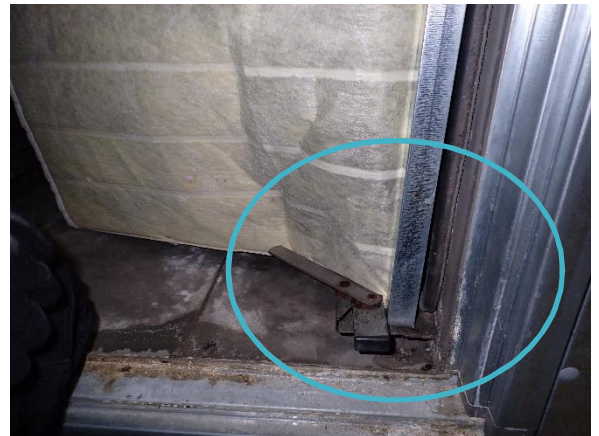
Kuva 46 Suodattimen asennuskehikkoa ei ole suljettu, jolloin suodattimen kiinnitys ei ole tiivis.
