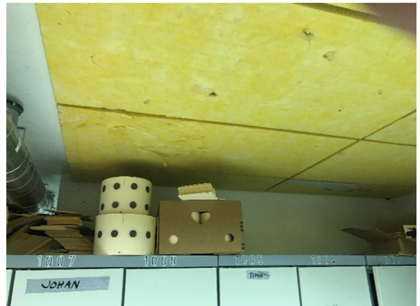
Kuva 41 Osittain akustiikkalevyjen pinnoitus puuttuu kokonaan.
