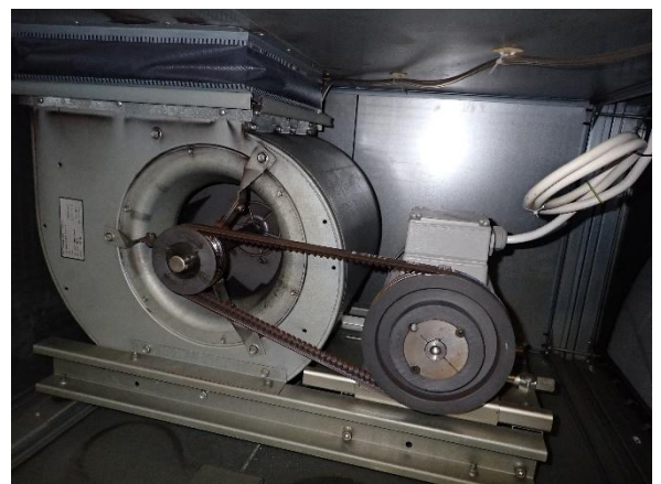
Kuva 54 Koneen puhaltimet ovat hihnakäyttöisiä keskipakopuhaltimia.
