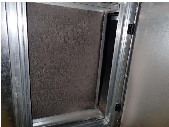
Kuva 53 Äänenvaimentimien pintaan on kertynyt pölyä.
