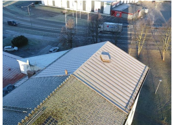
Kuva 39 Yleiskuvaa Kauppaticien puoleisen laajennusosan vesikatteesta. Yläpohjatilaan johtavalle kulkuluukulle ei ole turvallista käyntiä.
