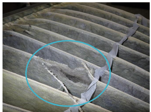
Kuva 50 Tarkastuksessa havaittiin, että tuloilmasuodatin on repeytynyt.
