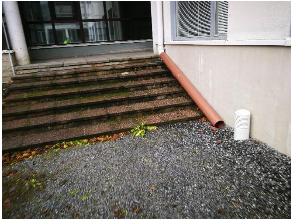
Kuva 25 Toimistohuoneen 110 vastaisella ulkoseinällä kattovedet on johdettu syöksytorven avulla lattiapinnan tason alapuolelle.
