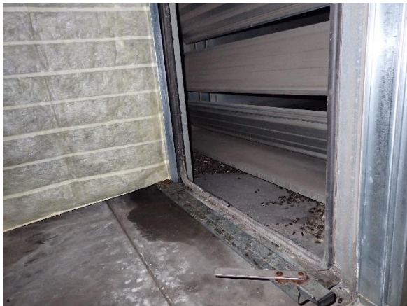
Kuva 47 Ulkoilmapelti ei sulkeudu koneen sammuesssa.
