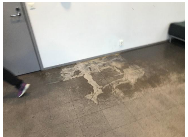
Kuva 35 Lattiapinnoitteessa kosteusjälkiä lasisiipirakennuksen aulatilassa.
