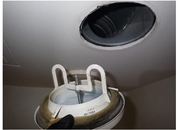
Kuva 58 Poistoilman päätelaitteet ovat KSO -kartioventtiileitä. päätelaitteet olivat tarkastettaessa varsin puhtaita.
