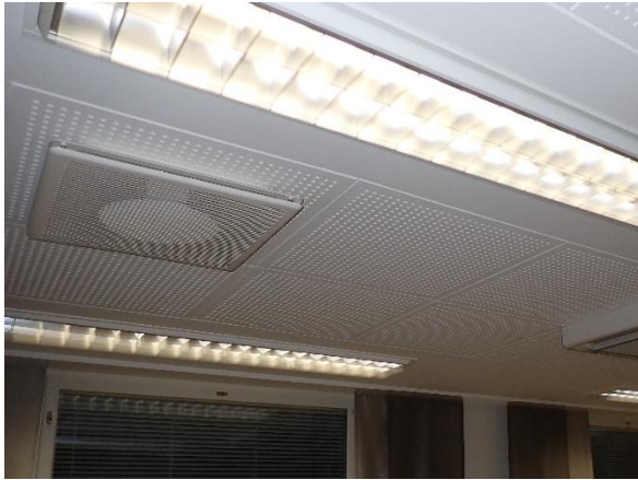
Kuva 57 Tuloilman päätelaitteina on TKB -kattohajottajat.
