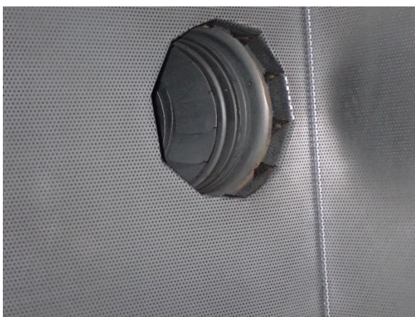
Kuva 49 Tuloilmakammiossa havaittiin suojaamatonta mineraalivillaa.
