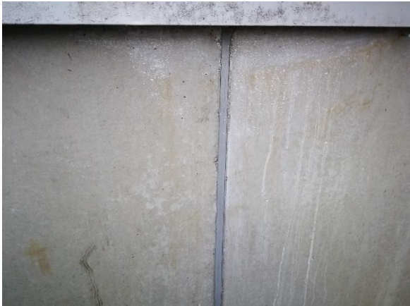
Kuva 29 Julkisivun elementtisaumat on uusittu ja ne ovat yleisesti hyväkuntoiset.
