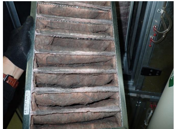
Kuva 52 F7-luokan tuloilman pussisuodatin on hyväkuntoinen.
