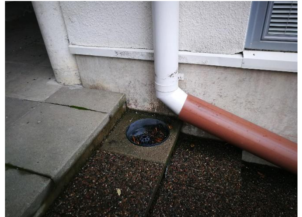
Kuva 26 Syöksytorvesta tulevat kattovedet ovat aiemmin aiheuttaneet kosteusrasitusta toimistotilan 110 ulkoseinän alaosiin.
