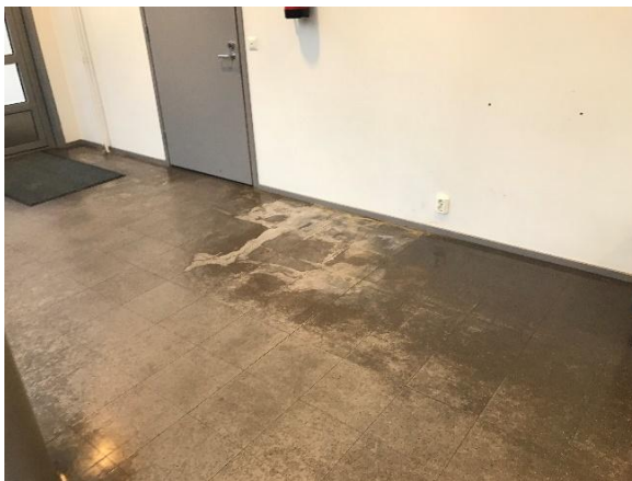
Kuva 34 Lattiapinnoitteessa kosteusjälkiä lasisiipirakennuksen aulatilassa.
