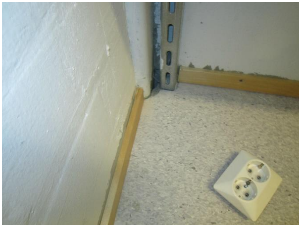
Kuva 16: Sähköpääkeskuksessa tiivistämätön pilarinjuuri.
