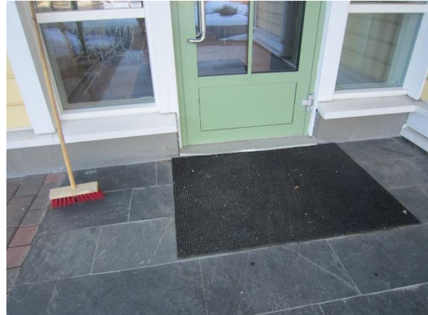
Kuva 3: Kosteusjälkiä rapatun sokkelin alareunassa.
