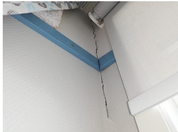
Kuva 26: Ulkoseinän ja väliseinän halkeama tilassa 155.
