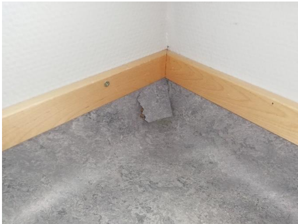
Kuva 10. Linoleumimatoissa havaittiin vaurioita, jotka ainakin osin johtuvat rakenteiden liikkumisesta. Mattojen vaurioituminenkin puoltaa niiden uusimista.
