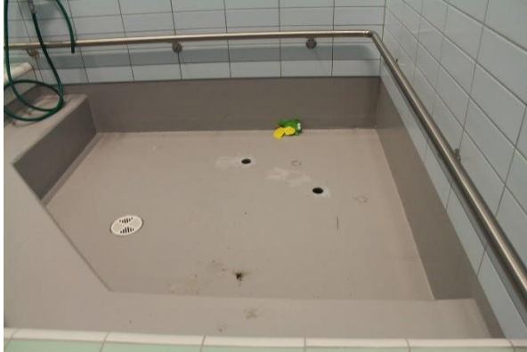
Kuva 12. Vasemmanpuoleinen (ylempi) porareikä on tehty epoksin halkeaman kohdalle. Halkeama on syntynyt harkkojen sauman kohtaan.
