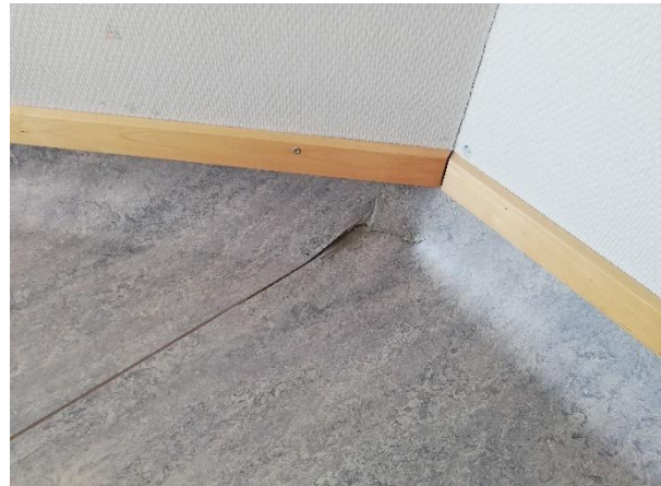
Kuva 11. Linoleumimatoissa havaittiin vaurioita. Mattojen vaurioituminenkin puoltaa niiden uusimista.
