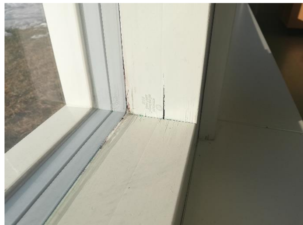
Kuva 5. Kiinteän ikkunan ikkunakarmissa näkyvää kosteuden aiheuttamaa vauriota
