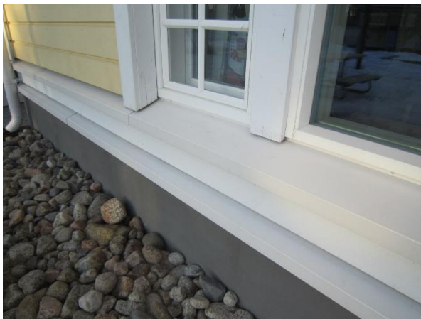
Kuva 4. Ikkunoiden vesipellitykset ovat hyväkuntoiset ja niiden kallistus on riittävä.
