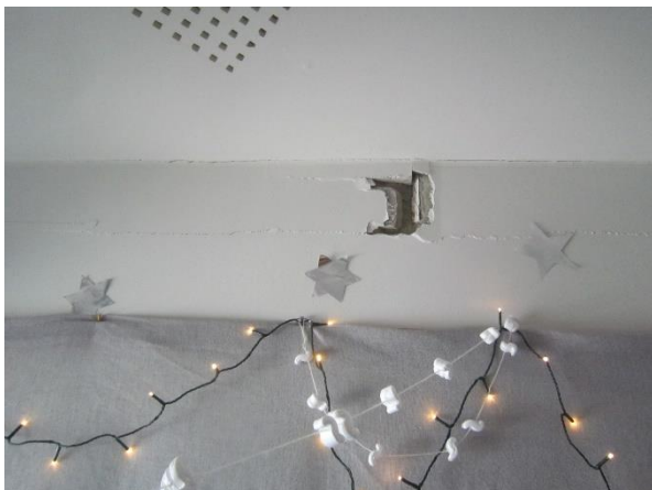
Kuva 27: Alaslasketun katon rakenne on rikkonut tilan 136 seinää.
