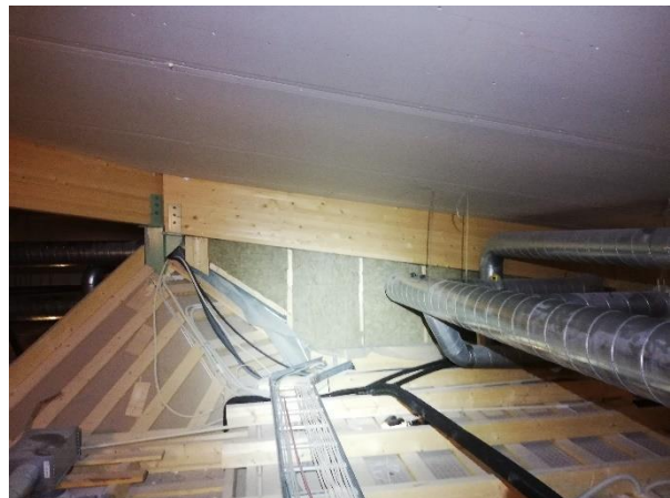
Kuva 18. Paljasta villapintaa ullakkotilassa.
