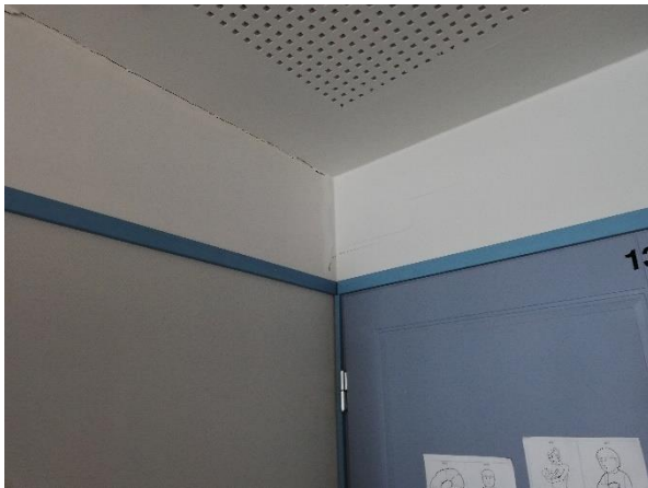
Kuva 25: Halkeilua väestönsuojan ja alakattolevytyksen rajapinnassa. Oven yläpuolella näkyvissä muurauksen halkeilua.
