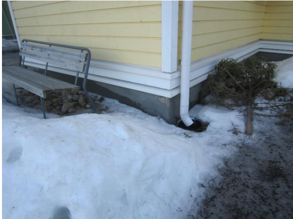
Kuva 2: Vähäisiä vauriojälkiä sokkelissa.
