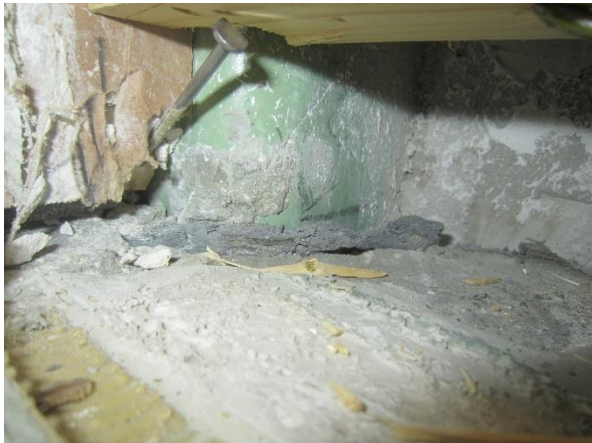
Kuva 14: Lattian ja pilarien liitoskohdat epätiivitä. Solumuovi on ryttääntynyt valun aikana eikä ole tiiviisti teräspilaria vasten.
