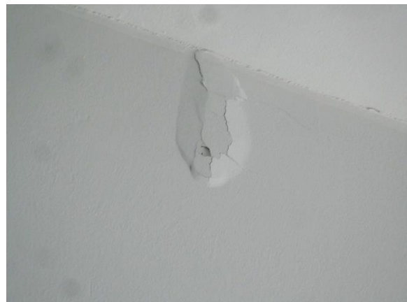
Kuva 28: Alaslasketun katon rakenne on rikkonut tilan 123 seinää.
