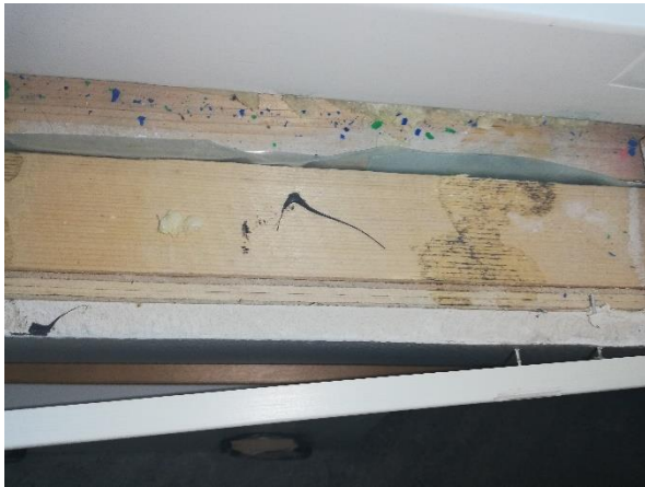
Kuva 8. Ikkuna- ja seinärakenteen liitos ikkunan alaosassa.
