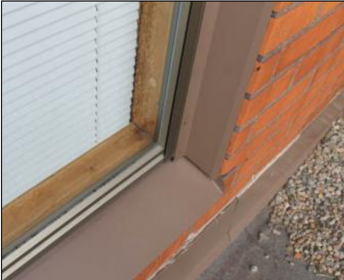
RAK-kuva 37. Luokka- ja toimistohuonetilan ikkuna ulkopuolelta kuvattuna. Ikkunan uloin puite on alumiiniprofiilirakenteinen. Karmit ovat puuta ja sisäpuitteessa on lämpölasielementti.
