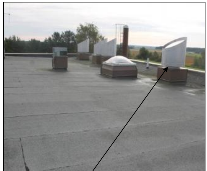
RAK-kuva Kouluosan ilmanvaihtokojehuoneen kohdalla oleva vesikatto. 52. Kauluspellin välistä pääsee valumaan vettä iv kojehuoneeseen poistokojeen päälle
