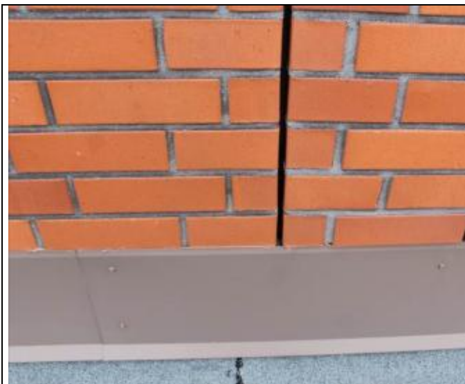
RAK-kuva 31. Julkisivun avoimia liikuntasauvoja
