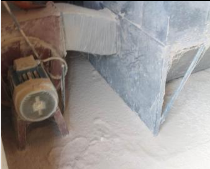
RAK-kuva 85. Purunpoistotila. Purunpoistopussi on pudonnut pois paikoiltaan. Puru on levinnyt tilaan. Tila palovaarallinen
