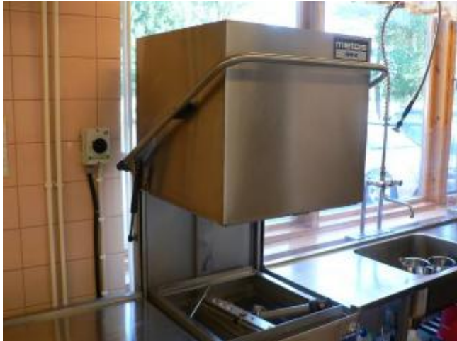
S-kuva 9. Yleiskuva keittiölaitteista.
