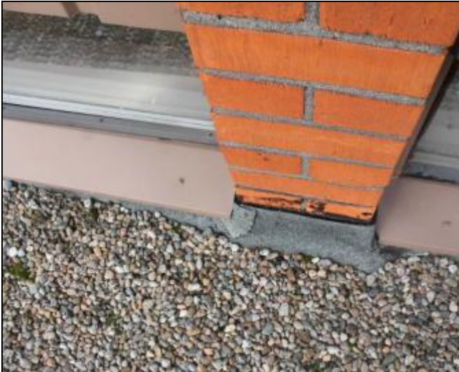
RAK-kuva 57. Kirjasto-osan vesikaton ylösnoston osalla ei ole vesipellitystä. Kerminosto on osin avoin
