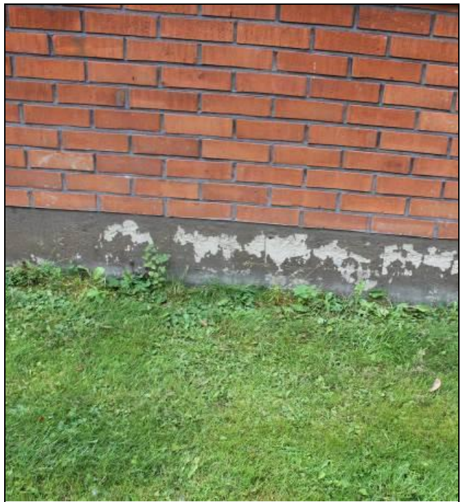
RAK-kuva Sokkelin maalauspinnaat hilseilevät
