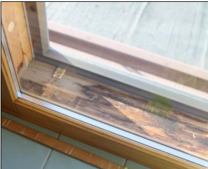
RAK-kuva 35. Luokka- ja toimistohuonetilan ikkuna. Ikkunan uloin puite on alumiiniprofiilirakenteinen. Karmit ovat puuta ja sisäpuitteessa on lämpölasielementti. Ikkunan alakarmi on vaurioitunut kosteuden vaikutuksesta.
