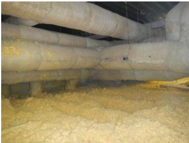
LVI-kuva 19. Yleiskuva kanavaeristeistä ja kanava-asennuksista.
