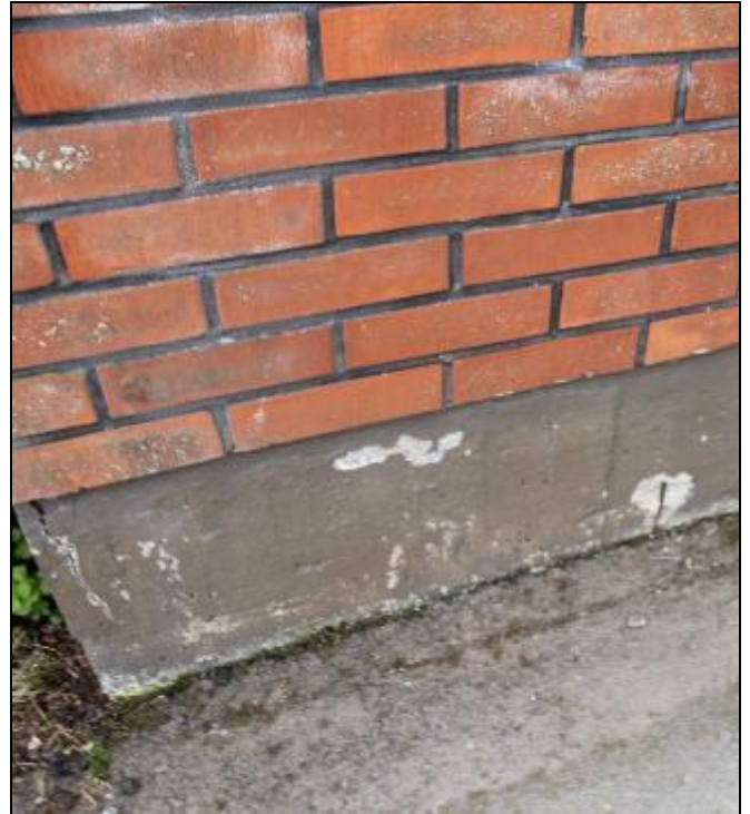
RAK-kuva Sokkeleissa yksittäisiä teräskorroosiovauriopisteitä.
