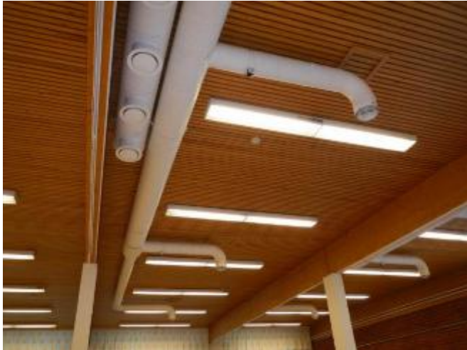
LVI-kuva 21. Yleiskuva pääte-elimistä.
