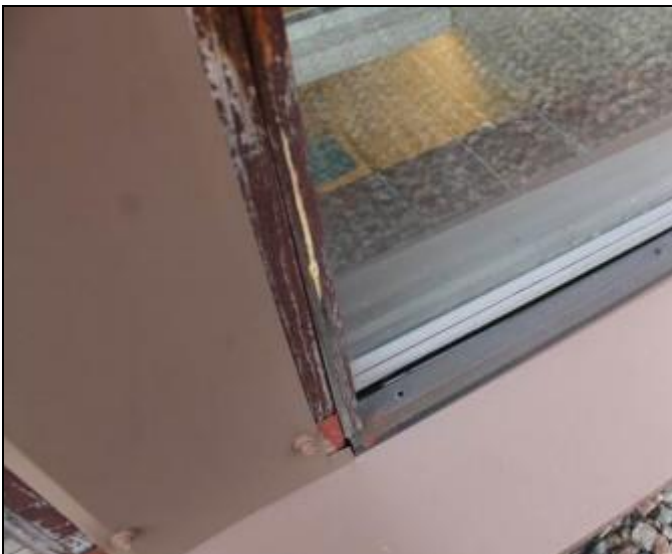
RAK-kuva 39. Kirjasto-osalla rakennuksen yläosan pienet alkuperäiset ikkunat ovat kiinteitä lämpölasielementein varustettuja ikkunoita. Puuosat ja liittymät ovat vain välttävässä kunnossa. Vesipeltiliittymistä sadevesillä on mahdollisuus tunkeutua rakenteisiin.
