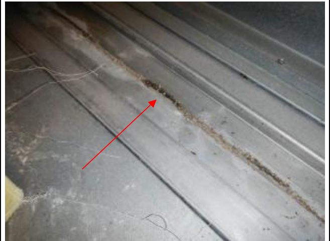
LVI-kuva 18. Koneissa on epäpuhtauksia.
