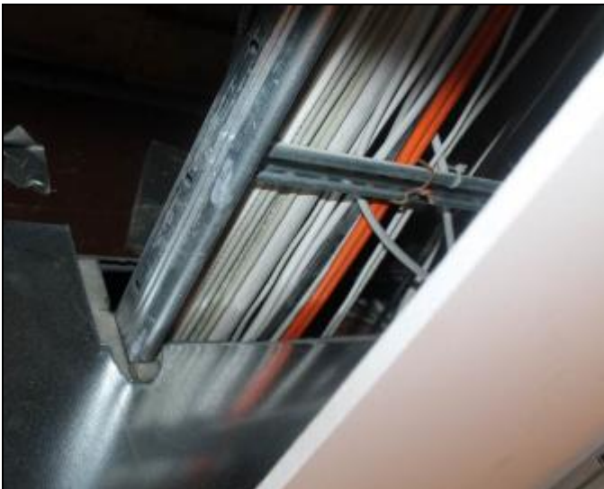
RAK-kuva 87. Avoimia, kaapelihyllyjen läpivientejä alakaton päällä palo-osatosta toiseen. Palokatko puutteellinen.
