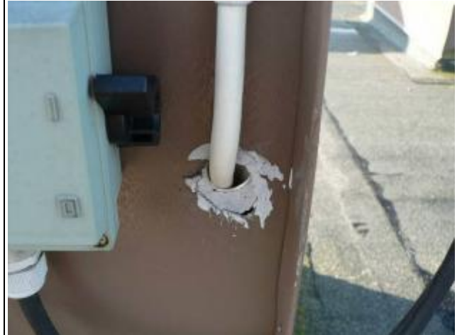
S-kuva 10. Katolla sijaitsevista kaapeliläpiviennistä pääsee valumaan vettä rakenteisiin.
