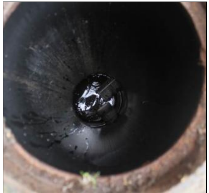
RAK-kuva 8. Edelläoleva salaojan tarkastuskaivo ja kaivon johdetut salaojaputket
