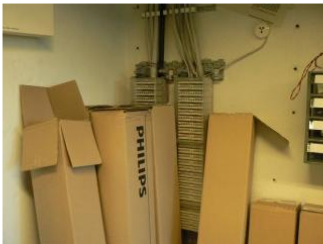
S-kuva 3. Pääkeskushuoneessa on ylimääräisiä tavaroita.
