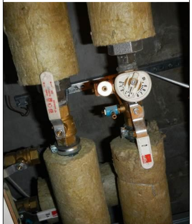
LVI-kuva 4. Yleiskuva linjaventtiileistä.
