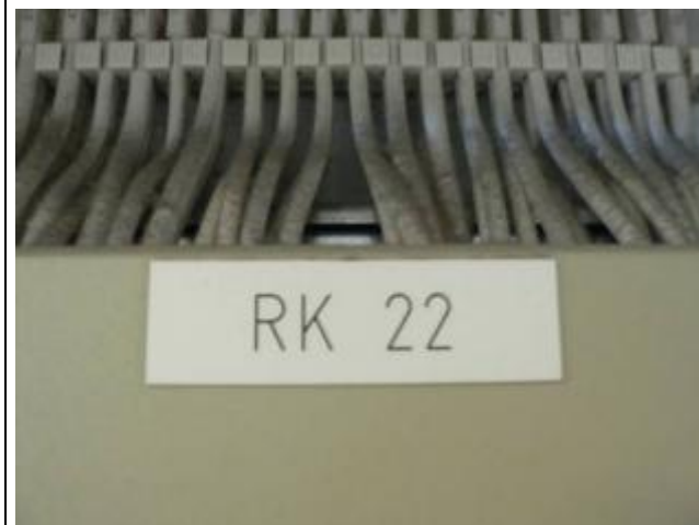
S-kuva 8. Keskukset ja keskustilat ovat pölyisiä.
