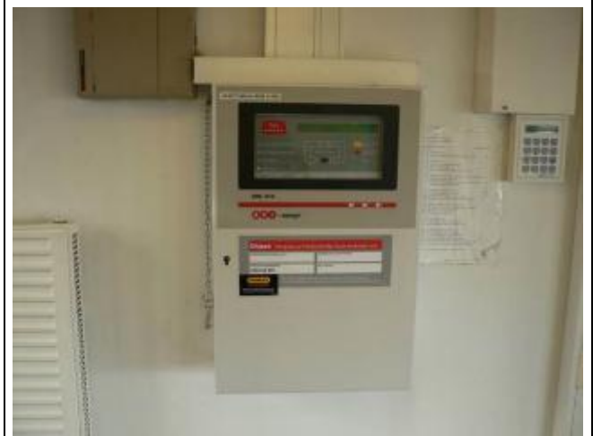
S-kuva 28. Yleiskuva paloilmoitinkeskukselta.
