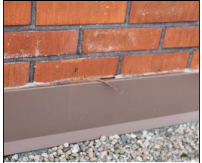
RAK-kuva 58. Vesikaton ylösnostopellityksen yläreunasta tiivistemassaus irtoaa.
