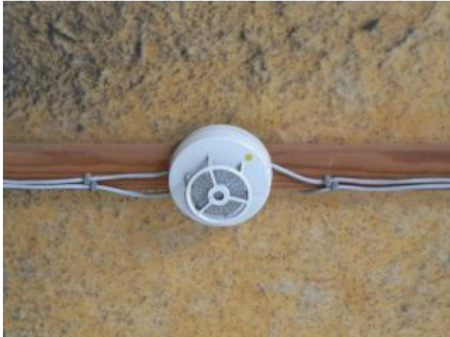
S-kuva 29. Yleiskuva paloilmamaisimesta.
