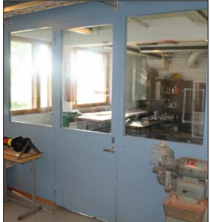
RAK-kuva Osastoiva metallirakenteinen väliovi 62.
