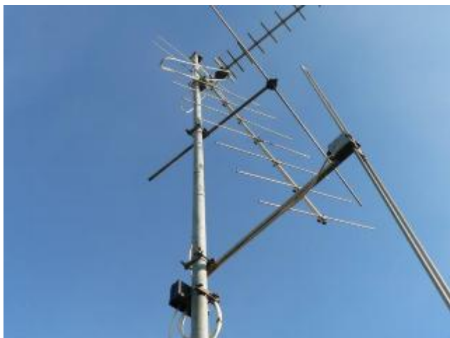
S-kuva 23. Antennimastosta on irronnut yksi antenni.
