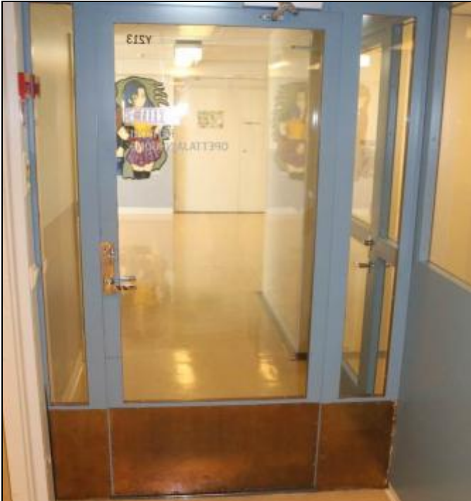
RAK-kuva Osastoiva metallirakenteinen väliovi 61.
