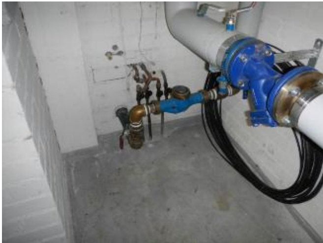
LVI-kuva 7. Yleiskuva päävesimittarista ja pääsuluista.
