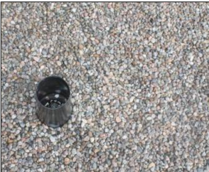
RAK-kuva Vesikatteen tuuletusputken päästä puuttuu sadesuojahattu
