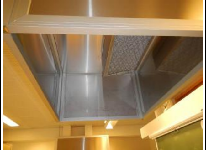
LVI-kuva 22. Yleiskuva kotitalousluokan huuvista.
