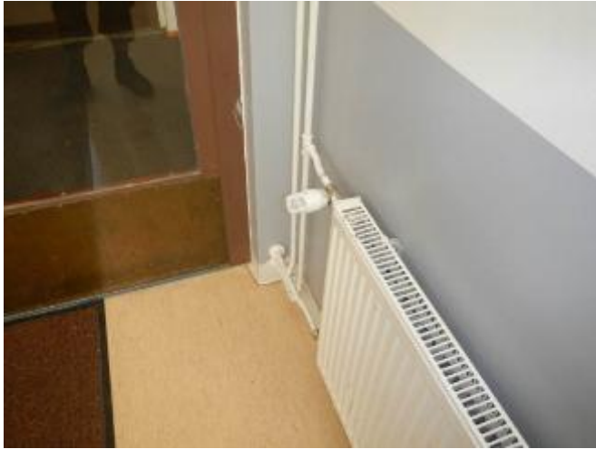
LVI-kuva 5. Yleiskuva patteriventtiileistä.
