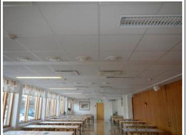
LVI-kuva 20. Yleiskuva pääte-elimistä.
