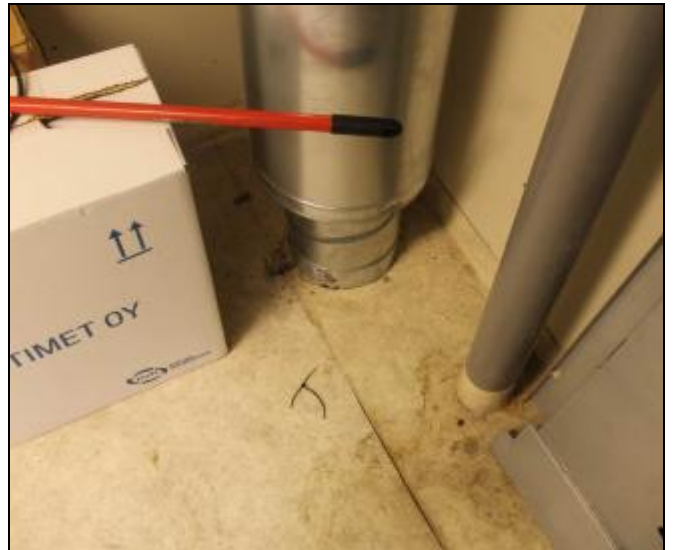
RAK-kuva 84. Kirjasto-osan iv kojehuone. Lattian vesieristämätön sauma on rikkonainen. Pintakosteudentunnistimella rikkoumapaikan ympäristö on pintakosteaa
