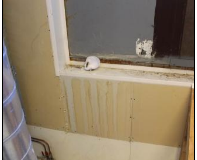
RAK-kuva 82. Kouluosan iv kojehuoneen uloskäynti vesikatolle. Oven alla kosteudesta aiheutuneita seinälevytysten vaurioita.
