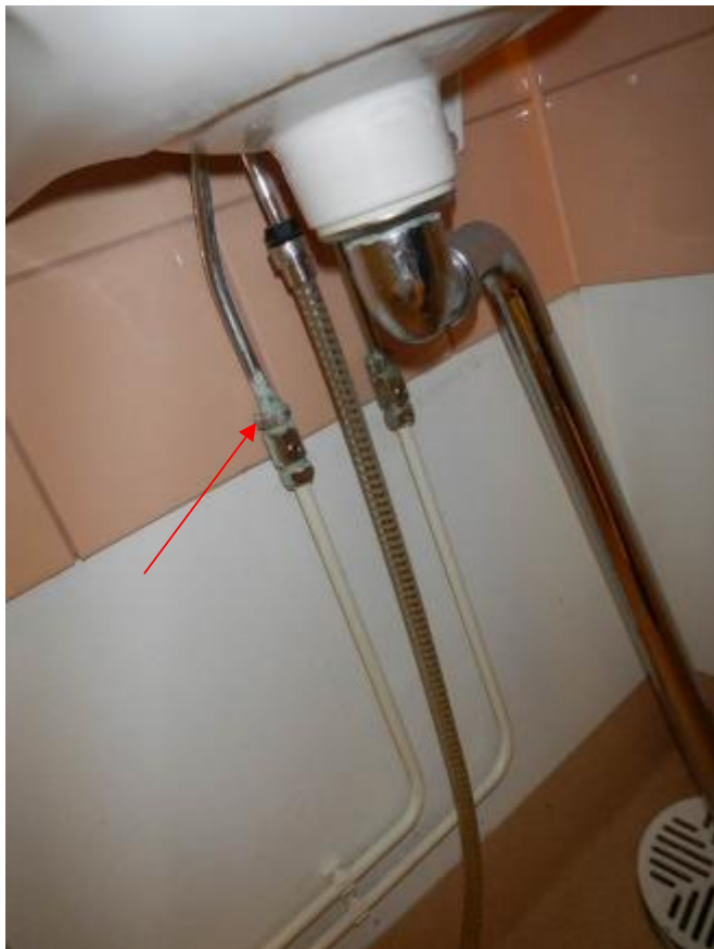
LVI-kuva 13. Kalustesuluissa on yleisesti hapettumaa.
