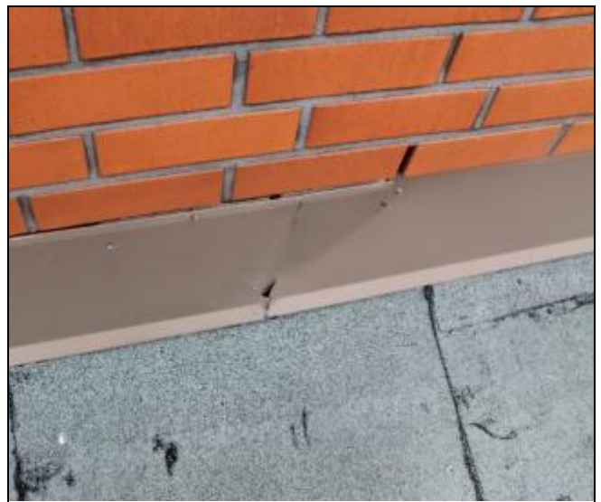
RAK-kuva 32. Vesikattoon ja julkisivuun liittyvän pellityksen irtoamista
