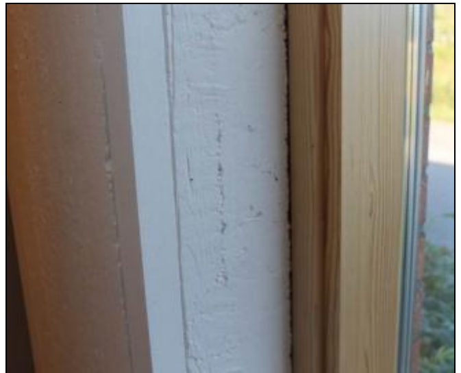
RAK-kuva 88. Ikkunaliittymä avoin seinän eristetilaan.
