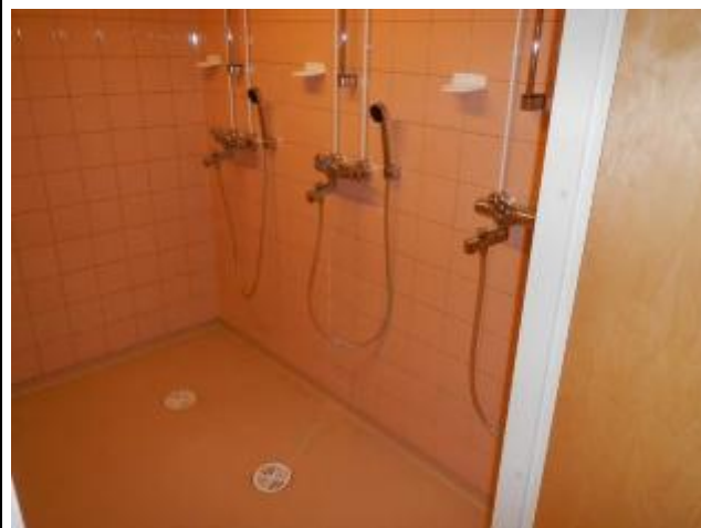
LVI-kuva 12. Yleiskuva vesi- ja viemärikalusteista.
