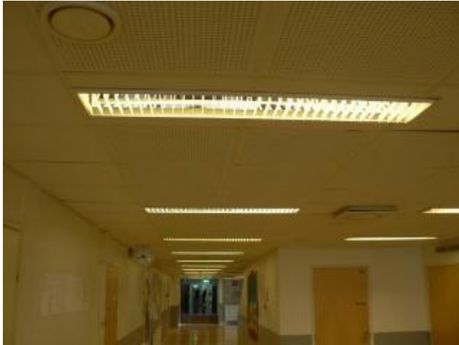
S-kuva 17. Yleiskuva käytävän valaisimista.
