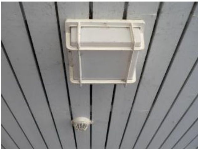
S-kuva 19. Yleiskuva katokseen asennetusta valaisimesta.
