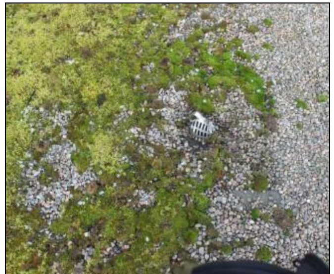
RAK-kuva Kattovesikaivon sihti on mekaani- 56. sestä vaurioitunut.
