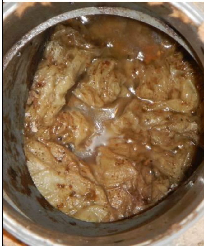
LVI-kuva 10. Pohjaviemäreissä on toimintapuutteita.
