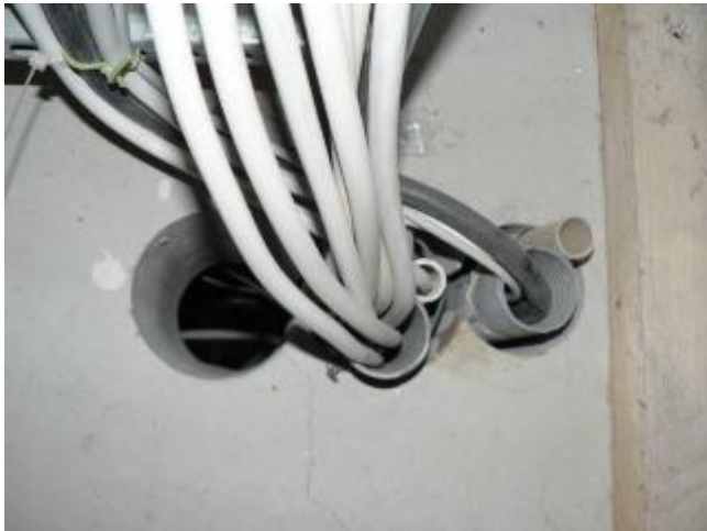
S-kuva 1. Rakennuksessa on huonosti tehtyjä tai puuttuvia palokatkoja.
