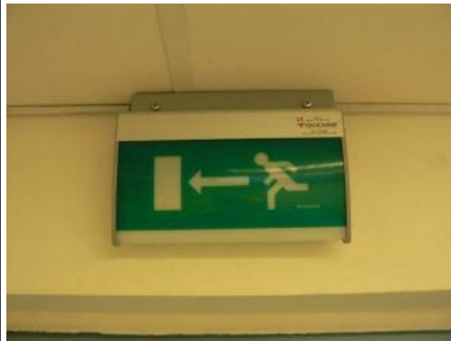
S-kuva 22. Rakennuksessa on useita pimeitä merkkivalaisimia.
