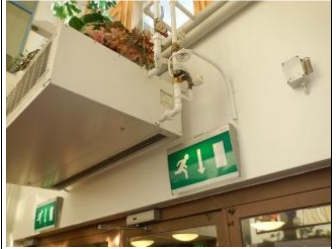
LVI-kuva 6. Yleiskuva tuulikaappikojeista.
