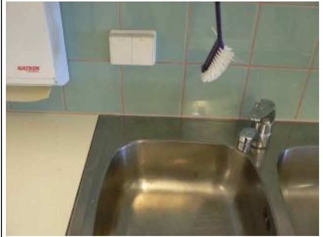
S-kuva 14. Opetuskeittiön pesualtaan kohdalla sijaitseva pistorasia on suositeltavaa siirtää altaan sivulle.
