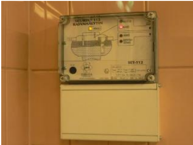
S-kuva 13. Rasvaerotuskaivon hälytyskeskuk- sessa palaa padotuksen häiriövalo.
