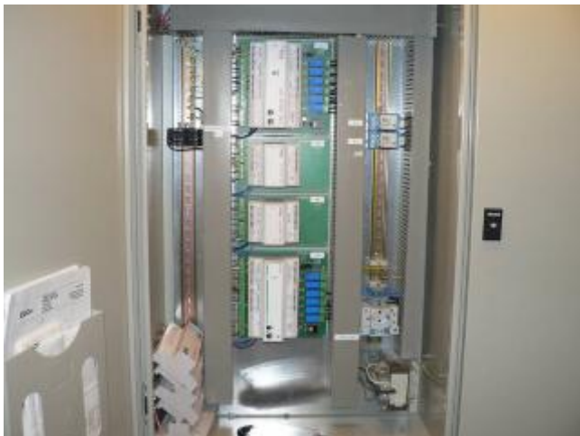
S-kuva 31. Yleiskuva rakennusautomaatiojärjestelmän alakeskuksesta.
