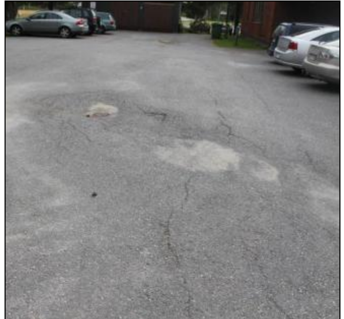
RAK-kuva 10. Pohjoispuolen piha-alueen sadevesikaivojen läheisyyksissä esiintyy jonkin verran routimisesta aiheutuvia asfalttivaurioita.
