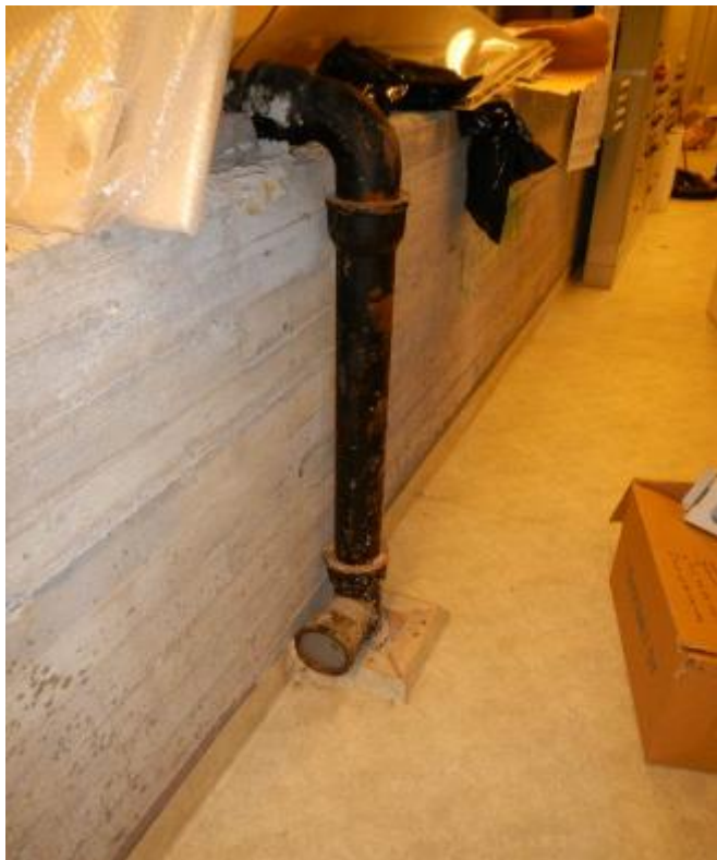
LVI-kuva 9. Viemärit ovat osittain valurautaa.
