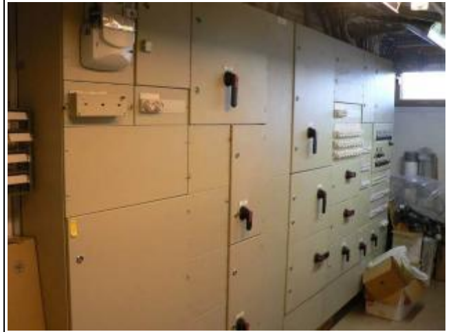
S-kuva 2. Yleiskuva pääkeskuksesta.
