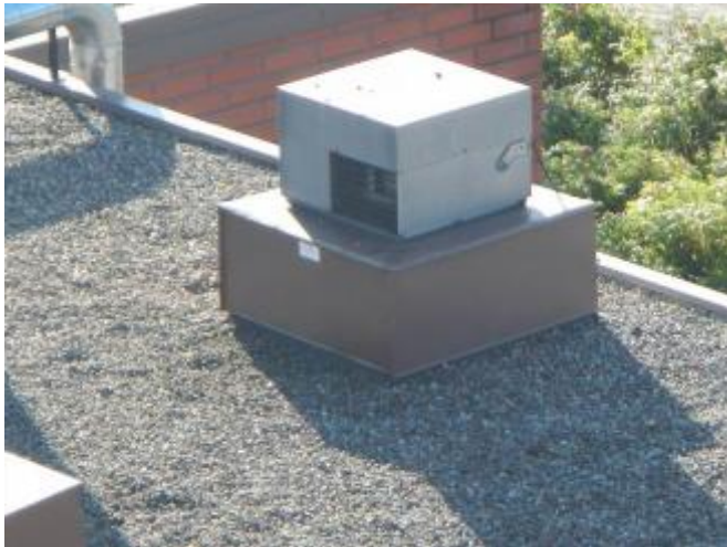
LVI-kuva 17. Yleiskuva huippuimureista.
