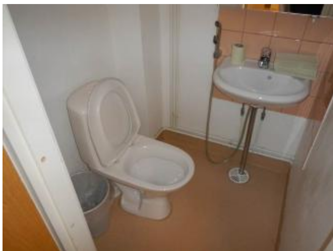
LVI-kuva 11. Yleiskuva vesi- ja viemärikalusteista.
