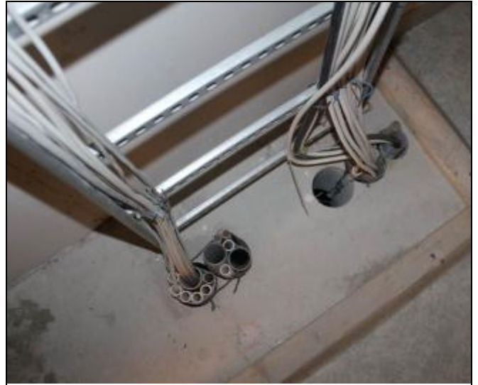
RAK-kuva 86. Avoimia, massaamattomia läpivientejä. Palokatko puutteellinen.
