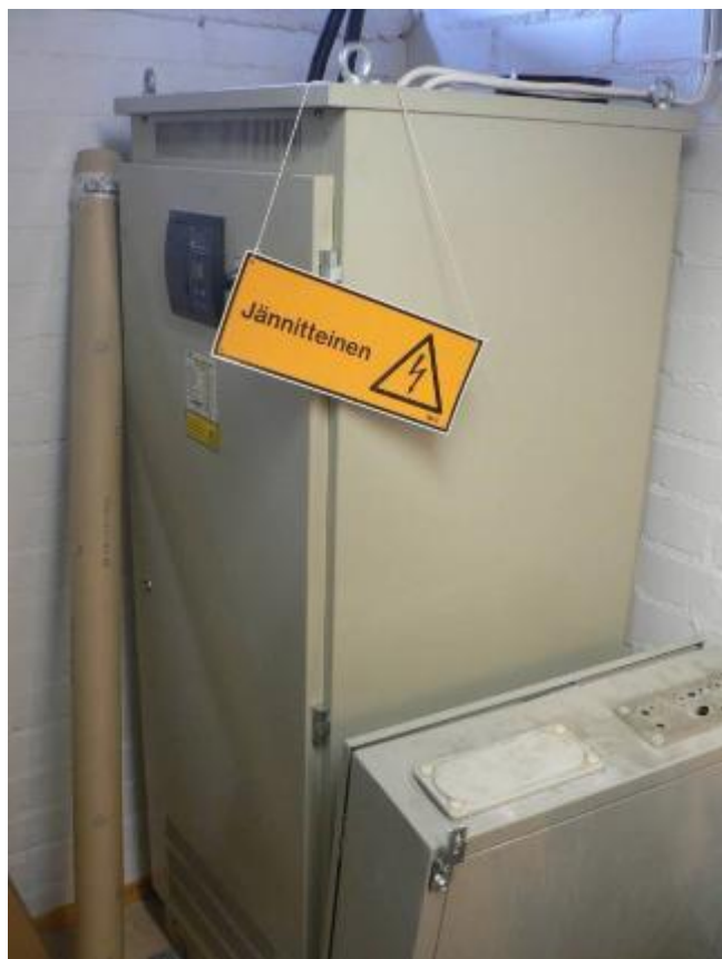
S-kuva 5. Yleiskuva kompensointiparistosta.
