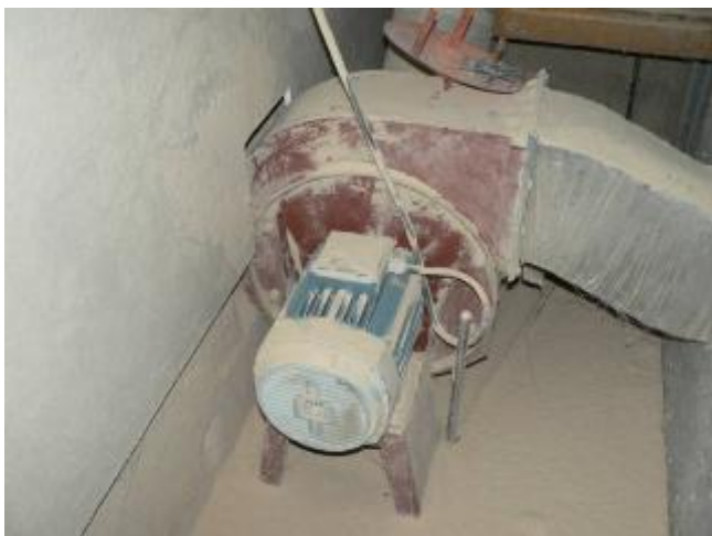
S-kuva 11. Purunpoistotilassa sijaitseville sähkölaitteiden pinnoille kertyy pölyä liian paljon.
