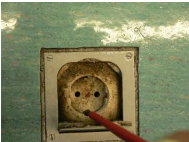
S-kuva 15. Lattiaan asennetut pistorasiat ovat likaisia.
