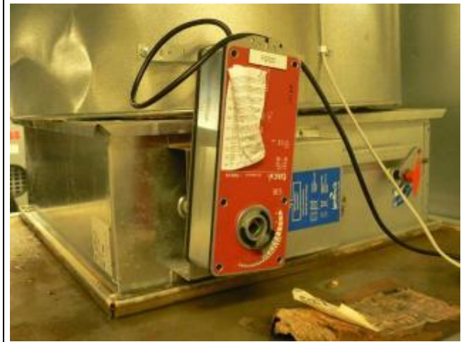
S-kuva 32. Yleiskuva peltimoottorista.
