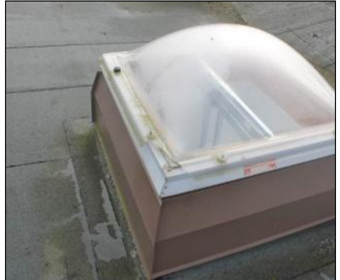
RAK-kuva Kattoikkunakupu reuna-alueelta rikkonainen
