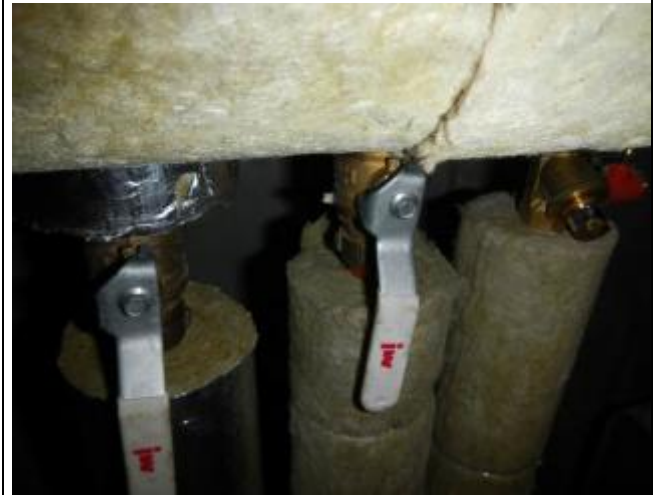
LVI-kuva 8. Yleiskuva käyttövesiverkoston linja-venttiileistä.
