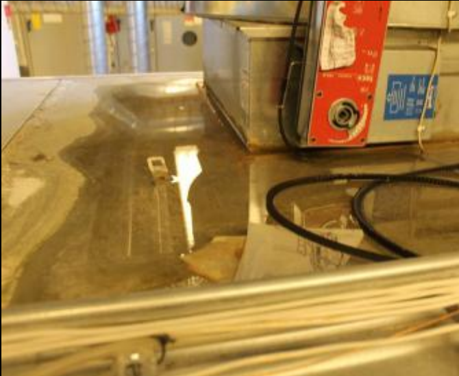
RAK-kuva 81. Kouluosan iv kojehuone, poistoilmakojeen päällystä. Kojeen päälle valuu vettä, vrt syy valokuva nro 52
