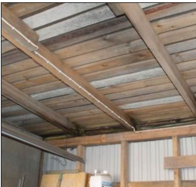
RAK-kuva 19. Varastokatoksen osalla katteen alustalaudoissa vesikatevuodosta aiheutuvia kosteusmerkkejä.
