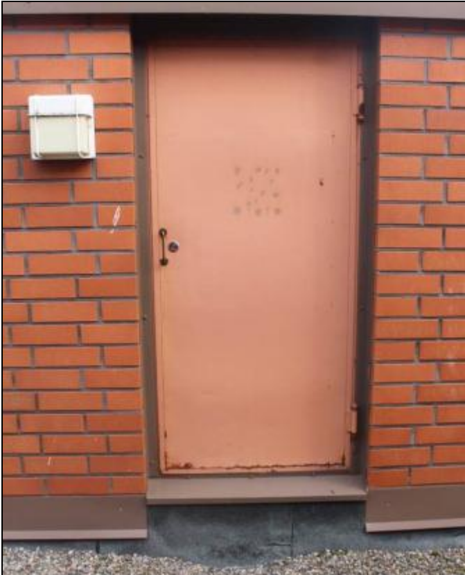
RAK-kuva 45. Kirjasto-osan ilmanvaihtokojehuoneen metallirakenteinen umpiovi.
