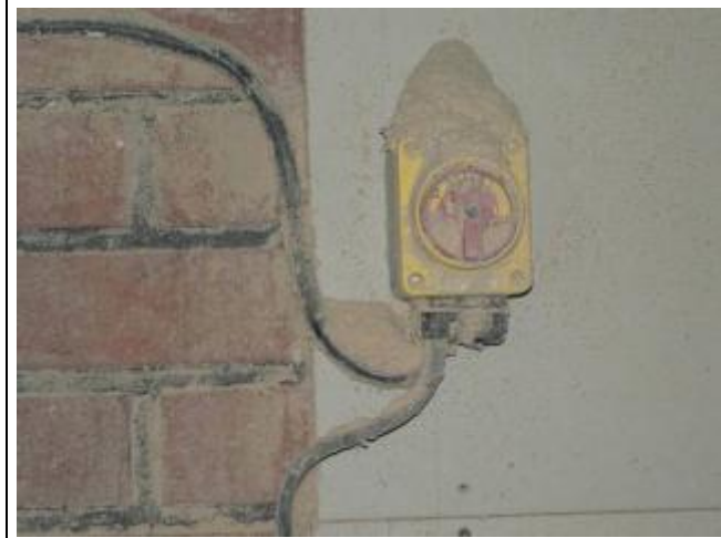
S-kuva 12. Purunpoistotilassa sijaitseville sähkölaitteiden pinnoille kertyy pölyä liian paljon.
