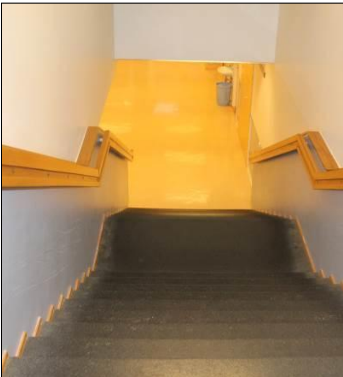
RAK-kuva Tilaportaat 1.- ja 2.kerroksen välillä. 63.
