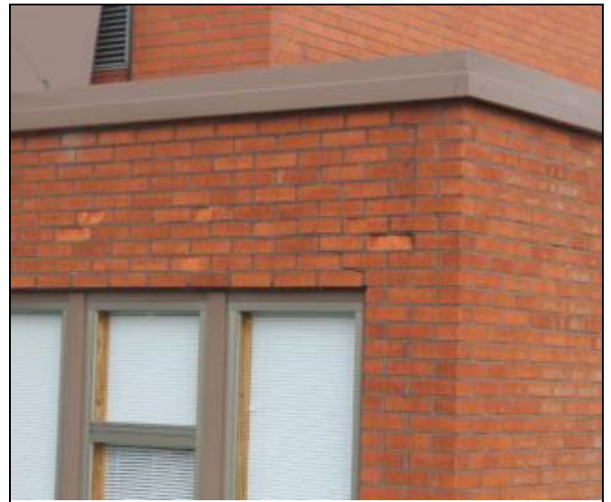
RAK-kuva 28. Yleiskuva tiilijulkisivuista rakennuksen eteläpuolen alueella. Eteläpuoleisella alueella jonkinverran tiilien rapautumista / pintaosien lohkeamista
