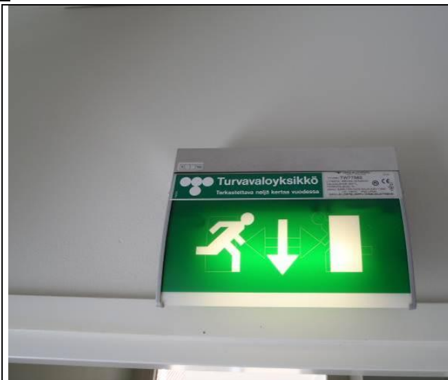
S-kuva 14. Yleiskuva poistumistievalaisimesta.
