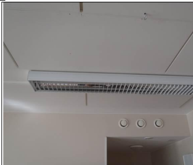
S-kuva 10. Yleiskuva leikkihuoneen valaisimista.
