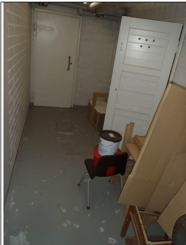
RAK-kuva Kellari käytävän lattian kosteusvaurioalueita 27
