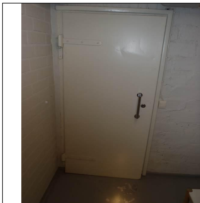
RAK-kuva 20 Kolhiintunut teräspalo-ovi
