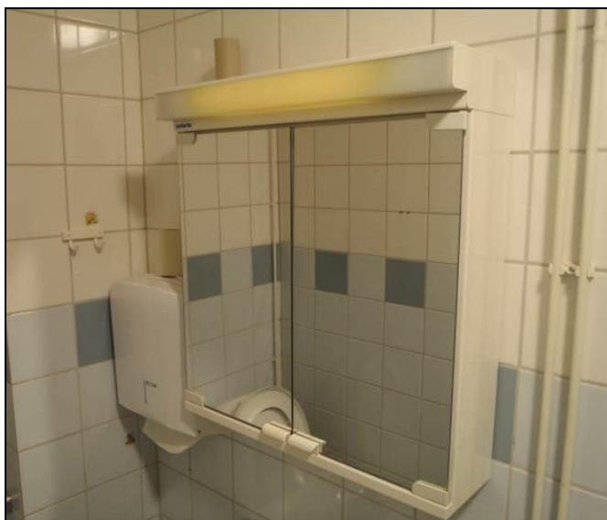
S-kuva 11. Yleiskuva wc:n valaisinpeilikaapista.
