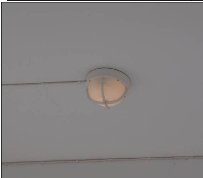
S-kuva 1. Yleiskuva sisäänkäynnin valaisimesta.
