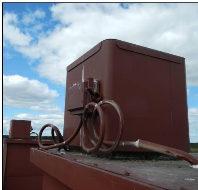
LVI- kuva 10. Yleiskuva huippuimureista.
