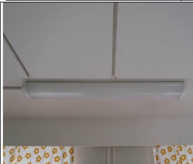
S-kuva 9. Yleiskuva keittiön valaisimista.
