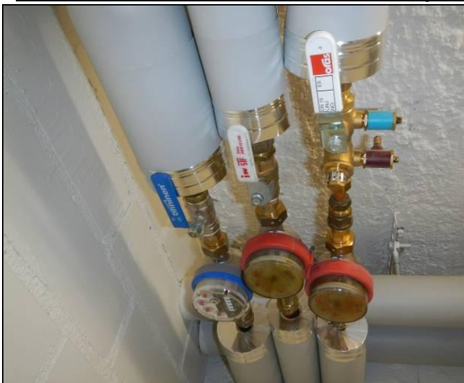
LVI- kuva 3. Yleiskuva käyttöveden alamittareista.
