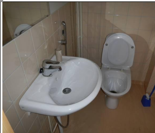
LVI- kuva 8. Yleiskuva vesi- ja viemärikalusteista.
