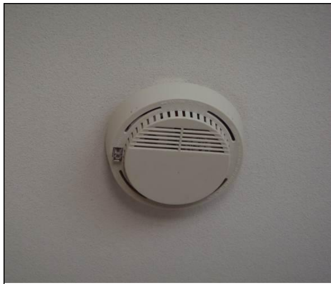
S-kuva 16. Yleiskuva palovaroittimesta.
