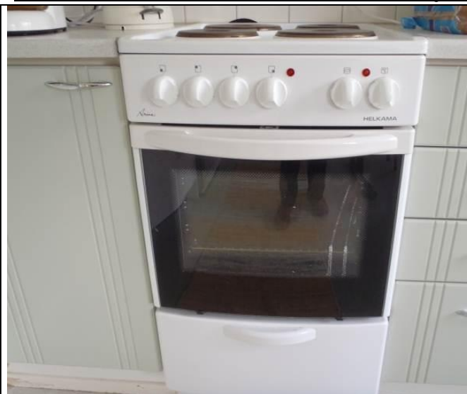
S-kuva 13. Yleiskuva keittiön kodinkoneista.
