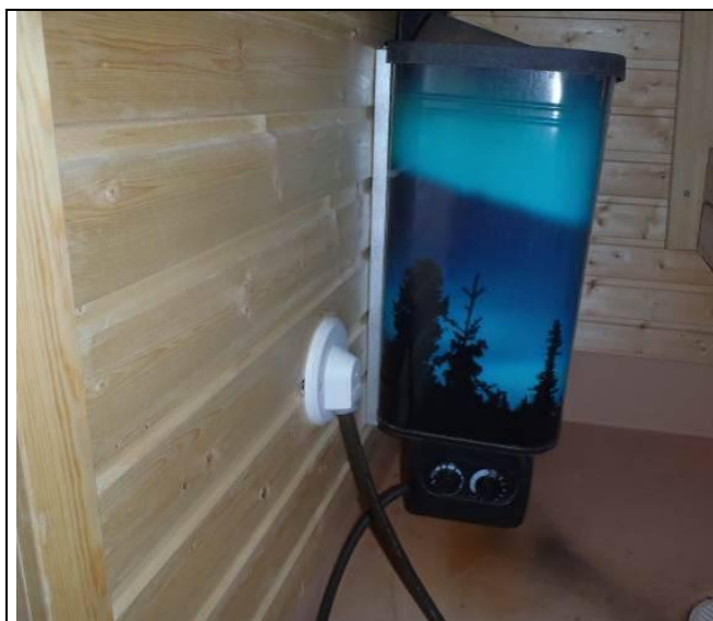
S-kuva 12. Yleiskuva kiukaasta.
