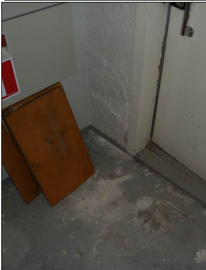
RAK-kuva Käytävää vasten olevan seinän ala- 29 osan kosteusvaurioalueita
