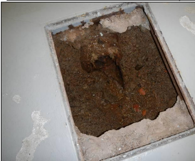
LVI- kuva 7. Vanhojen viemäreiden luukut eivät ole tiiviitä.
