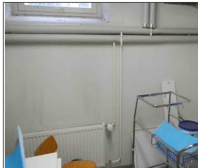
LVI- kuva 2. Yleiskuva patteriventtiileistä.
