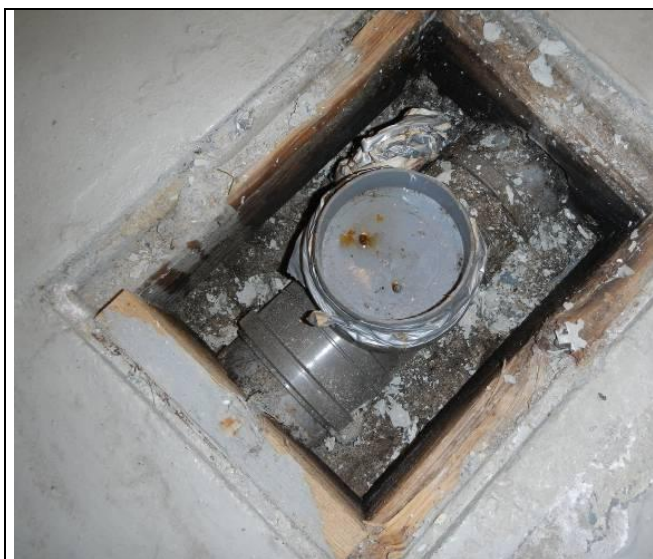
LVI- kuva 6. Pohjaviemäriin puhdistusluukku ei ole tiivis.
