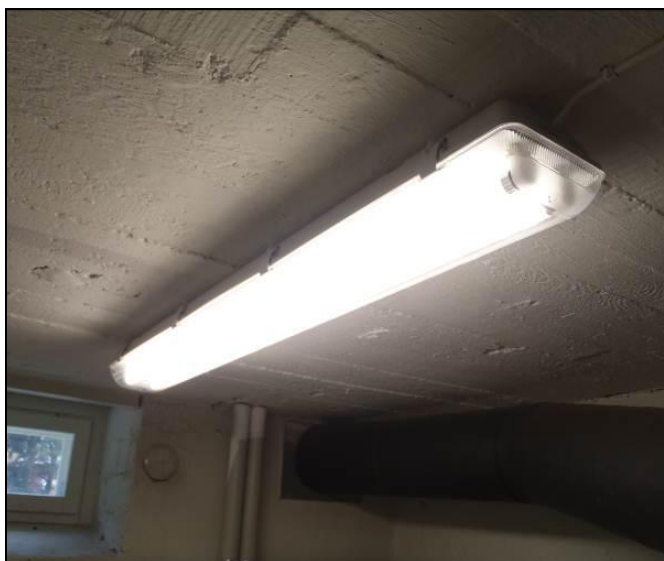
S-kuva 7. Yleiskuva kellarikerroksen valaisimista.
