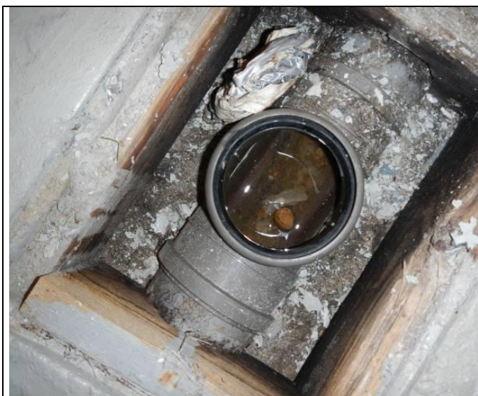
LVI- kuva 5. Pohjaviemärissä on vettä pohjalla.
