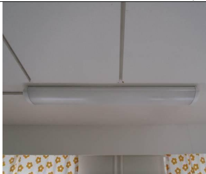
S-kuva 9. Yleiskuva keittiön valaisimista.
