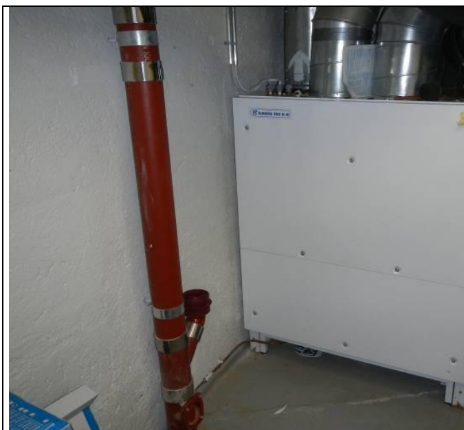
LVI- kuva 9. Yleiskuva tulo-poistokoneesta.
