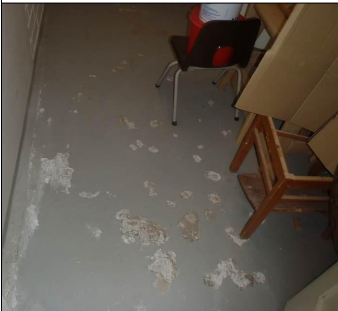
RAK-kuva 7 Alapohjan kosteusvaurioita
