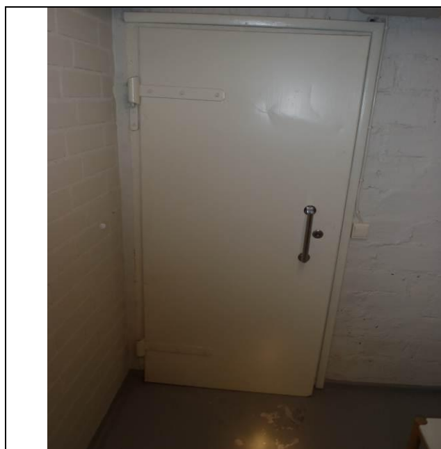
RAK-kuva 20 Kolhiintunut teräspalo-ovi
