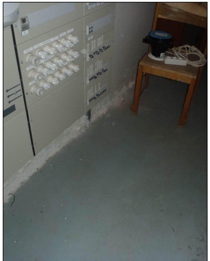
RAK-kuva Sähköpääkeskuksen seinän alaosan kosteusvaurioalueita 28
