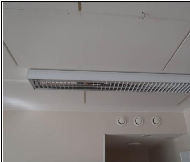
S-kuva 10. Yleiskuva leikkihuoneen valaisimista.
