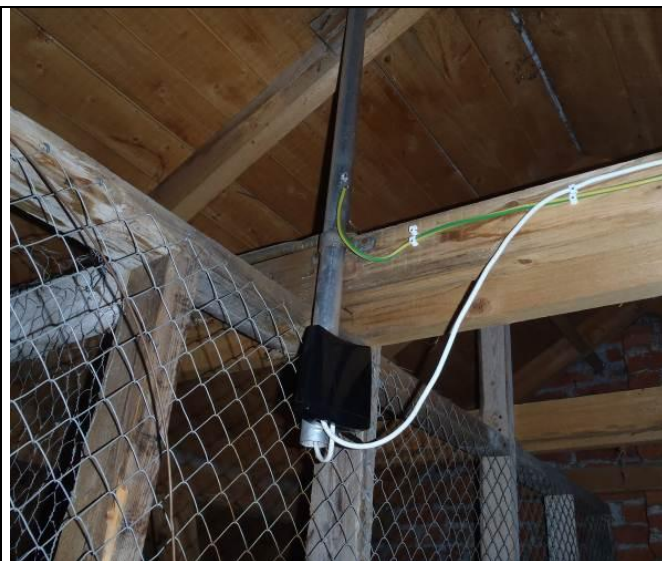
S-kuva 15. Antennimaston tukiputken kiinnitys ja tiivistys on tarkastettava.
