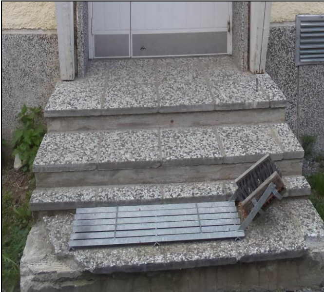
RAK-kuva 5 Portaan pintaosien lohkeamia
