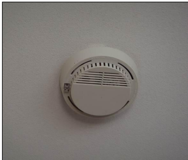
S-kuva 16. Yleiskuva palovaroittimesta.
