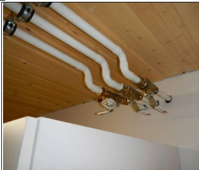
LVI- kuva 4. Yleiskuva käyttöveden linjaventtiileistä.
