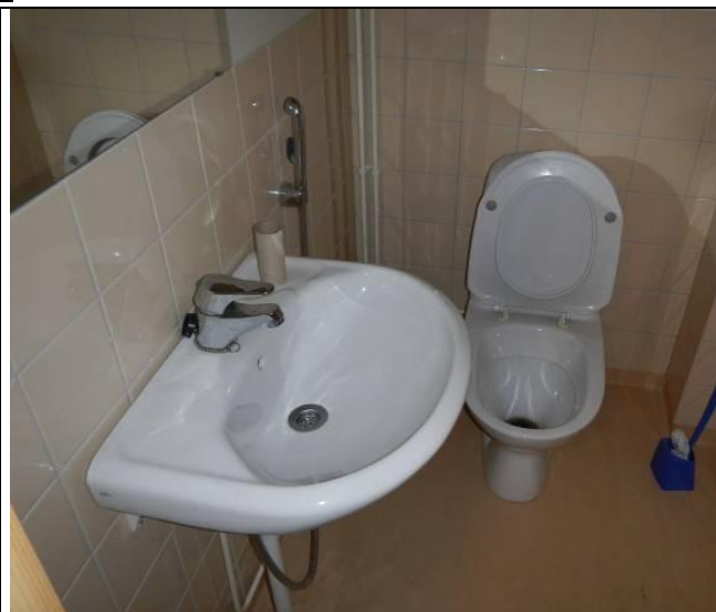
LVI- kuva 8. Yleiskuva vesi- ja viemärikalusteista.
