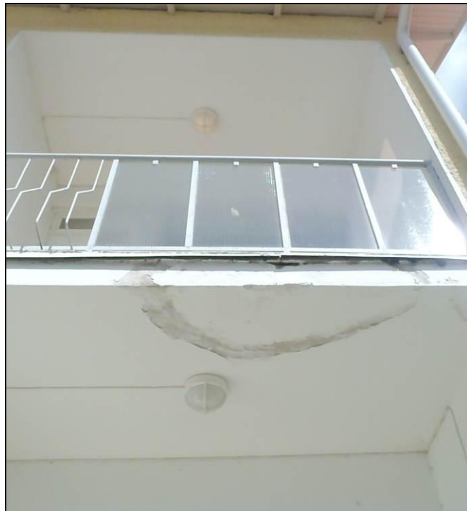
RAK-kuva 14 Parvekkeen alapinnan ja etureunan kosteusvauriojäljet
