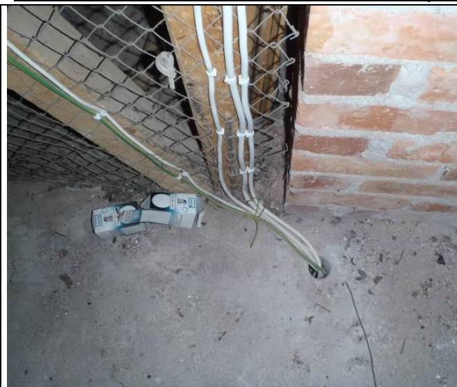
S-kuva 5. Kaapeliläpiviennit on tiivistettävä ja kaapelit suojattava.
