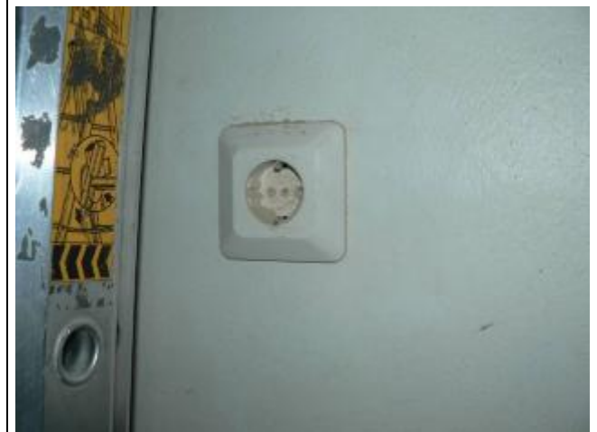
S-kuva 8. Purunpoistotilan pistorasian kotelointiluokka on riittämätön.
