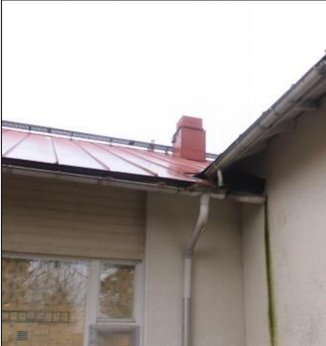
RAK-kuva 39. Kattovesikourut täynnä havuja laajennusosan alueella
