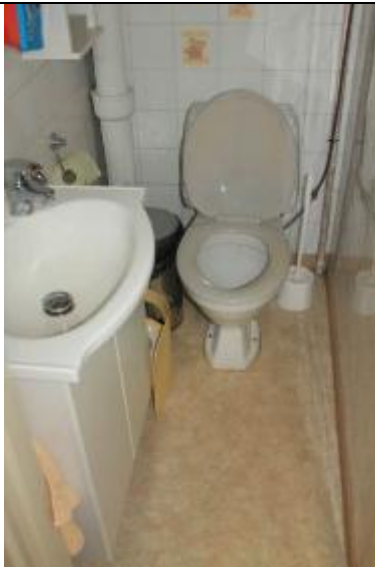
RAK-kuva 49. Päiväkotiosan wc, tilapinnat välttävässä kunnossa
