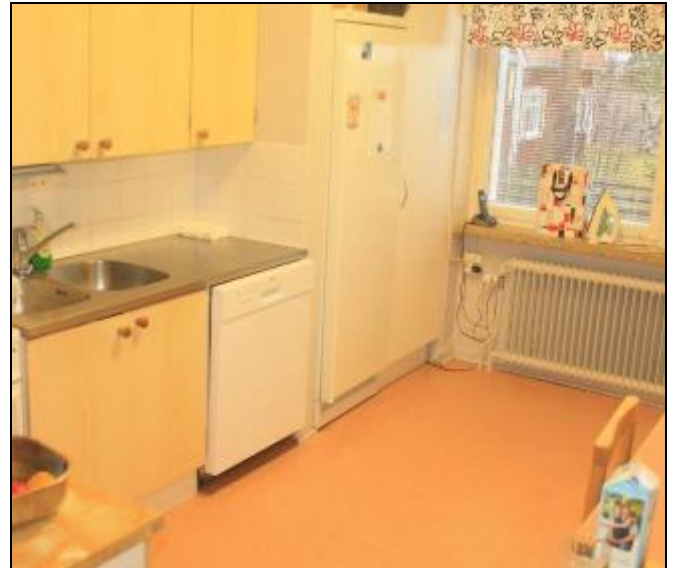
RAK-kuva 50. Päiväkotiosan keittiö, mattopinnoite kupruilee, ei kosteutta
