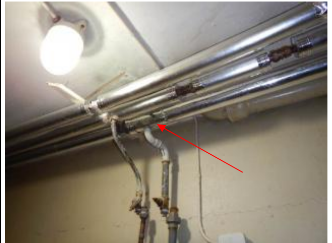
LVI-kuva 10. Vesijohtoasennukset ovat osittain määräysten vastaisia.
