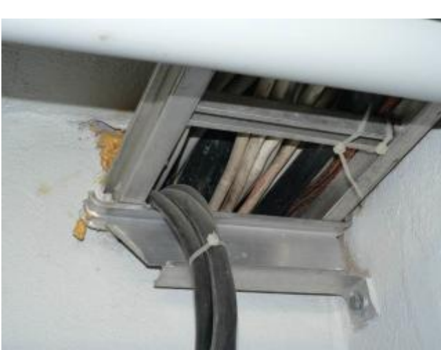
S-kuva 1. Rakennuksessa on huonosti tehtyjä tai puuttuvia palokatkoja.
