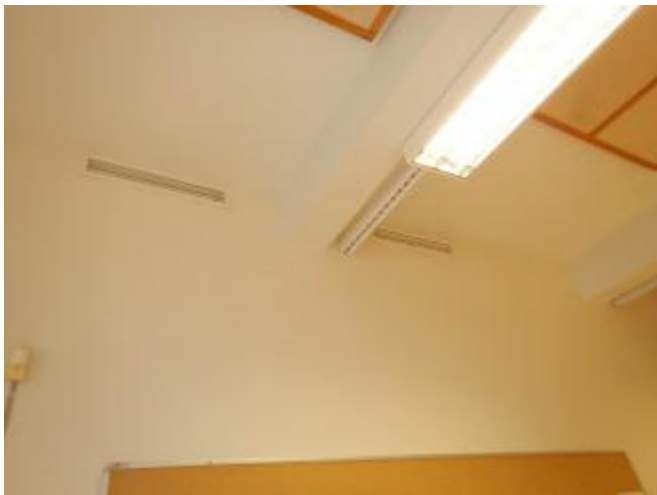
LVI-kuva 23. Yleiskuva pääte-elimistä.
