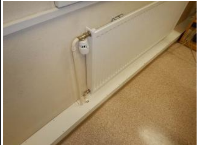
LVI-kuva 6. Yleiskuva uudemista patteriventtiileistä.
