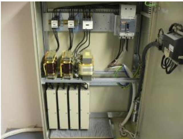
S-kuva 3. Pääkeskushuoneeseen asennettu kompensointiparisto.
