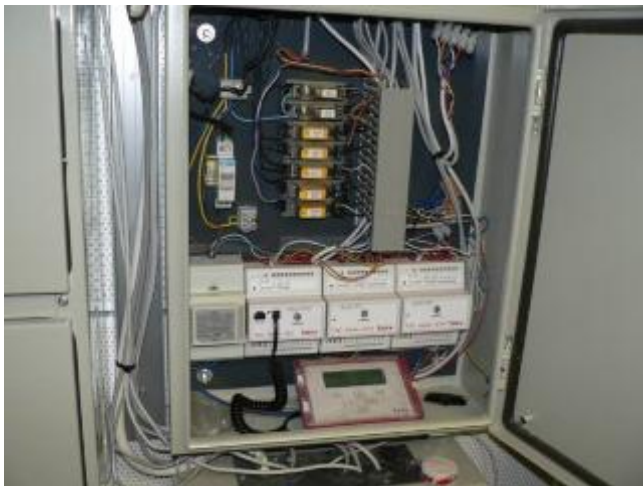
S-kuva 19. IV-konehuoneeseen asennettu alakeskus.
