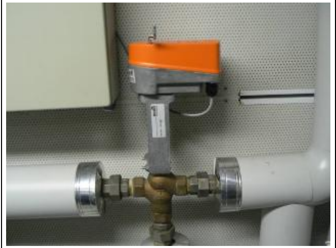
S-kuva 20. Yleiskuva uusitusta moottoriventtiilistä.
