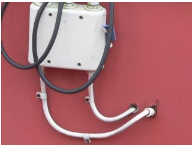
S-kuva 7. Katolla sijaitsevien iv-kojeiden kaapeliläpiviennit ovat epätiveitä.
