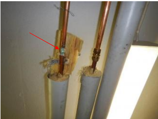
LVI-kuva 11. LVK-putkessa havaittiin vuoto.
