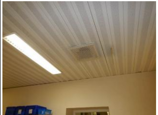
LVI-kuva 24. Yleiskuva pääte-elimistä.
