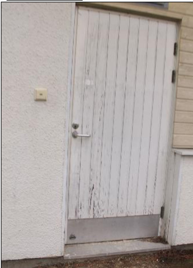
RAK-kuva 35. Laajennusosan puupaneliovi, maali-pinnat kuluneita
