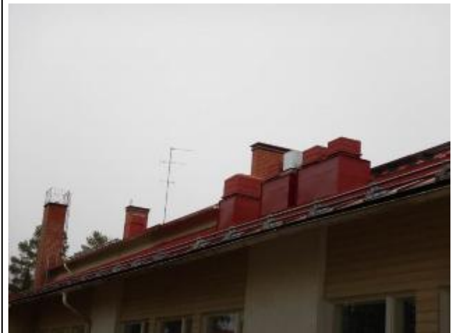
LVI-kuva 20. Yleiskuva poistoilmakoneista.
