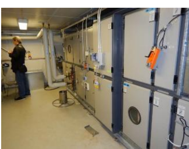
LVI-kuva 21. Yleiskuva TIK-3.1/PIK-3.1 koneista.
