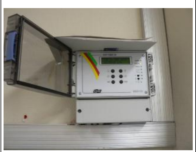
S-kuva 18. Opettajien huoneeseen asennettu päakello.
