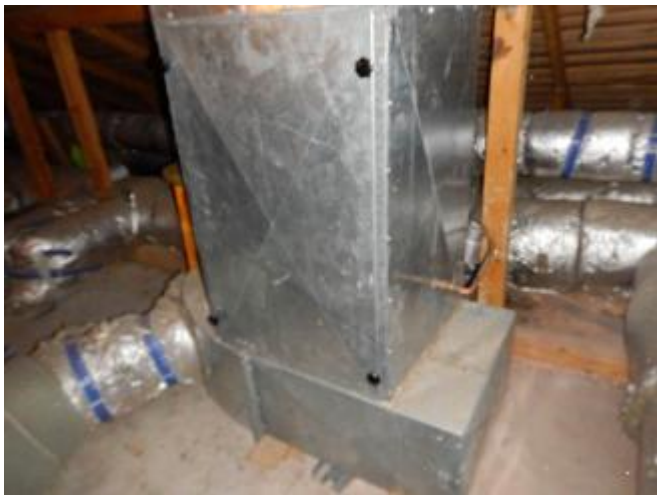
LVI-kuva 19. Yleiskuva poistoilmakoneista.
