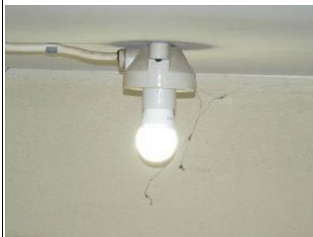
S-kuva 10. Hehkulamppuvalaisimista puuttuu kupuja.
