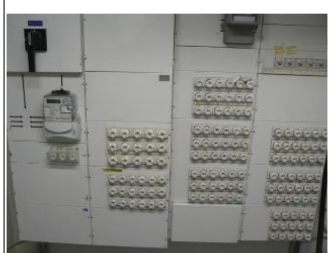
S-kuva 2. Yleiskuva pääkeskuksesta.
