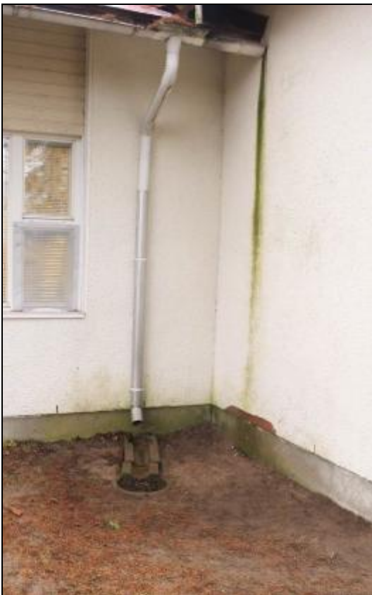
RAK-kuva 7. Kattovesien poistoja. HUOM, kattovesikourut täynnä havuja, vesi padottuu hallitsemattomasti julkisivulle, osin myös sokkeliin
