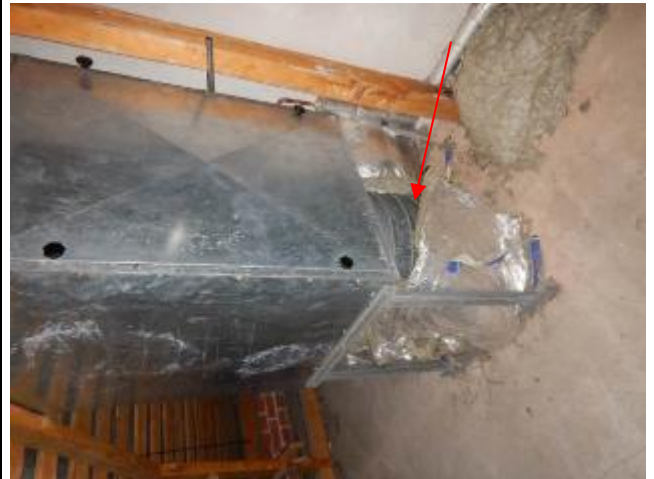
LVI-kuva 22. Kanavaeristeissä on puutteita.
