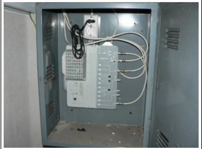
S-kuva 16. Ullakolla sijaitseva antennivahvistin.
