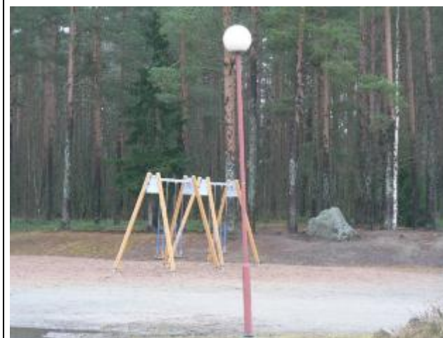
S-kuva 12. Yleiskuva ulkovalaisinpylväästä.
