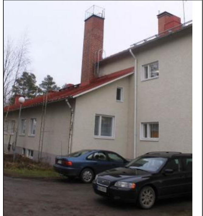
RAK-kuva 40. Keskuslämmityskattilan hormi varusteineen
