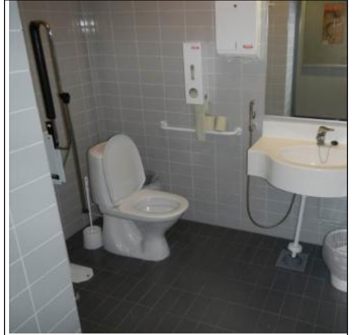
LVI-kuva 2. Yleiskuva vesi- ja viemärikalusteista.
