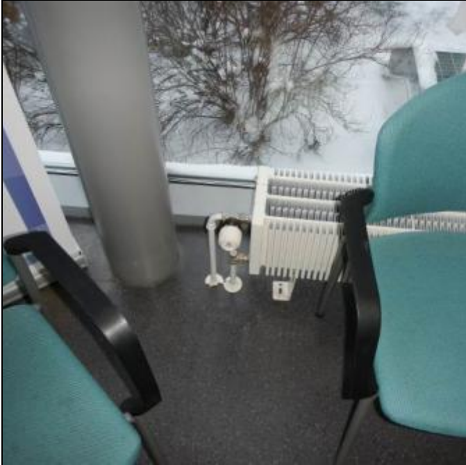
LVI-kuva 1. Yleiskuva patteriventtiilistä.
