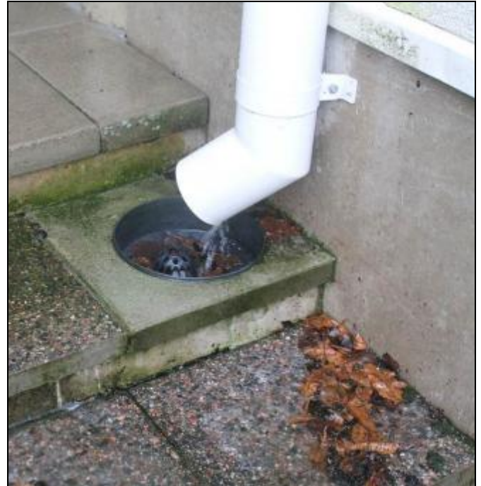
RAK-kuva 6. Syökytorven taustalla betoniseinä pysyy märkänä. Taustalla olevan toimistohuoneen 110 seinän alaosassa ja lattiassa esiintyy kosteusvaurioita.
