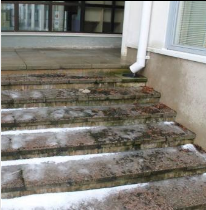
RAK-kuva 5. Syökytorven taustalla betoniseinä pysyy märkänä. Taustalla olevan toimistohuoneen 110 seinän alaosassa ja lattiassa esiintyy kosteusvaurioita.
