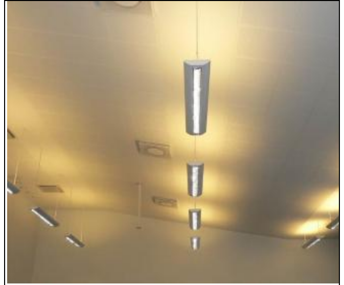
S-kuva 6. Yleiskuva luentosalin valaisimista.
