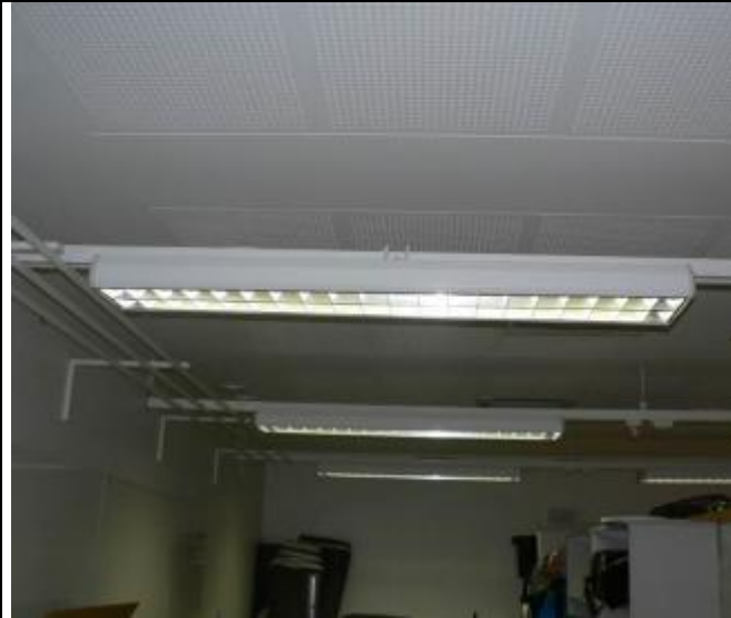
S-kuva 5. Yleiskuva toimistohuoneen valaisimista.
