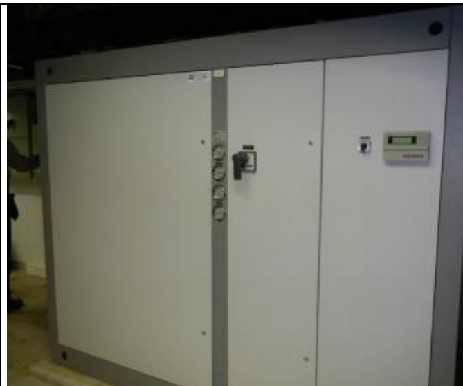
LVI-kuva 11. Yleiskuva jäähdytyskojeesta.
