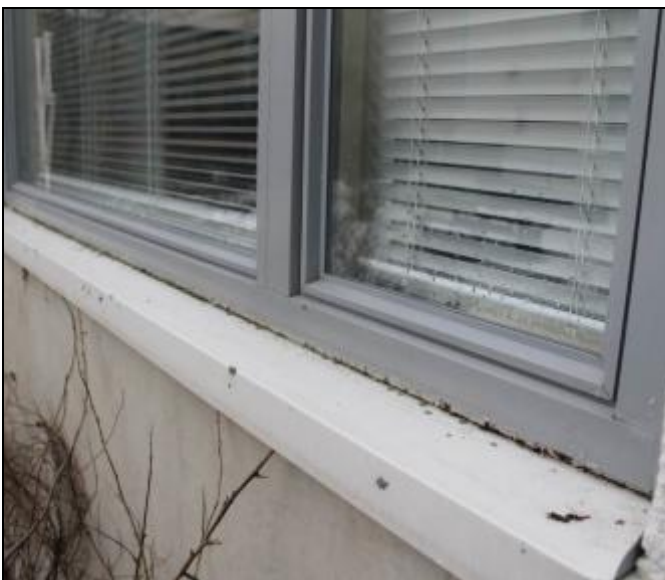
RAK-kuva 11. Hyväkuntoinen toimistohuoneen puu-/alumiini-ikkuna
