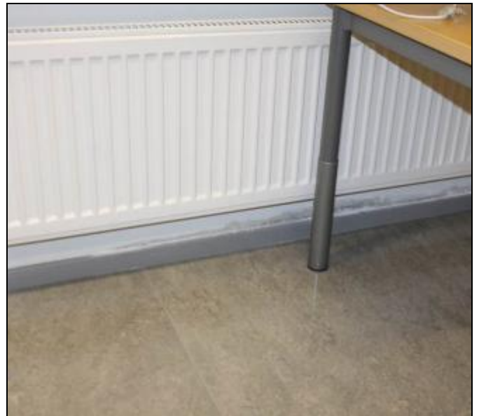
RAK-kuva 24. Huonetilan 110 ulkoseinän alaosassa on näkyviä kosteusvaurioita. Seinän alaosa ja lattia ovat pintakosteudentunnistimella märkiä (vrt. ulkopuolen valokuvat 5 ja 6)
