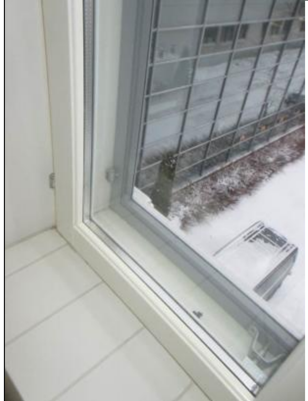
RAK-kuva 10. Hyväkuntoinen toimistohuoneen puu-/alumiini-ikkuna
