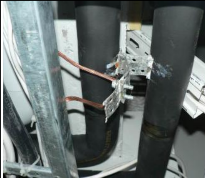
S-kuva 1. Kylmäaineputkistojen maadoituspan- ta on hapettunut.
