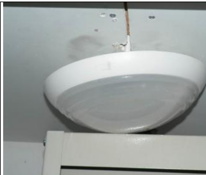
S-kuva 7. ATK-jakamon JK7 valaisin on irronnut.
