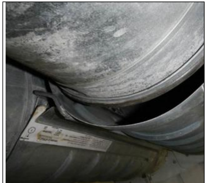
LVI-kuva 8. Puhdistusluukku on auki.
