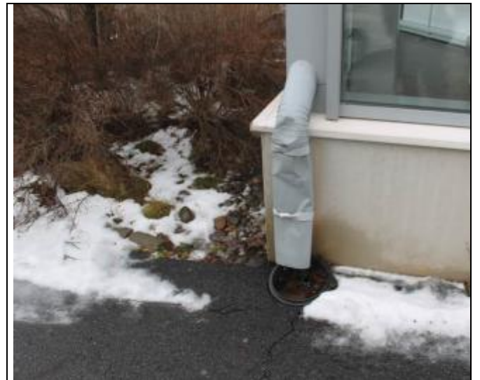
RAK-kuva 4. Mekaanisesti vaurioitunut syöksytorven alaosa
