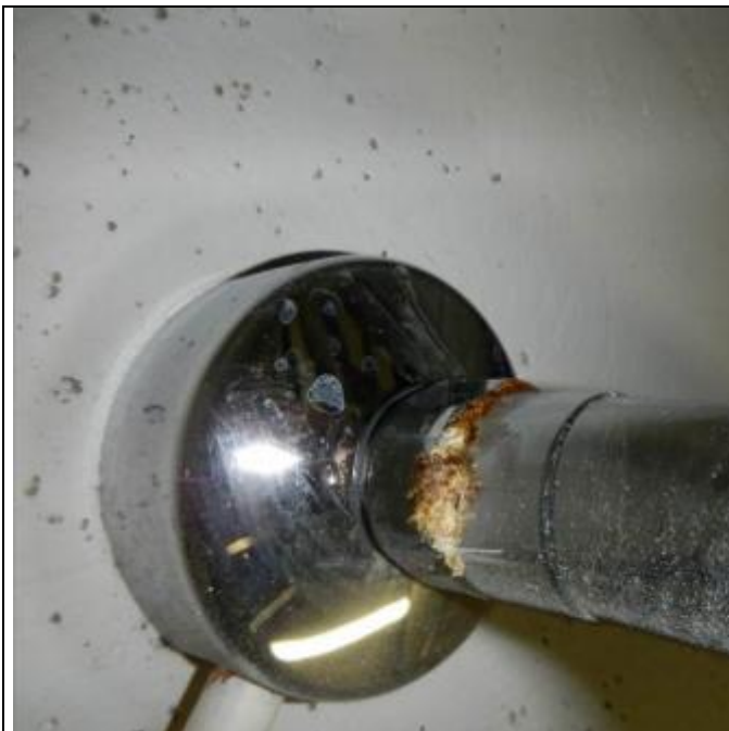
LVI-kuva 3. LVK-kuivauspattereiden tiivisteissä on vuotojälkiä.
