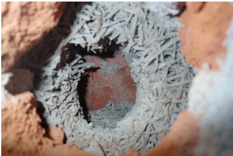
Kuva 9. Valtuustosalin rakenneavauskohta RA1. Toja-levystä otettiin materiaalinäyte M4. Toja-levy kosteusvaurioituu herkästi, mikäli levy kostuu tai kastuu.
