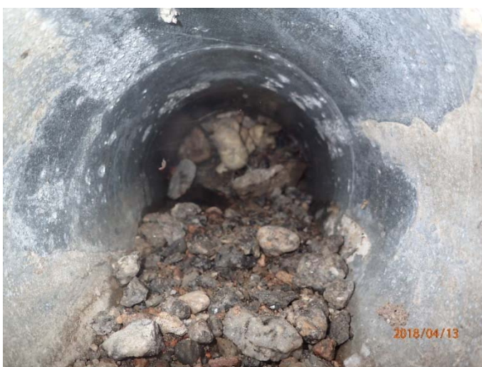
Kuva 17. Alapohjan tuuletusreitit olivat tukkeutuneet maa-aineksella.
