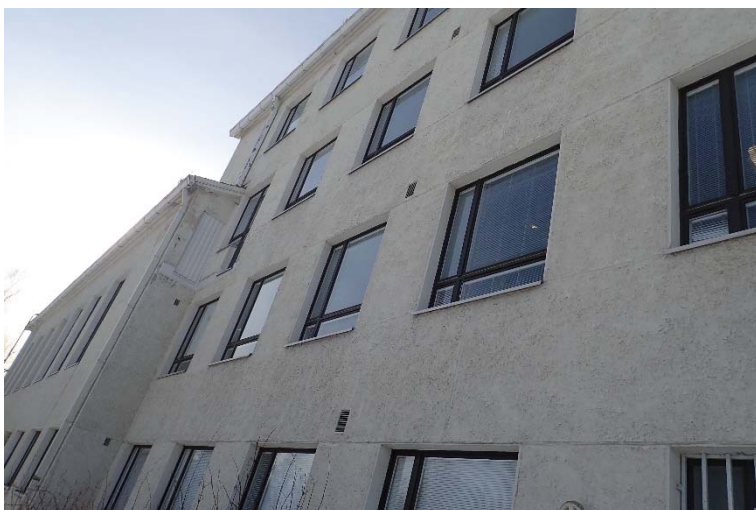
Kuva 12. Valtuustosalin rakenneavauskohdassa on ollut parveke. Parvekkeen alapuolella on tila 258. Vaakarännit ovat todennäköisesti tukkeutuneet.
