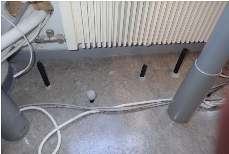
Kuva 18. Tilan 101 betonilaatta oli ulkoseinän läheisyydessä viileä. Ilmalämpöpumpulle tehty seinänlävistys oli epätiivis.
