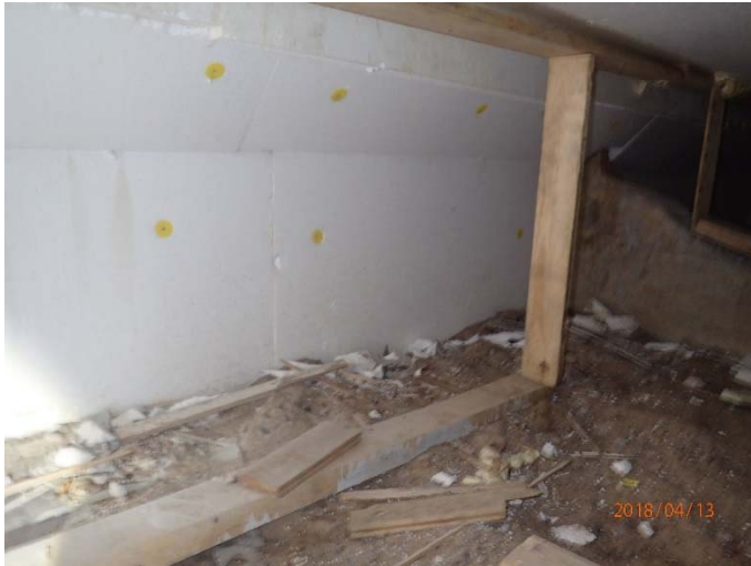
Kuva 15. Alapohjan tuuletustilassa ei havaittu merkittävää kosteutta. Maapohjan päällä oli rakennusaikaista orgaanista materiaalia
