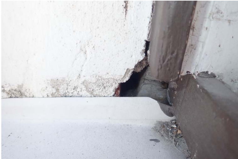
Kuva 13. Ulkoseinän ja ikkunarakenteen välissä reikä.
