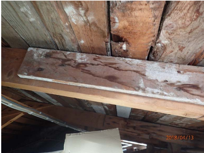
Kuva 24 Vanhanosan vesikattorakenteissa oli merkkejä paikallisista vesivuodoista
