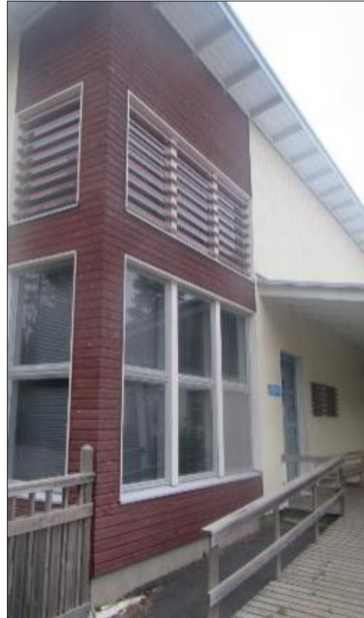
RAK-kuva 22. Rakennuksen puuverhoiltuja julkisivuja. Maaluspinnat kuluneita etenkin eteläpuolen julkisivuosilla
