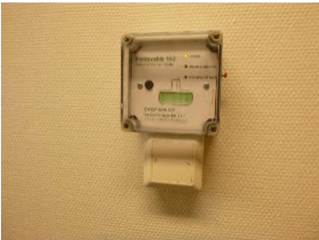
S-kuva 5. Rasvanerotuskaivon hälytyskeskus.
