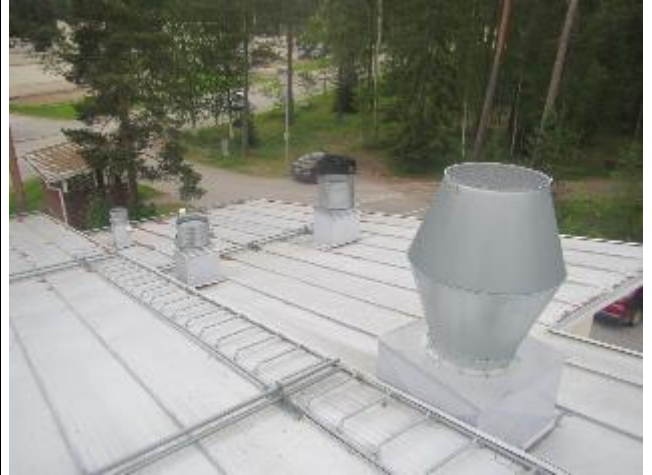
LVI-kuva 10. Yleiskuva huippuimureista.
