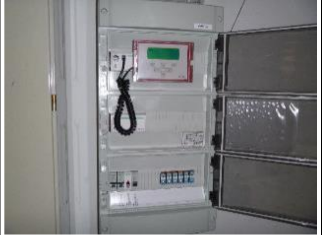
S-kuva 12. IV-konehuoneeseen asennettu rakennusautomaatiojärjestelmän alakeskus.
