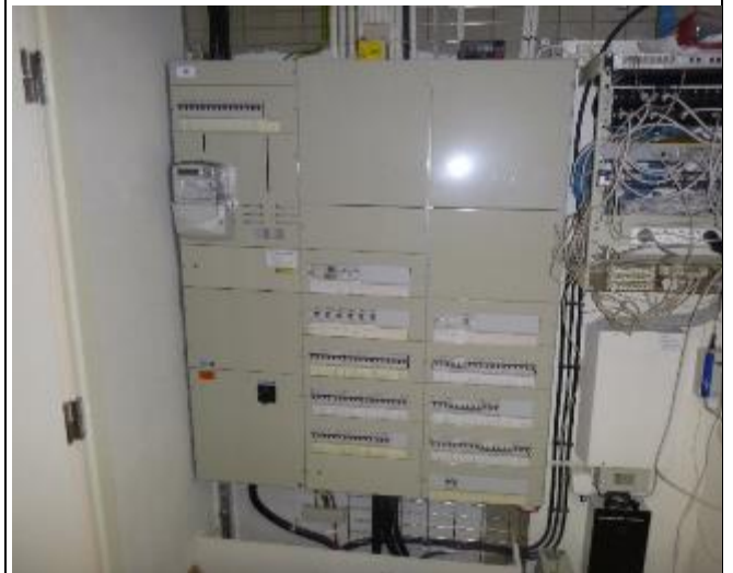
S-kuva 2. Yleiskuva pääkeskuksesta.
