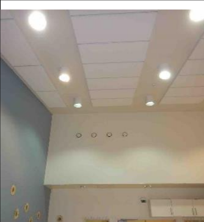
LVI-kuva 13. Yleiskuva pääte-elimistä.
