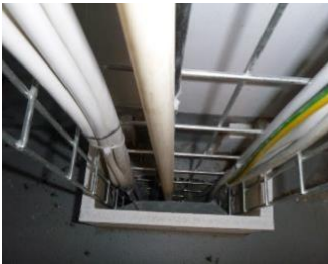
S-kuva 1. Kaapeliläpiviennistä puuttuu palokatko.
