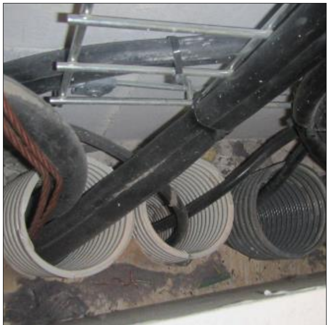
RAK-kuva Eteisen sähkökeskus. Suojaputket 50. avoimia alapohjaan. Korvausilman kulkeutumismahdollisuus alapohjan kautta huonetiloihin päin
