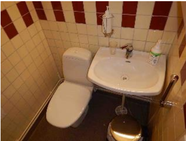
LVI-kuva 7. Yleiskuva vesi- ja viemärikalusteista.
