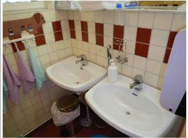
LVI-kuva 6. Yleiskuva vesi- ja viemärikalusteista
