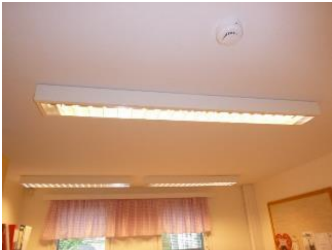
S-kuva 7. Yleiskuva toimiston valaisimista.
