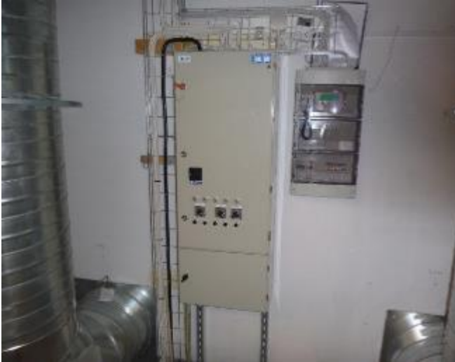
S-kuva 3. Yleiskuva iv-konehuoneen jakokeskuksesta.
