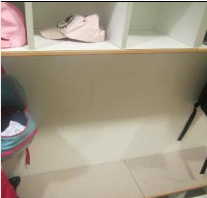
RAK-kuva Tiiliseinän halkeamaa 37.
