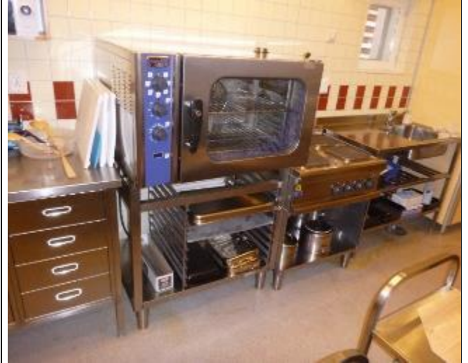
S-kuva 4. Yleiskuva jakelukeittiön kojeista.
