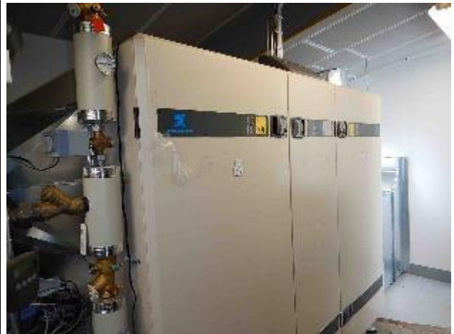
LVI-kuva 8. Yleiskuva IV-koneista.
