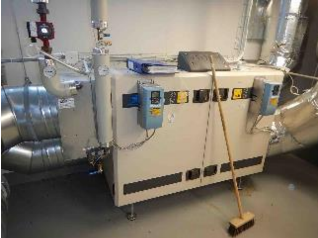
LVI-kuva 9. Yleiskuva IV-koneista.
