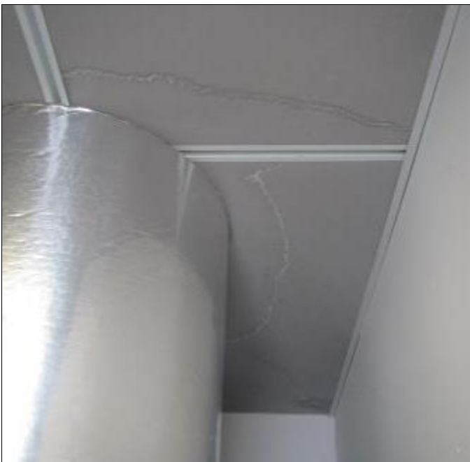
RAK-kuva Ilmanvaihtokojehuoneen katossa kos- 49. teusjäljet
