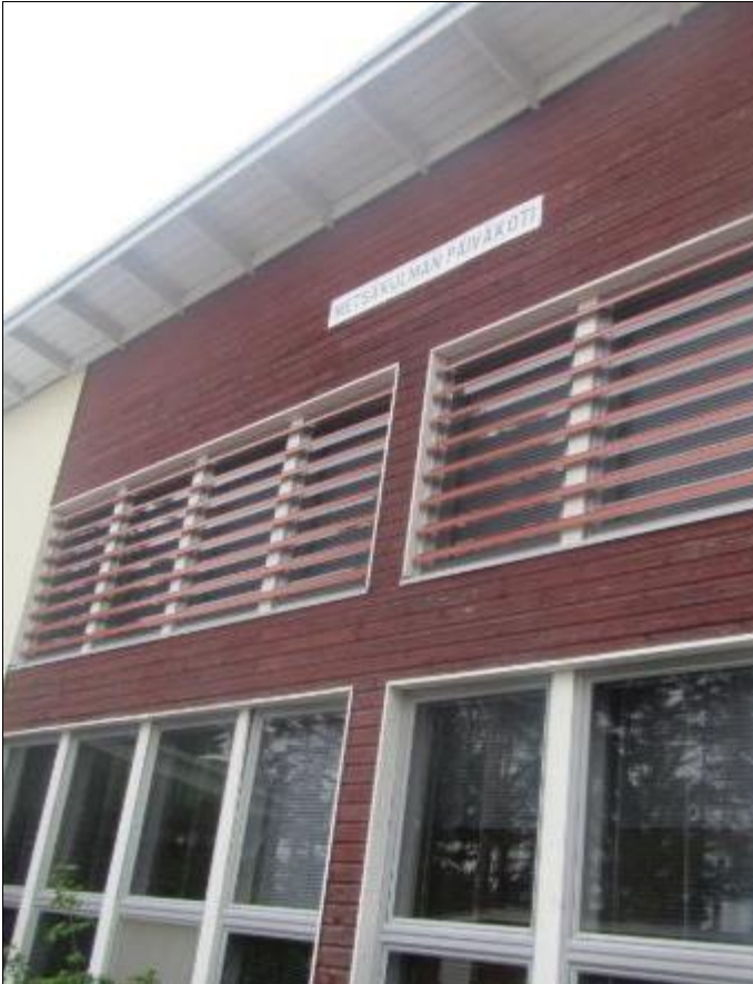
RAK-kuva 21. Rakennuksen puuverhoiltuja julkisivuja. Maaluspinnat kuluneita etenkin eteläpuolen julkisivuosilla
