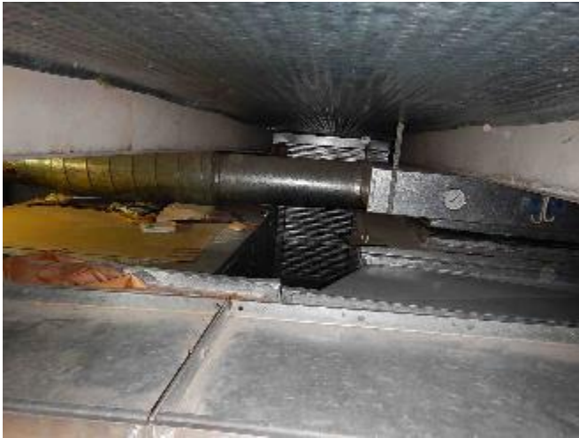
LVI-kuva 9. Yleiskuva iv-konehuoneesta.
