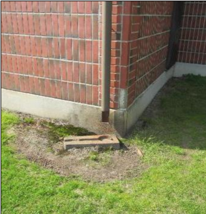
RAK-kuva 5. Kattovesien poistot ovat hallitsemattomasti sokkelien viereen. Kattovedet roiskuvat sokkeleita vasten ja jäävät sokkelien viereen
