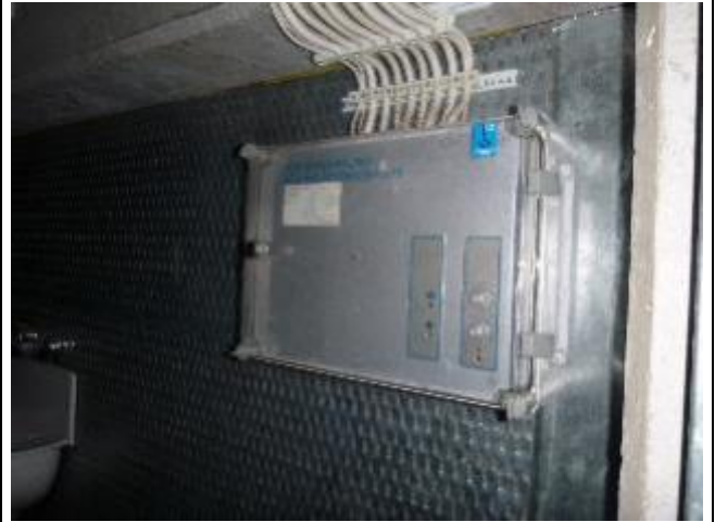
S-kuva 8. IV-konehuoneeseen asennettu säätökeskus.
