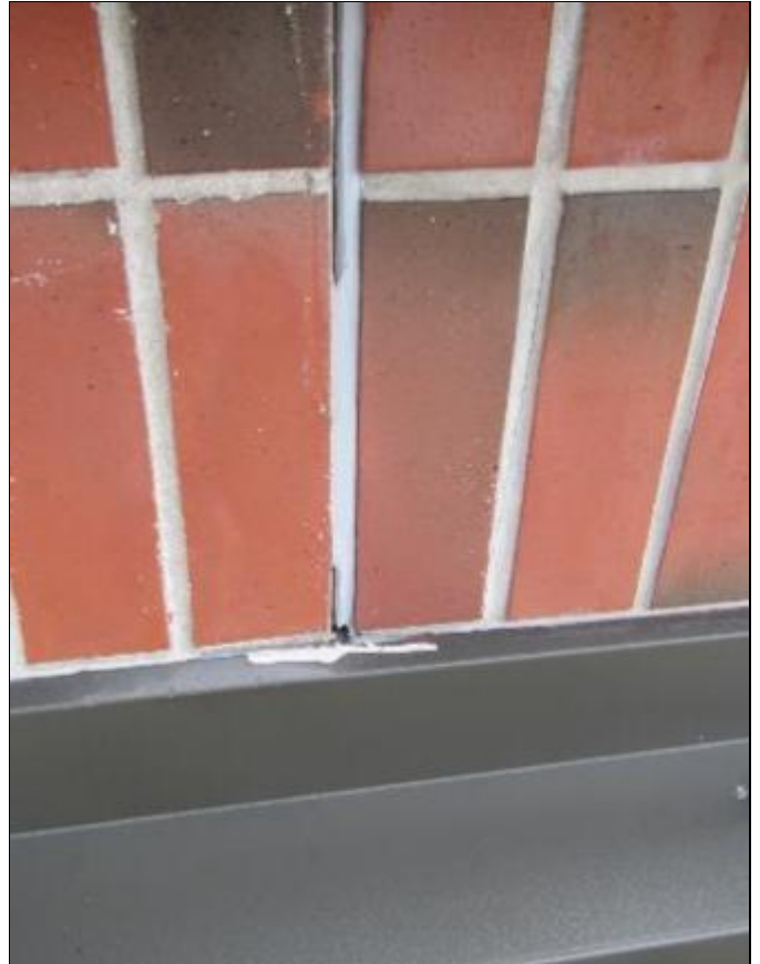
RAK-kuva 16. Seinäelementtien puutteellisia saumauksia
