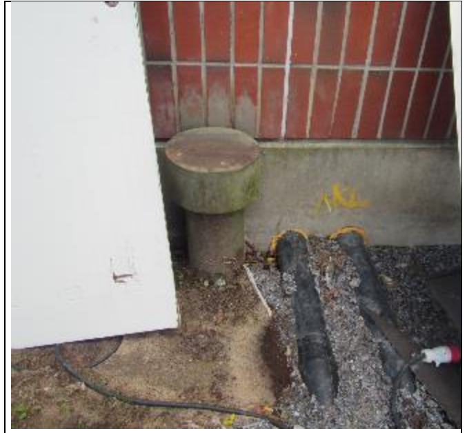
RAK-kuva 10. Sokkelin ja seinäelementin väliset elastiset saumaukset ovat osin puutteellisia. Sokkelin putkiläpiviennit ovat vedeneristämättömiä
