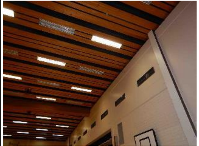
LVI-kuva 10. Yleiskuva ilmanvaihdon pääte-elimistä.
