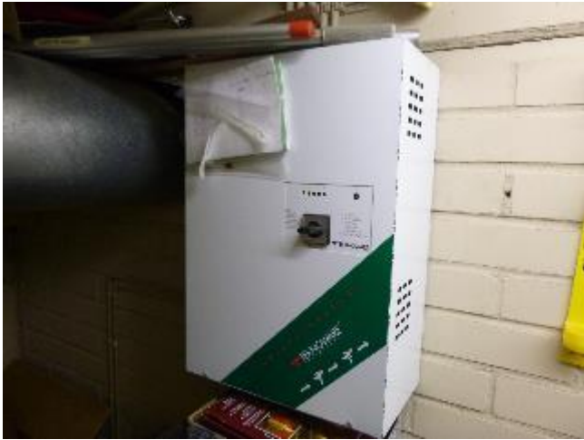
S-kuva 7. Pääkeskushuoneeseen asennettu turvavalaistuskeskus.
