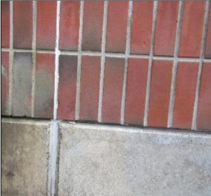
RAK-kuva 9. Sokkelin ja seinäelementin väliset elastiset saumaukset ovat puutteellisia.
