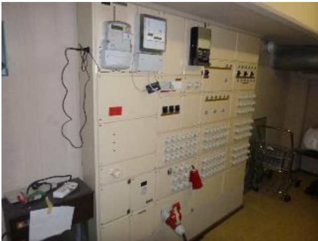
S-kuva 1. Kellarikerrokseen asennettu pääkeskus.
