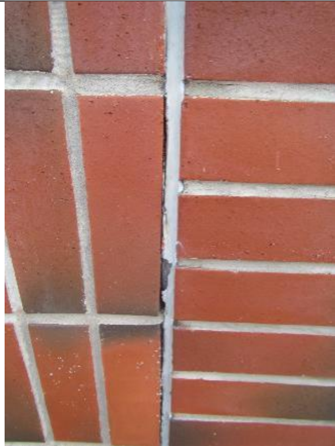
RAK-kuva 15. Seinäelementtien puutteellisia saumauksia
