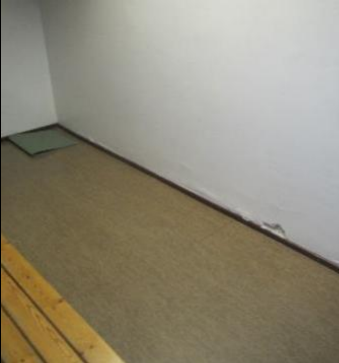
RAK-kuva 31. Kellarikerroksen pukuhuoneessa kantavan seinän alaosa hilseilee kosteuden vaikutuksesta
