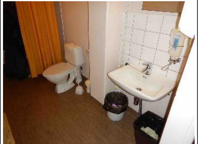
LVI-kuva 6. Yleiskuva vesi- ja viemärikalusteista.
