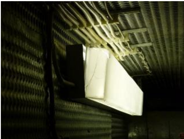
S-kuva 5. IV-konehuoneen valaisimien kuvut ovat halkeilleet.
