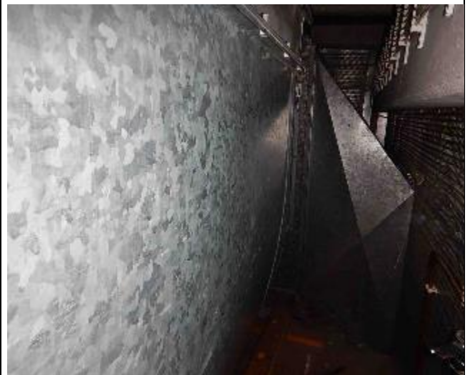
LVI-kuva 8. Yleiskuva iv-konehuoneesta.
