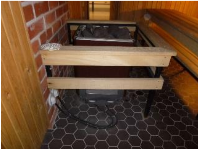
S-kuva 3. Saunaan asennettu 15 kW sähkökuuas.
