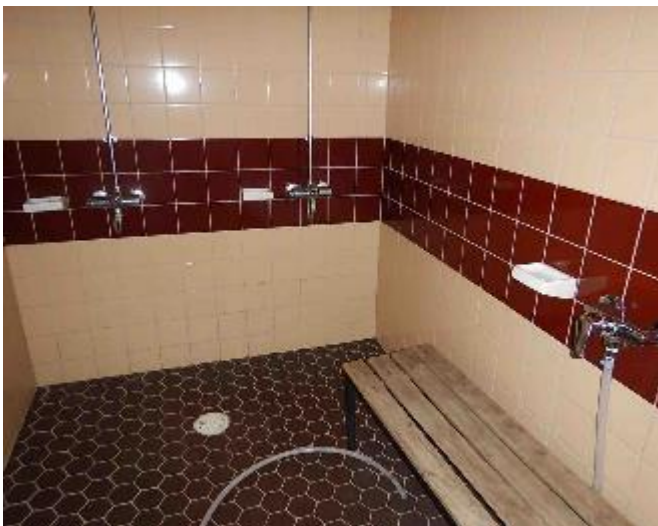
LVI-kuva 7. Yleiskuva vesi- ja viemärikalusteista.
