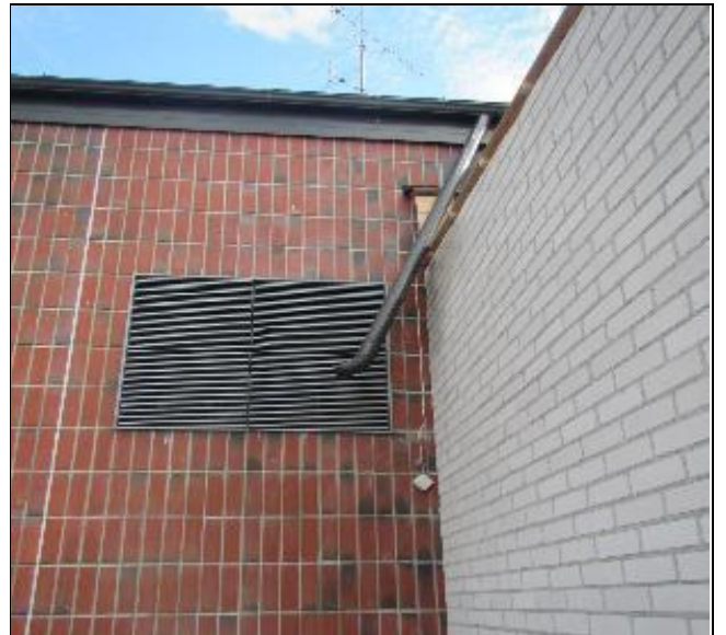
RAK-kuva 8. Kattovesin ohjaukset ovat puutteellisia johtuen uudisrakentamisen vaiheista.
