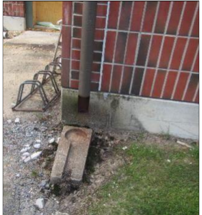
RAK-kuva 6. Kattovesien poistot ovat hallitsemattomasti sokkelien viereen. Kattovedet roiskuvat sokkeleita vasten ja jäävät sokkelien viereen
