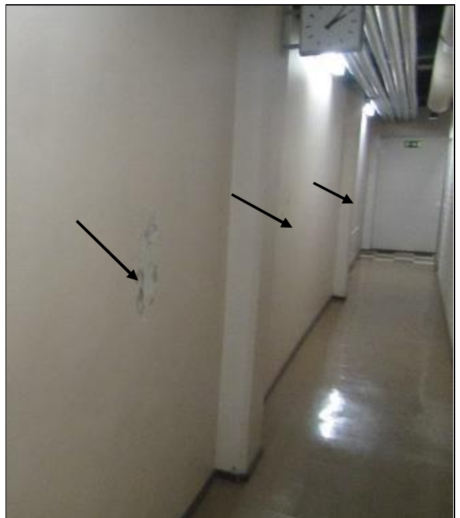
RAK-kuva 30. Yleiskuva kellarikäytävältä. Maanpainesseinän osalla näkyviä kosteudesta aiheutuvia vauriojälkiä, Lattia osin pintakosteaa
