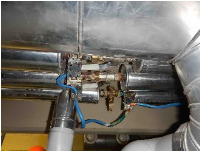
LVI-kuva 5. Yleiskuva käyttövesiverkoston venttiileistä.
