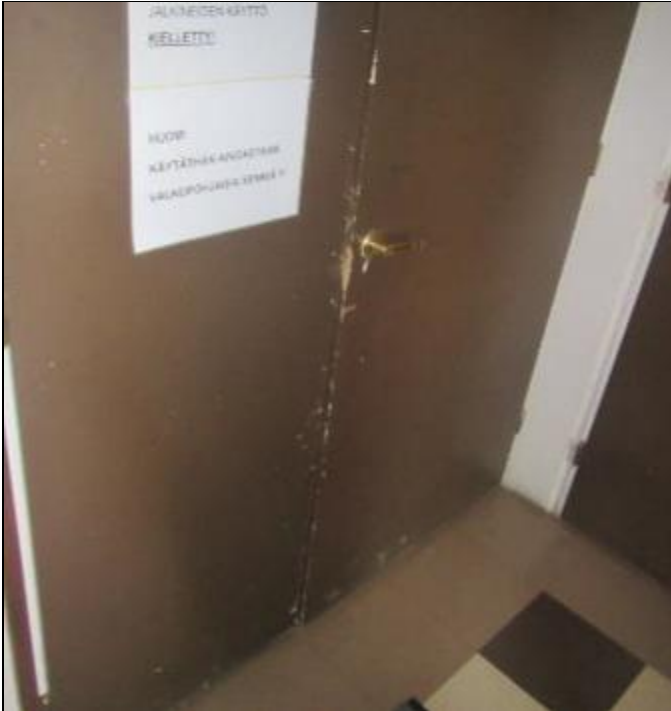
RAK-kuva 27. Mekaanisesti kolhiintuneita alkuperäisiä väliovia.
