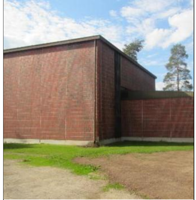
RAK-kuva 2. Yleiskuva eteläpuoleiselta pihalueelta. Alueen nurmi- ja sorapintaa. Päällysrakenteet ovat osin vain välttävässä kunnossa.
