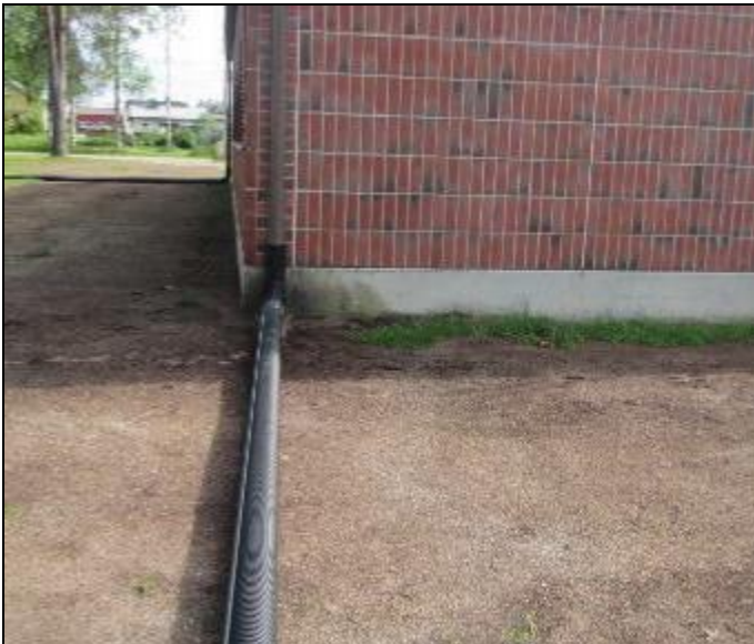
RAK-kuva 7. Kattovesien poistot ovat hallitsemattomasti sokkelien viereen. Kattovedet roiskuvat sokkeleita vasten ja jäävät sokkelien viereen. Kattovesiä ohjataan väliaikaisesti uuden nurmikon ”yli”
