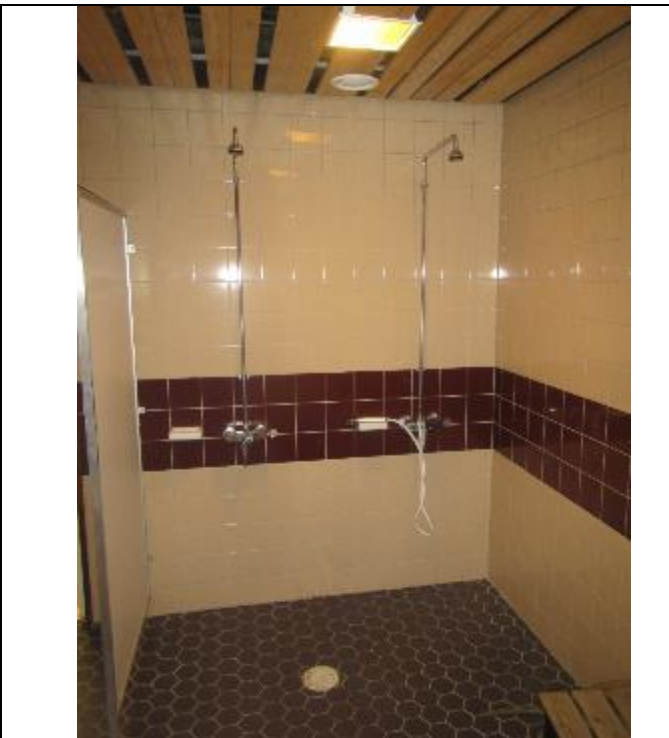
RAK-kuva 33. Yleiskuva alkuperäistason pesuhuoneesta. Seinien alaosa osin pintakosteita
