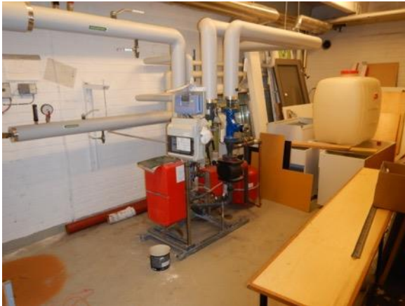
Kuva 46 Yleiskuva lämmönjakohuoneen laitteista.
