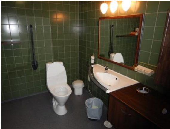
Kuva 51 Yleiskuva vesi- ja viemärikalusteista.
