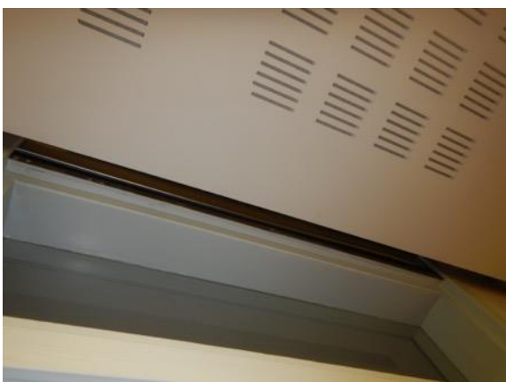
Kuva 61 Siirtoilmaelimen ilmareitti on alakaton kohdalla.
