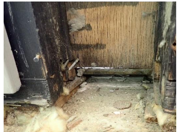
Kuva 19 Kuntotutkimusvalokuva Tyypillinen rakenneavaus ikkunoiden vä- liosalla. Karmipinnoilla ja levyverhouksen taut- tapinnalla on havaittavissa näkyviä kosteus- ja lahovaurioita. Ulkoseinän ikkunoiden välin le- vyosuuden ja vesipellin liittymä on avoin.
