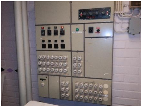
Kuva 69 Kellarikerroksessa sijaitseva ryhmäkeskus.
