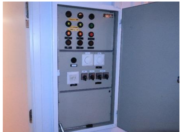
Kuva 70 Valaistuksen ja ilmanvaihdon ohjauskeskus.
