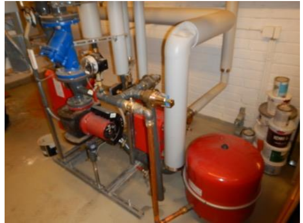
Kuva 47 Yleiskuva lämmönjakohuoneen laitteista.
