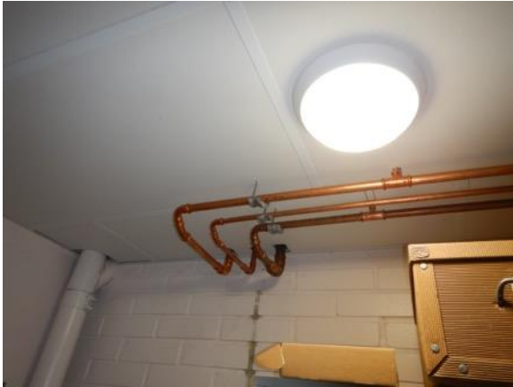
Kuva 50 Uusittuja käyttövesiputkia ei ole eristetty.
