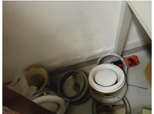
Kuva 27 Kuntotutkimusvalokuva: Kellari, käytävätilan väliseinä tilaa 010 vasten. Seinän alaosasta maalipinnat hilseilevät poikkeavan kosteuden vaikutuksesta irti.
