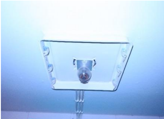
Kuva 73 Valaisimista puuttuu kupuja.
