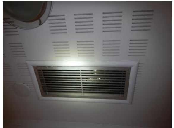
Kuva 60 Ilmanvaihdon pääte-elimissä on suojaamatonta mineraalivillaa.
