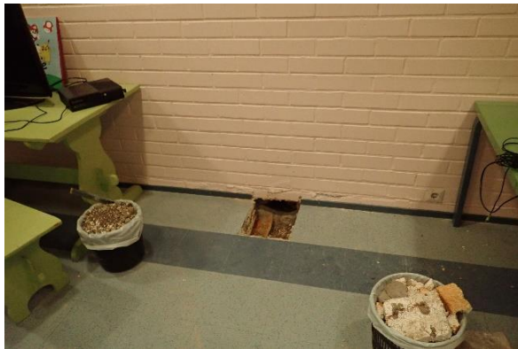
Kuva 12 Kuntotutkimusvalokuva: Huonetila 015. Alapohjan rakennetarkastuspiste AP1. Tarkastuspisteessä betonilaatta on pintakosteushavainnoin märkä ja pinnoitealustassa liima-aineet ovat pilaantuneet kosteuden vaikutuksesta. Alapohjatäyttönä on selkeästi märkä hienojakoinen hiekka.
