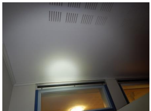
Kuva 62 Myös siirtoilmaelimissä on suojaamatonta mineraalivillaa.
