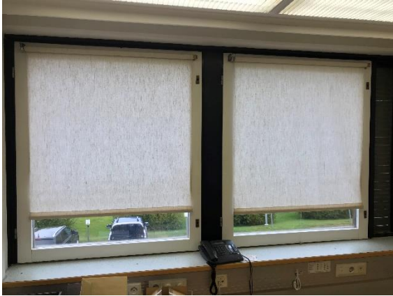
Kuva 16 Toimisto-osan avettava puurakenteinen ikkuna
