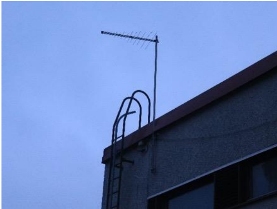
Kuva 79 Rakennuksen seinälle asennettu antenni.
