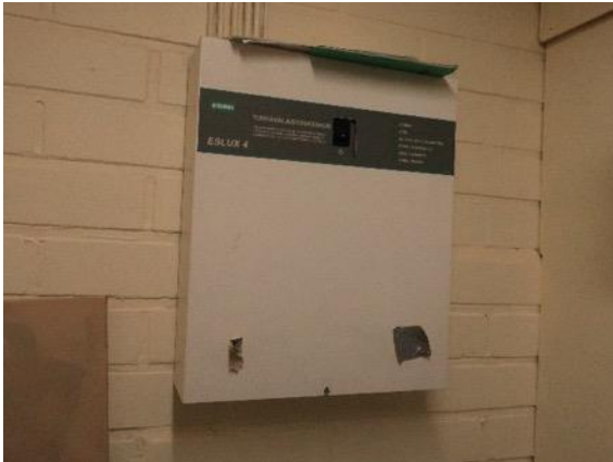
Kuva 77 Pääkeskushuoneessa sijaitseva turvavalaistuskeskus.
