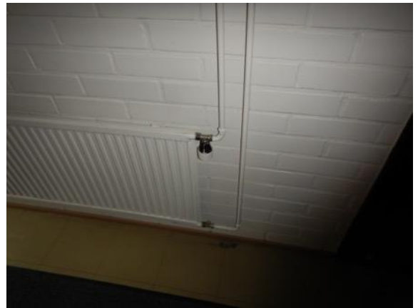
Kuva 49 Yleiskuva lämpöpattereista ja patteriventtiileistä.
