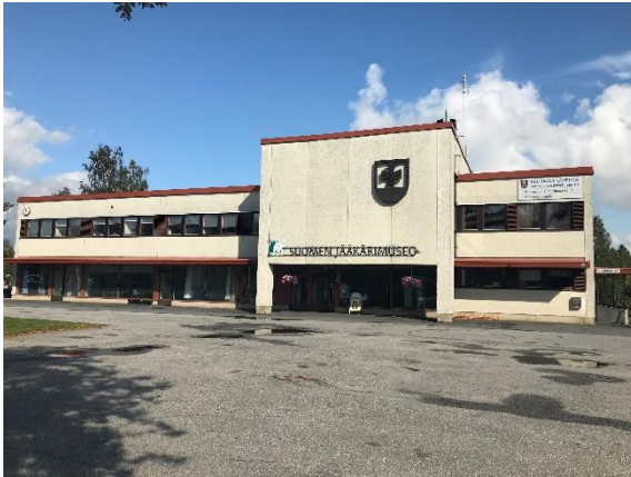
Kuva 2 Yleiskuva etupihan puolen asfaltoidusta pihalueesta. Asfaltoinneissa on paikallisia routavaurioita tai painaumia.
