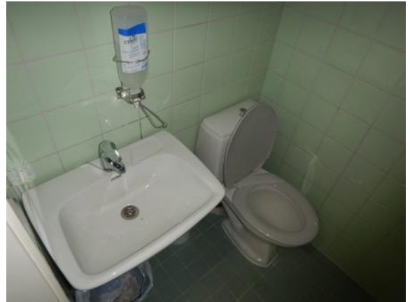
Kuva 52 Yleiskuva vesi- ja viemärikalusteista.
