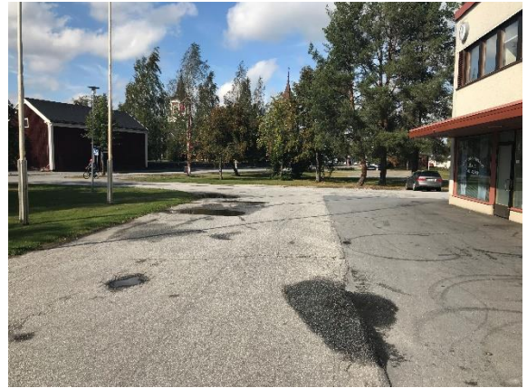
Kuva 3 Yleiskuva etupihan puolen asfaltoidusta pihalueesta. Asfaltoinneissa on paikallisia routavaurioita tai painaumia.
