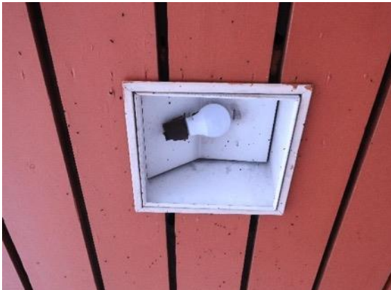
Kuva 75 Etupihan katoksen valaisimista puuttuvat suo- japleksit.
