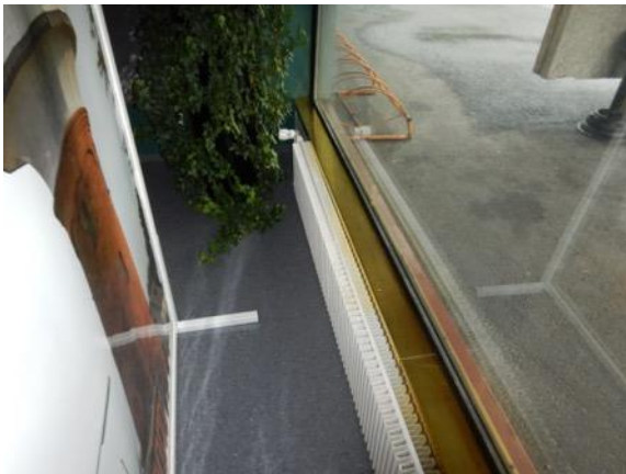
Kuva 48 Yleiskuva lämpöpattereista ja patteriventtiileistä.
