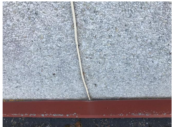
Kuva 25 Yleiskuva vesikatolta, reunaylösnoston epätiiveyspiste
