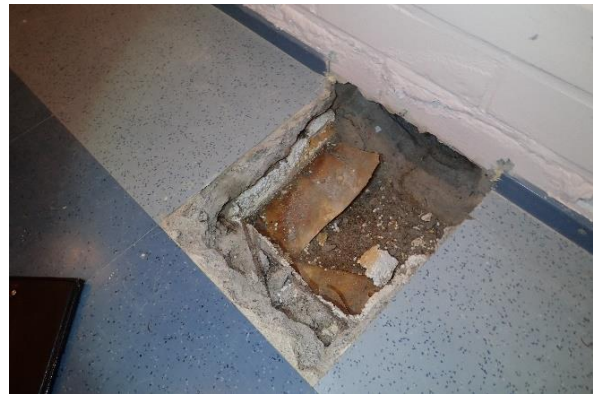
Kuva 13 Kuntotutkimusvalokuva: Huonetila 015. Alapohjan rakennetarkastuspiste AP1. Alapohjatäyttönä on selkeästi märkä hienojakoinen hiekka, joka on kapillaarisessa kosketusyhteydessä mm. kuoriverhouksmuurauksen alaosaan
