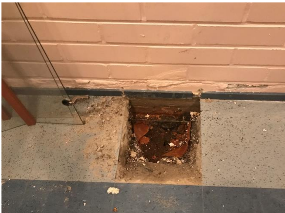
Kuva 10 Kuntotutkimusvalokuva: Kerhotilan 015 ulkoseinä, rakenneavauspiste US2 kohdalla. Tiiliseinän alaosasta maali kupruilee irti kosteuden vaikutuksesta. Seinän alaosa on pintakosteudentunnistimella havainnoiden märkä n. 250 mm korkeuteen lattiapinnasta. Seinän alaosa on märkä lattiapinnan tason alapuolella anturan päälle saakka.
