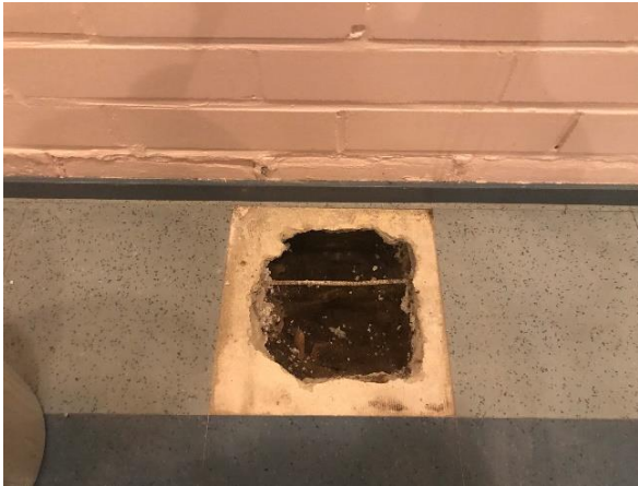
Kuva 26 Kuntotutkimusvalokuva: Kellari, tilan 015 väliseinä tilaa 014 vasten. Seinän alaosasta maalipinnat hilseilevät poikkeavan kosteuden vaikutuksesta irti.
