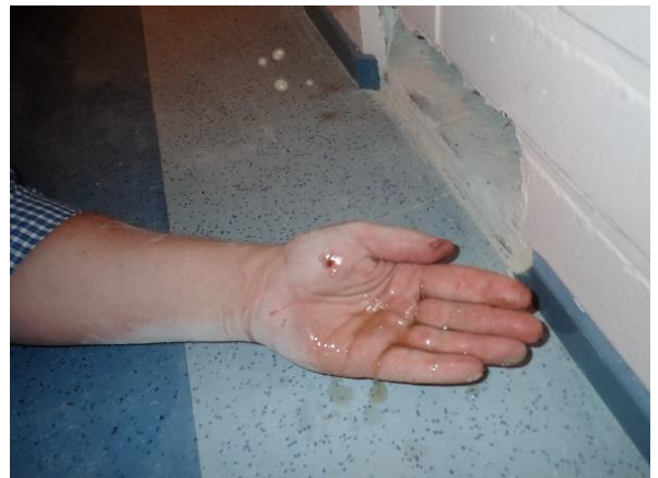
Kuva 11 Kuntotutkimusvalokuva: Maanpaineisen alaosan mineraalivillaeristeet ovat paikoin vesimärkiä. Rakenneavauspisteessä US5, mineraalivillaeristeestä voi puristaa irtovettä
