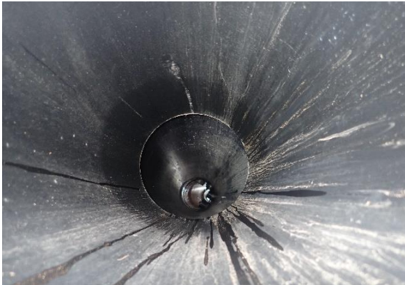
Kuva 6 Salaojan tarkastuskaivo takapihan puolen kulma-alueella. Salaojitus uusittu v. 2010.
