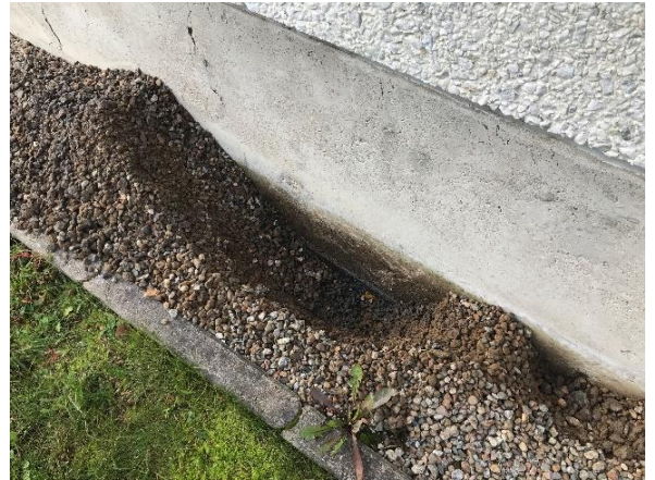
Kuva 7 Sokkelin vierustan sorastettua aluetta. Sokkeliä vasten asennettu perusmuurilevy päättyy sorastetun maanpintatason alapuolelle
