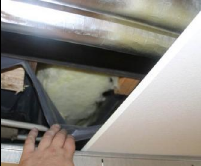
RAK-kuva 61. Liikuntasalin pukuhuoneen edustakäytävällä yläpohjan höyrynsulut ovat rikkonaisia. Käytävällä mineraalivillamainen haju. Haju kulkuetu yläpohjasta rikkonaisten höyrynsulkujen kohdilta tilaan.
