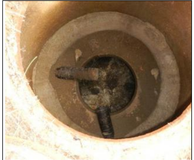
LVI-kuva 8. Yleiskuva sakokaivosta.
