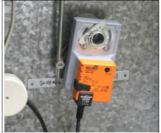
S-kuva 22. Yleiskuva peltimoottorista.
