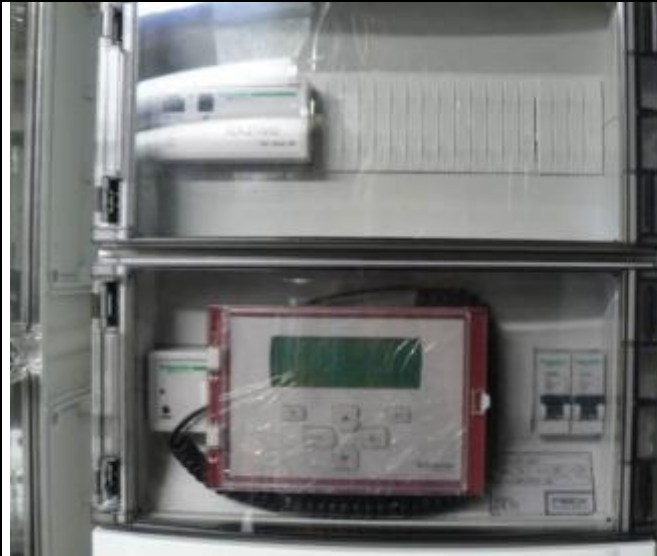
S-kuva 21. Yleiskuva rakennusautomaatiojärjestelmän alakeskuksesta.
