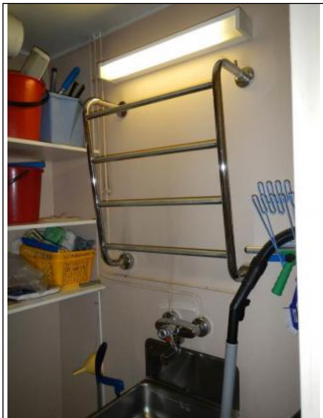
LVI-kuva 12. LVK-pattereiden tiivisteissä on vuotojälkiä.
