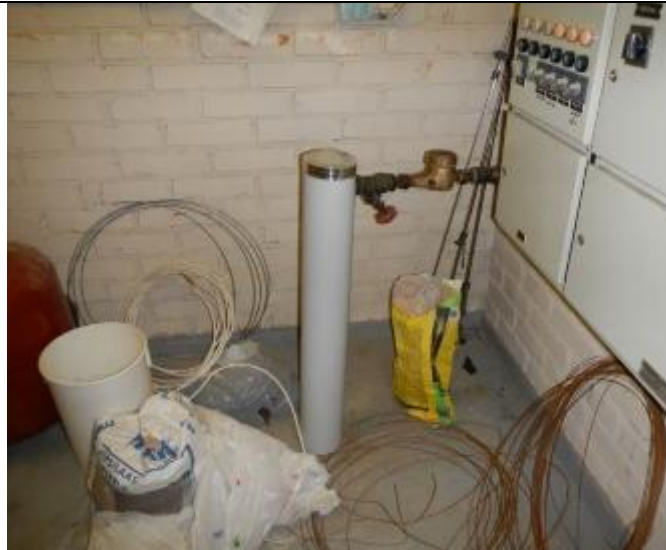
LVI-kuva 7. Yleiskuva vesimittarista ja pääsuluista
