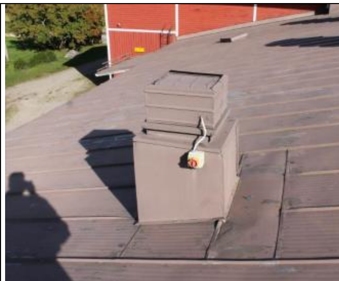
LVI-kuva 17. Yleiskuva vesikatolla olevista huipputimureista.
