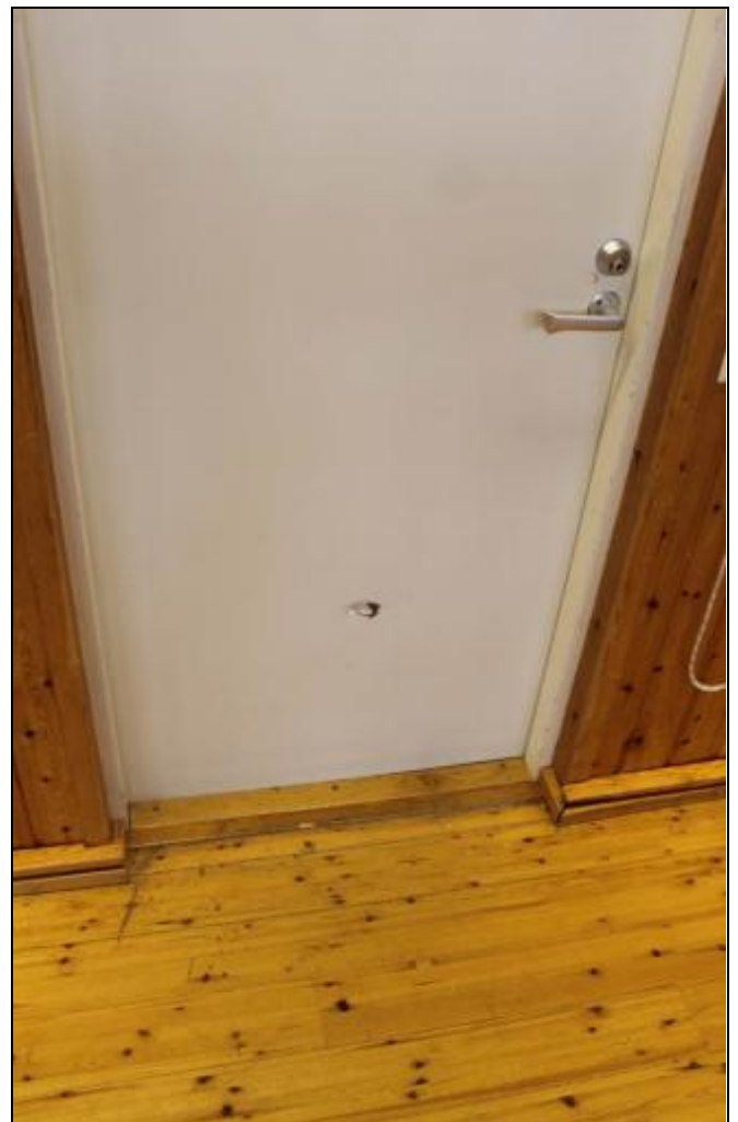
RAK-kuva 48. Mekaanisesti vaurioitunut laakaovi liikuntahallista pukuhuoneeseen.
