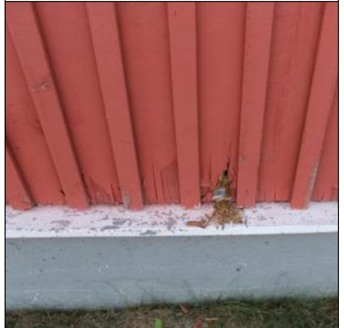
RAK-kuva 24. Liikuntasalin seinien alaosien laudoituksissa maalipinnat hilseilevät kosteuden vaikutuksesta. Laudoitusten alaosissa on kosteudesta aiheutuvia lahovaurioita. Vesipellityksessä ei ole käytännössä kaatoa. Sadevesi imeytyy laudoitusten alahelmoihin.
