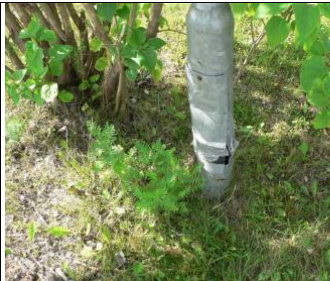
S-kuva 15. Valaisinpylväs on vaurioitunut.
