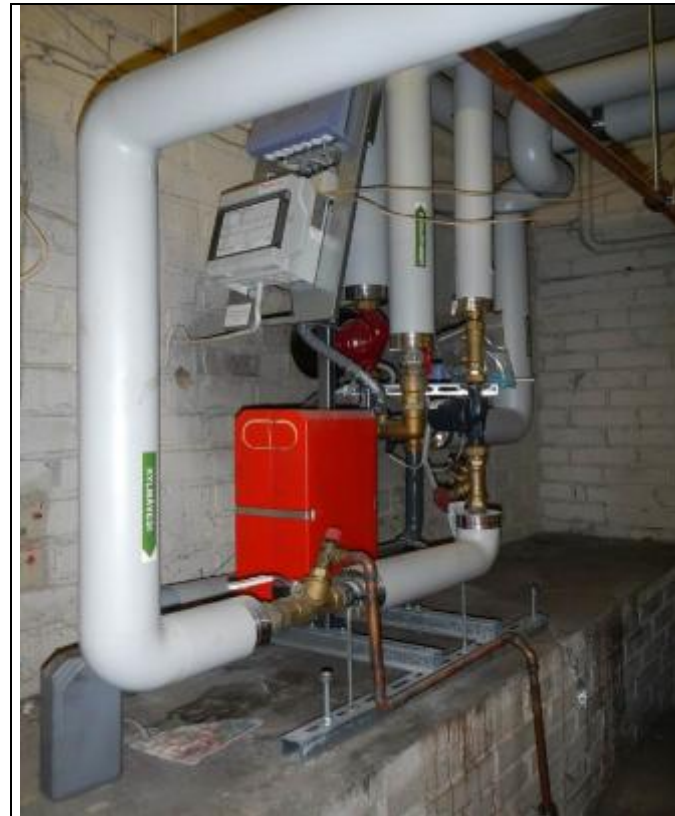
LVI-kuva 2. Yleiskuva käyttöveden lämmönsiirtimestä.
