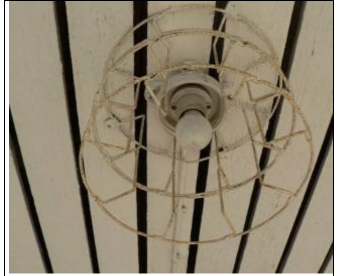
S-kuva 14. Autokatoksen valaisimet ovat rikoontuneet.
