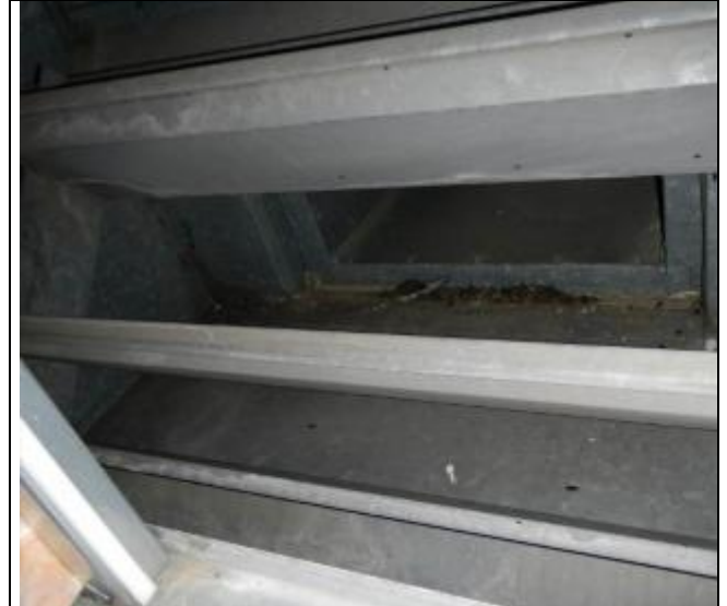
LVI-kuva 20. Raitisilmakammiossa on kuollut lintu.
