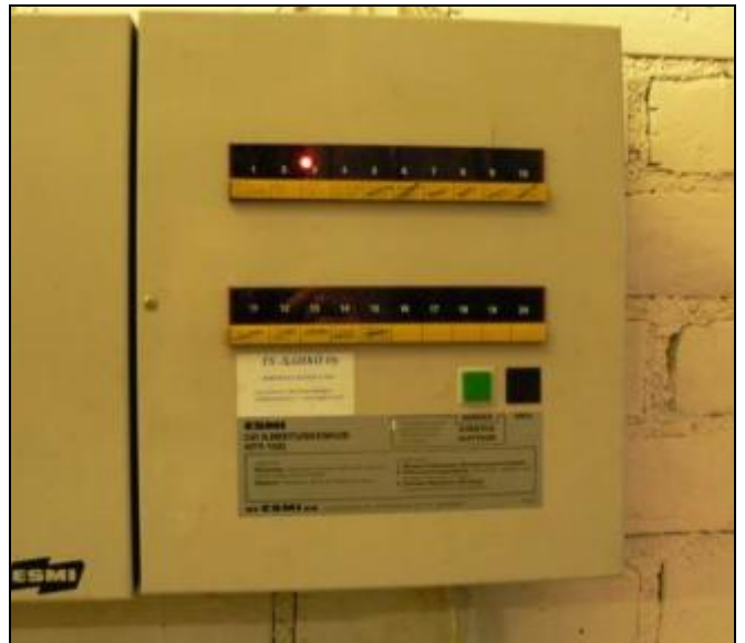
S-kuva 24. Yleiskuva LVIS-hälytyskeskuksesta.
