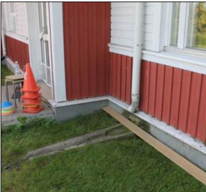
RAK-kuva 7. Laajennusosan länsipuolella oleva kattovesien poisto. Purkuvedet roiskuvat sokkelia vasten.
