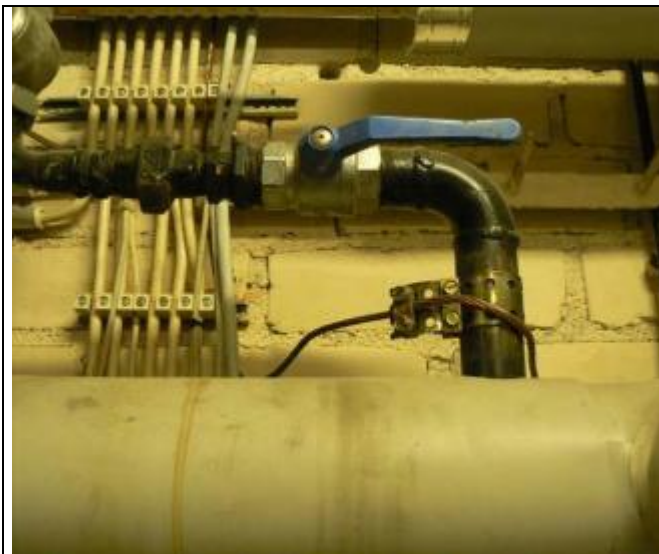
S-kuva 3. Yleiskuva putkistomaadoituksesta.
