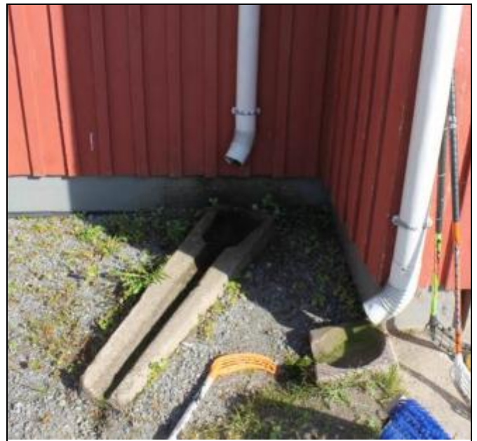
RAK-kuva 8. Kattovesien poistoa rakennuksen etelänpuolella vanhan osan pääsiäänkävyn sivustalla. Kattovedet rasittavat sokkelin vierustaa ja sokkelia. Valesokkeli on kosteusteknisesti riskialtis. Alueelle on paikallisesti asennettu patolevytys sokkelia vasten.
