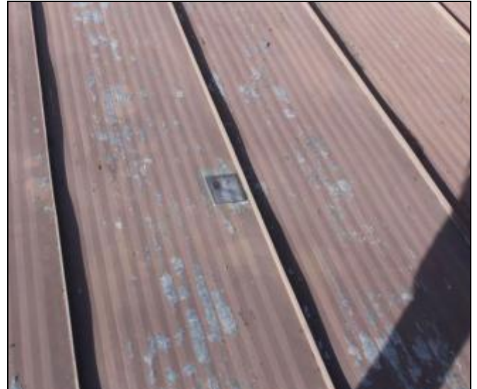
RAK-kuva 38. Vesikatteen maalipinnat hilseilevät irti. Yksittäinen vesikatteen korjauspiste.
