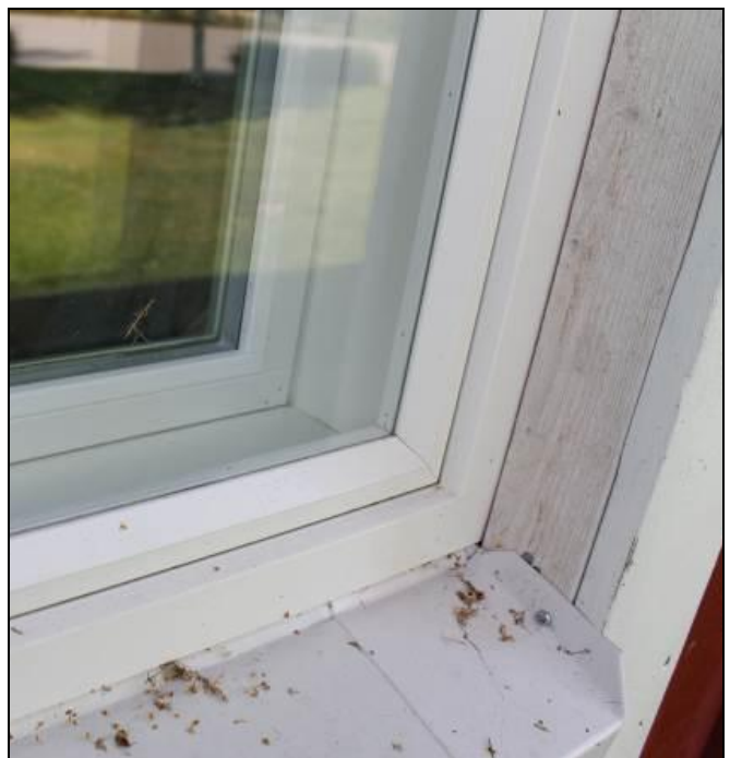
RAK-kuva 28. Vanhan osan teknisen tilan kohdalla ove uusittu puu-/alumiini-ikkuna. Vesipellititys on nostettu smyygiä vasten. Sadevesiä voi ohjautua vesiepllityksen taustalle.
