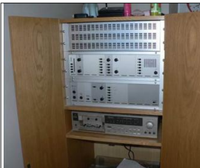
S-kuva 19. Yleiskuva äänentoisto- ja kuulutusjärjestelmän vahvistinkeskuksista.
