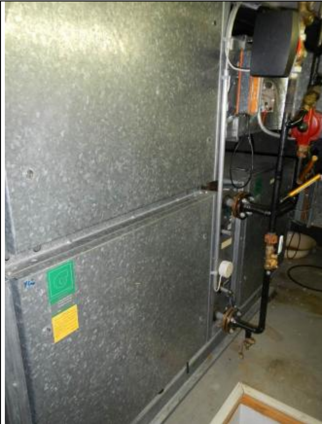
LVI-kuva 15. Yleiskuva TK1 ja PK1 koneista.
