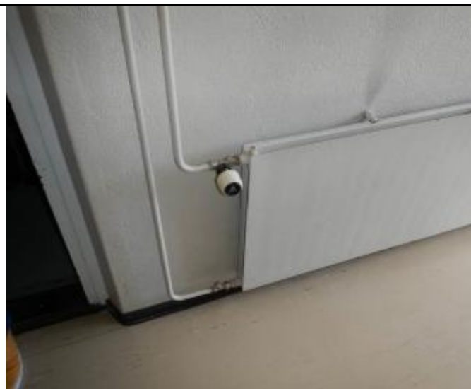
LVI-kuva 5. Yleiskuva vanhoista patteriventtiileistä.
