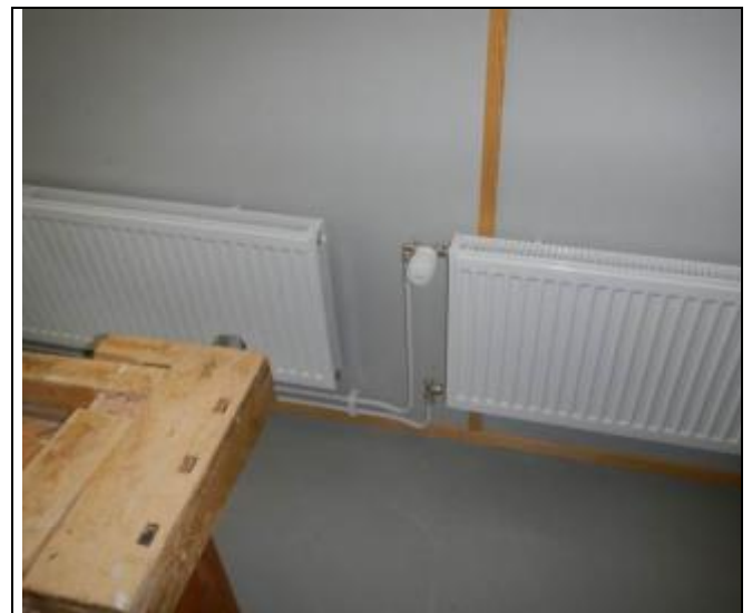
LVI-kuva 6. Yleiskuva teknisen työn patteriventtiileistä.
