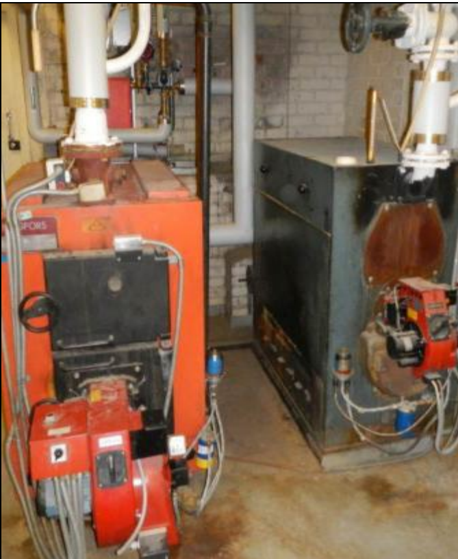
LVI-kuva 1. Yleiskuva kattilalaitoksesta.
