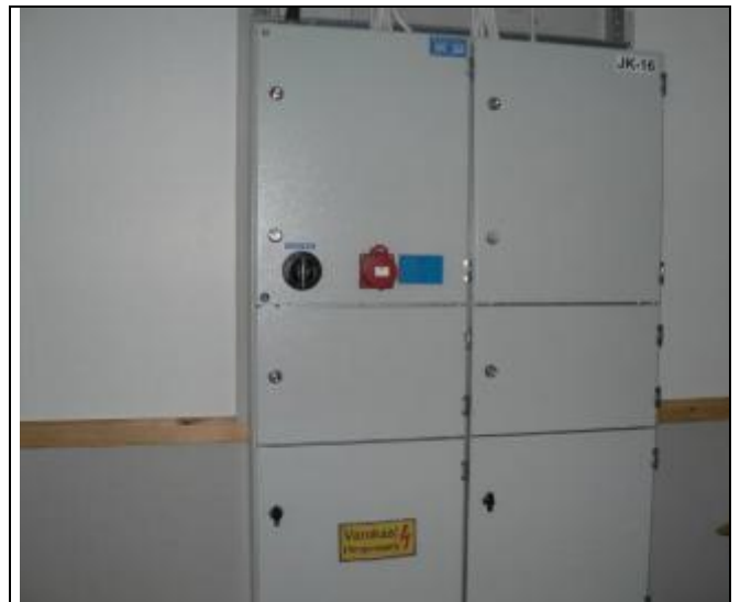
S-kuva 4. Yleiskuva teknisen työn luokan ryhmäkeskuksesta.
