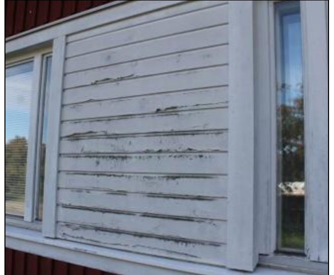
RAK-kuva 22. Laajennusosan länsipuolen julkisivuverhousta. Maalauspinnat hilseilevät, maalipintoihin tarttuu epäpuhtauksia.
