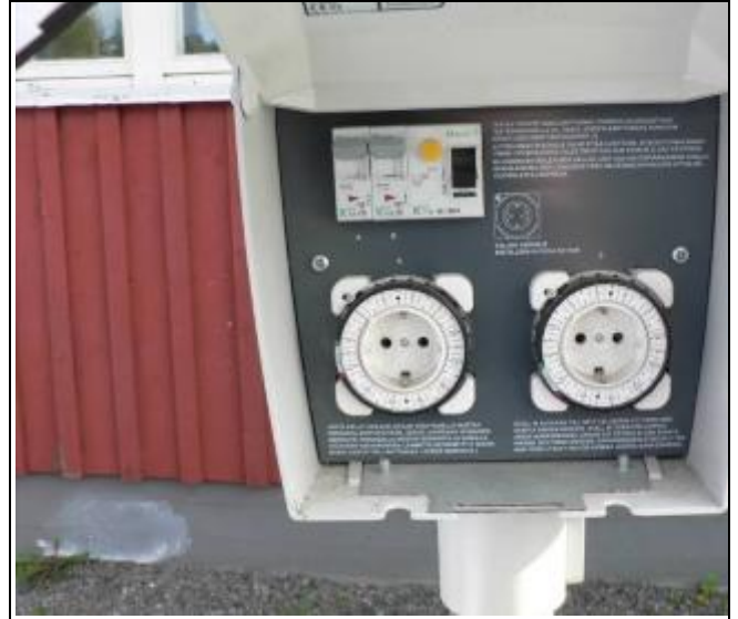
S-kuva 10. Yleiskuva uudemmassa autolämmityspistorasiasta.
