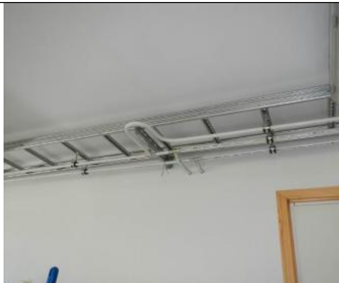
LVI-kuva 9. Teknisen työn putket ovat komposiittiputkea (putkia ei ole eristetty).
