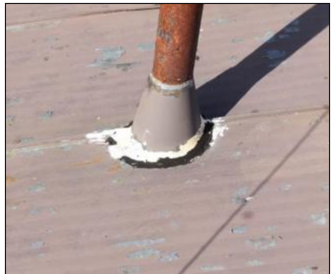
RAK-kuva 40. Yksittäinen antenniputkiläpivienti.
