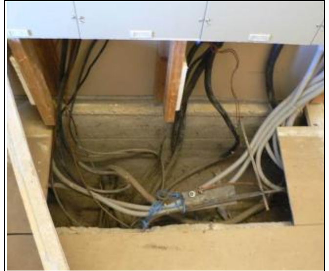
S-kuva 2. Pääkeskushuoneen lattia on korjettava.
