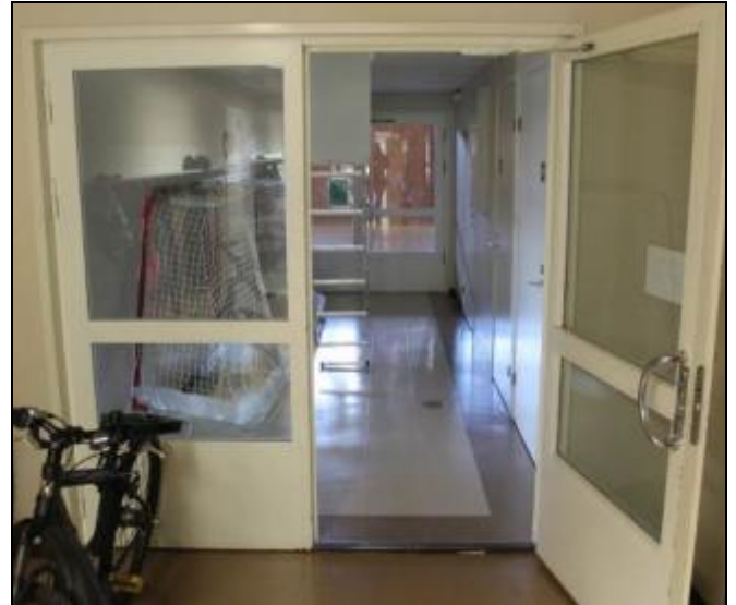
RAK-kuva 46. Osastoiva palo-ovi laajennusosan ja vanhan osan käytävällä
