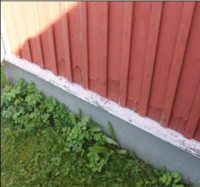
RAK-kuva 23. Liikuntasalin seinien alaosien laudoituksissa maalipinnat hilseilevät kosteuden vaikutuksesta. Laudoitusten alaosa on huoltomaalattu. Vesipellityksessä ei ole käytännössä kaatoa.
