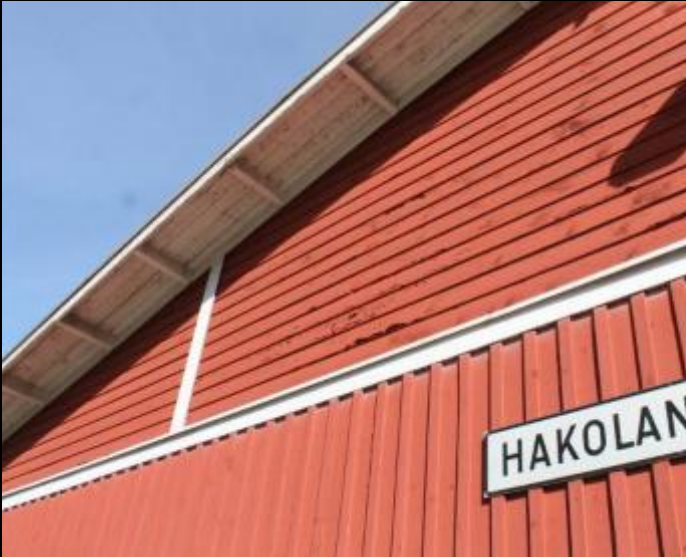
RAK-kuva 21. Laajennusosan päätykolmion puuosien maalauspinnat hilseilevät.
