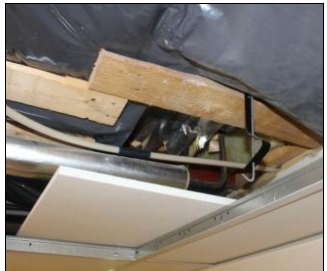
RAK-kuva Liikuntasalin pukuhuoneen edusta- käytävällä yläpohjan höyrynsulut ovat rikkonaisia.
