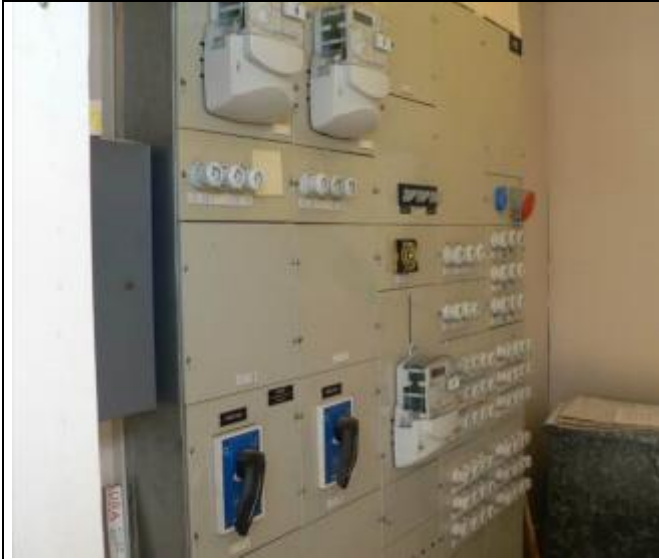
S-kuva 1. Yleiskuva pääkeskuksesta.
