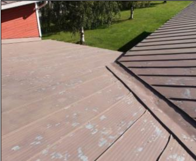
RAK-kuva 37. Vesikatteen maalipinnat hilseilevät irti.
