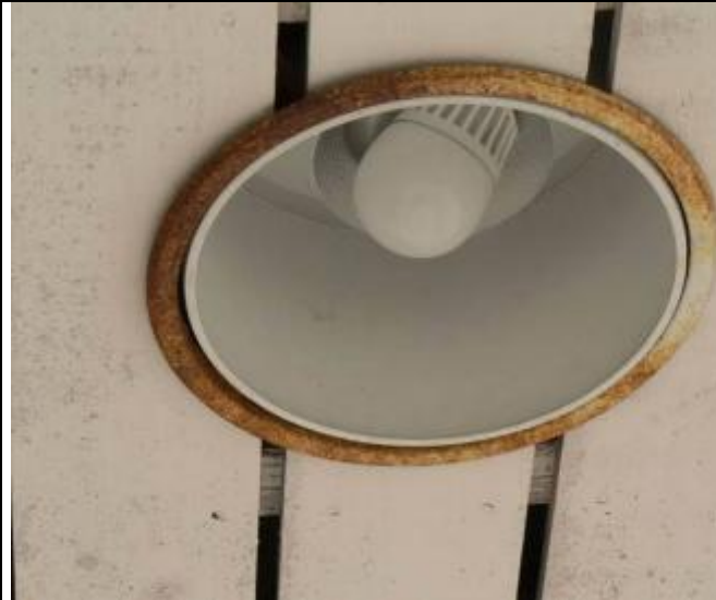
S-kuva 13. Sisäänkäyntikatoksen valaisimien rungot ovat ruostuneet.
