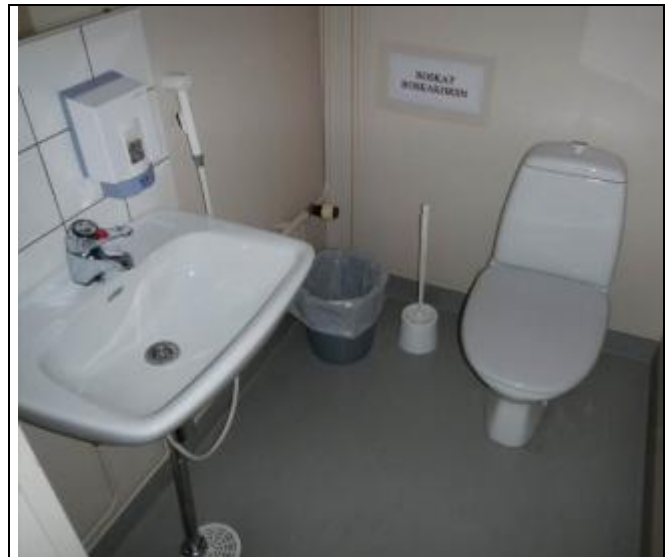
LVI-kuva 10. Yleiskuva vesi- ja viemärikalusteista.
