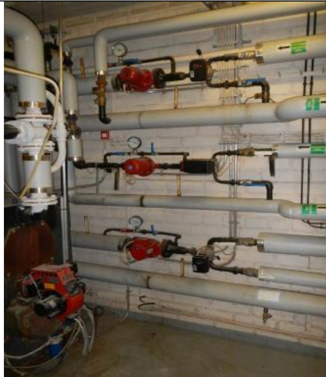
LVI-kuva 3. Yleiskuva pumppuryhmistä.
