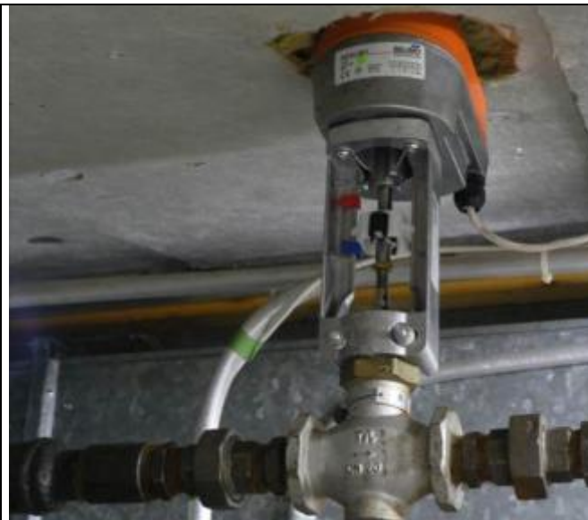
S-kuva 23. Yleiskuva moottoriventtiilistä.
