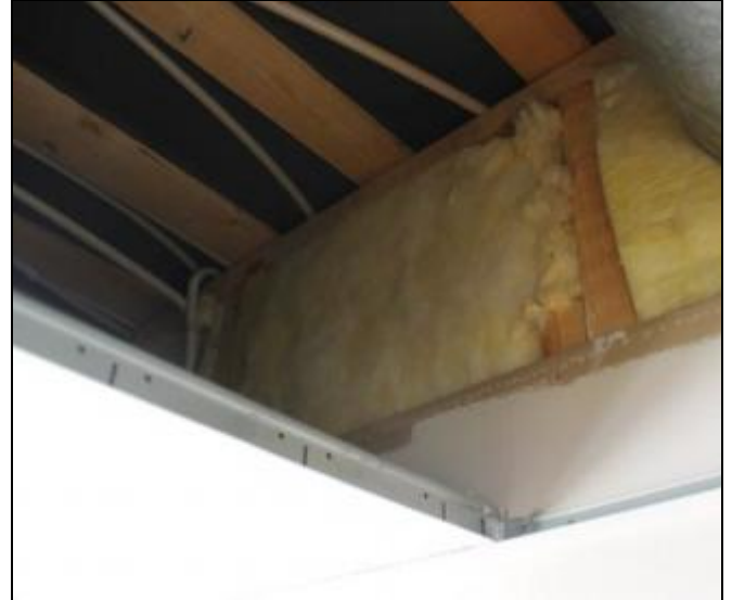
RAK-kuva 62. Laajennusosan käytävällä seinien yläosissa on avoimia mineraalivilloja.
