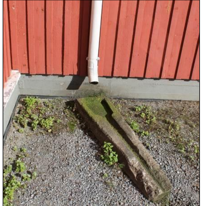
RAK-kuva 6. Kattovesien poistoa rakennuksen etelänpuolella vanhan osan ja laajennusosan kulmauksessa. Kattovedet rasittavat sokkelin vierustaa ja sokkelia. Valesokkeli on kosteusteknisesti riskialtis. Alueelle on paikallisesti asennettu patolevytys sokkelia vasten.
