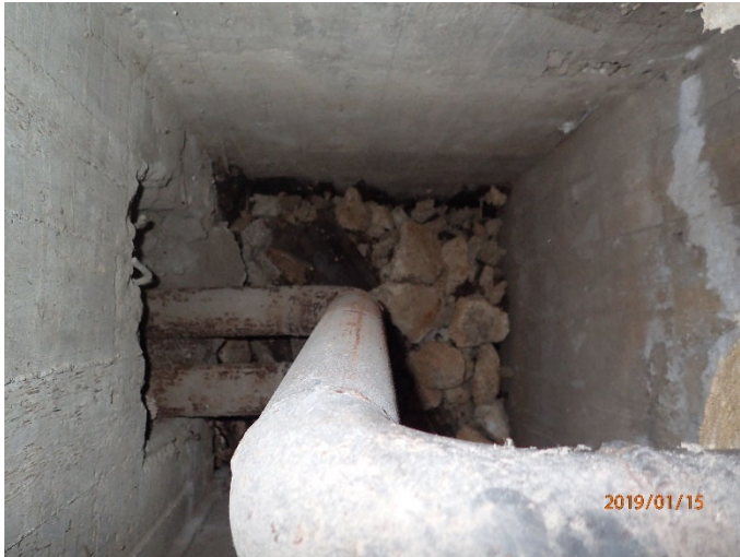
Kuva 11. Tekniikkakuilun pohjalla lahonnutta puutavaraa ja myös vanhoja eristeitä. Kuvan lämpölinja on siirtänyt lämpöenergiaa läheiselle rivitalolle. Lämpölinja ei ole enää käytössä.
