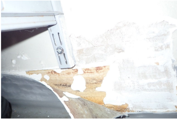
Kuva 16. Keittiön väliseinä. Liimassa näkyvää mikrobikasvustoa.
