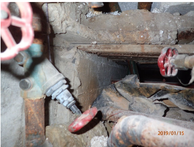
Kuva 10. Lepohuoneen lattialuukun kautta oleva näkymä tekniikkakuiluun. Kuilussa muottipuutavaraa ja muuta orgaanista materiaalia.
