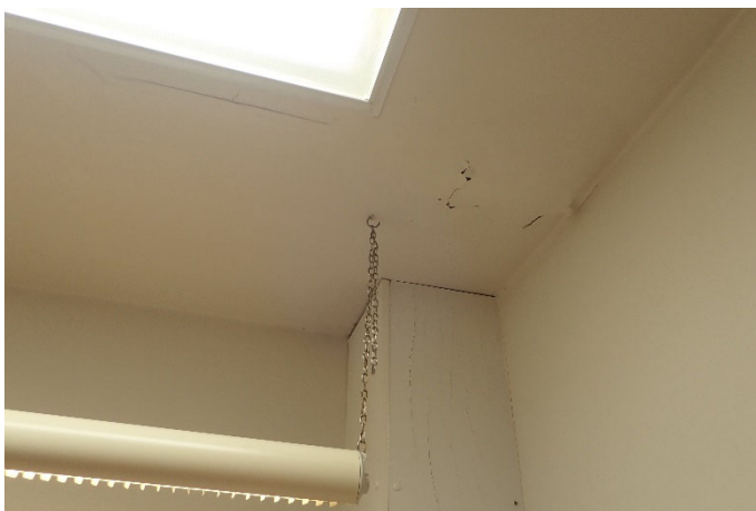
Kuva 15. Emännän huoneen vesivuotojälkiä
