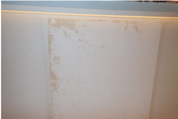
Kuva 13. Laajennusosan 1998 alakatoissa paikoitellen kosteusjälkiä.
