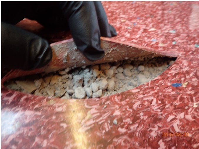
Kuva 4. Vuoden 1968 alapohjarakenteet ovat huonossa kunnossa
