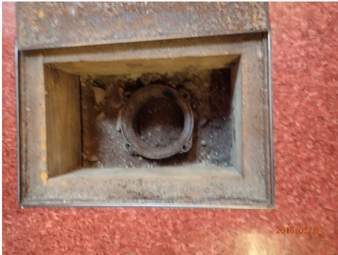
Kuva 5. Epätiividen viemärin tarkastusluukkujen kautta pääsee epäpuhtauksia sisäilmaan
