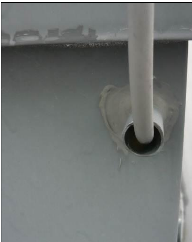
S- kuva 9. Kaapelin läpimeno on huonosti tiivistetty.
