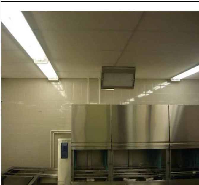
S- kuva 13. Yleiskuva keittiön kojeista.
