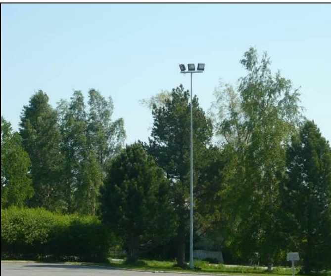
S-kuva 1. Yleiskuva linja-autojen kääntöpaikan pylväsvalaisimesta.
