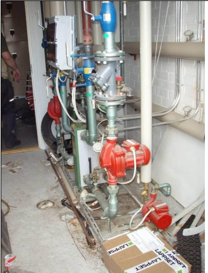
LVI- kuva 1. Yleiskuva lämmöntuotantolaitteista.
