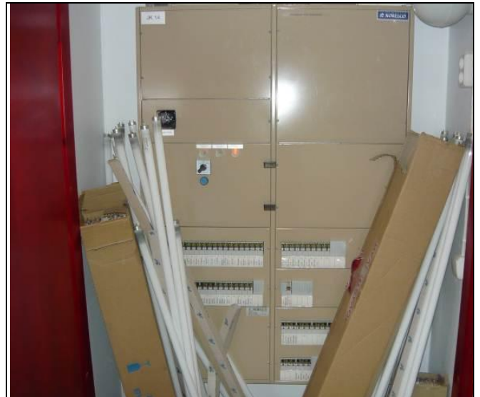
S- kuva 4. Yleiskuva jakokeskuksesta.
