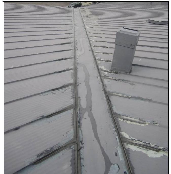
RAK-kuva 28 Yleiskuva pitkän jiirin alueelta. Jii- rinpohjalla peltien saumoja on tii- vistetty teippauksin ja massauksin.
