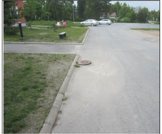
RAK-kuva 2 Asfaloitua kulkuväylää. Sadevesikaivo on osin ympäristöään korkeammalla
