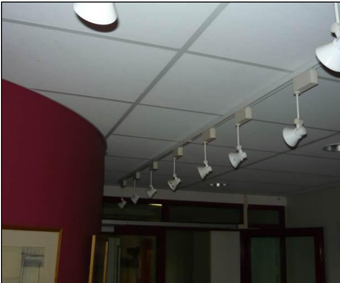
S- kuva 11. Yleiskuva aulan valaistuksesta.
