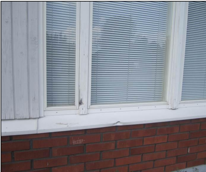
RAK-kuva 17 Ikkunarakenteita. Puuosien maalauspinnat hilseilevät. Vesipellityksissä on yksittäisiä mekaanisia kolhuja
