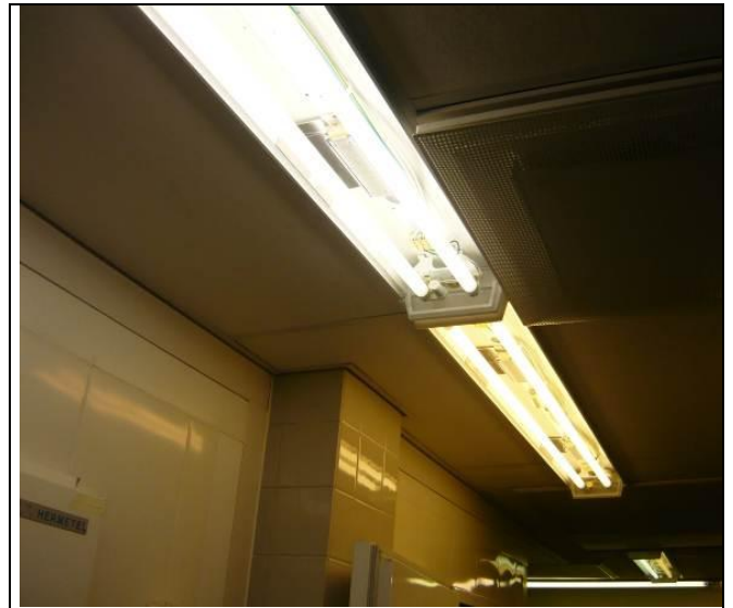
S- kuva 12. Keittiön valaisimista puuttuu kuvat.
