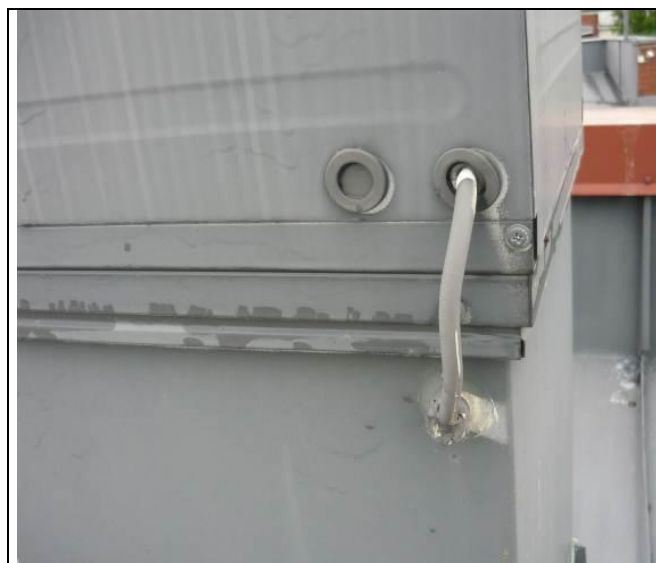
S- kuva 8. Poistopuhaltimessa ei ole turvakytkintä .
