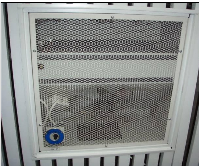
LVI- kuva 3. Yleiskuva tuulikaappikojeesta.
