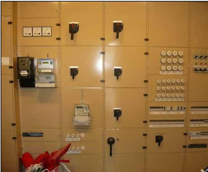
S- kuva 3. Yleiskuva sähköpääkeskuksesta.
