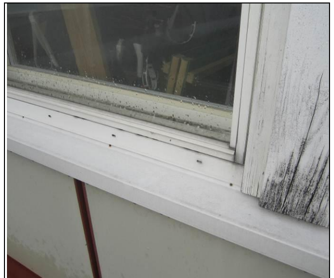
RAK-kuva 20 Ikkunarakenteita. Puuosien maalauspinnat hilseilevät.
