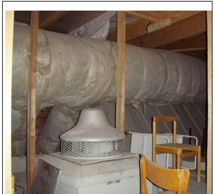
LVI-kuva 12. Yleiskuva yläpohjan kanava-asennuksista.
