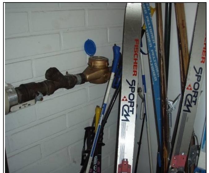
LVI- kuva 4. Yleiskuva vesimittarista ja pääsulkuventtiileistä.
