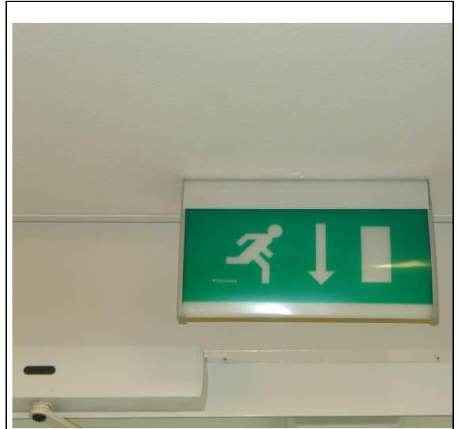
S- kuva 16. Yleiskuva poistumistievalaisimesta.
