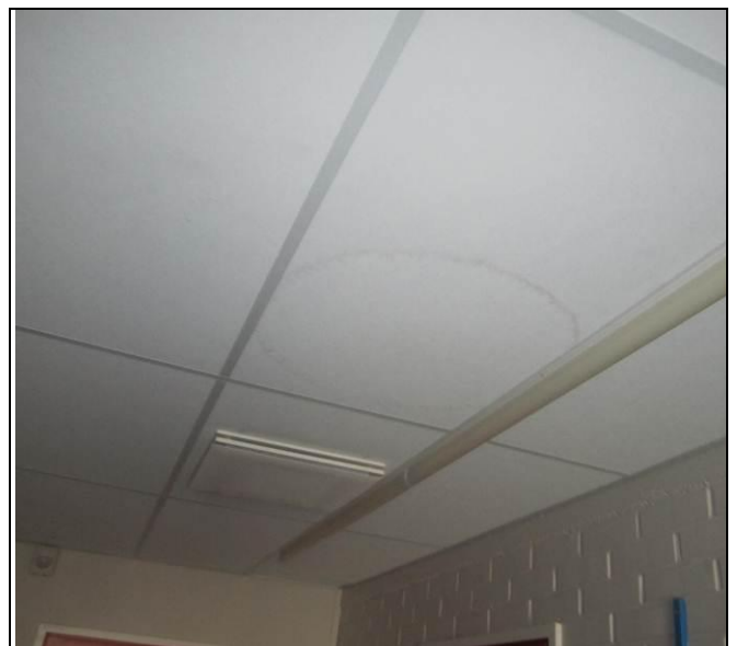
RAK-kuva Käytävän alakaton kosteusjälkiä 40
