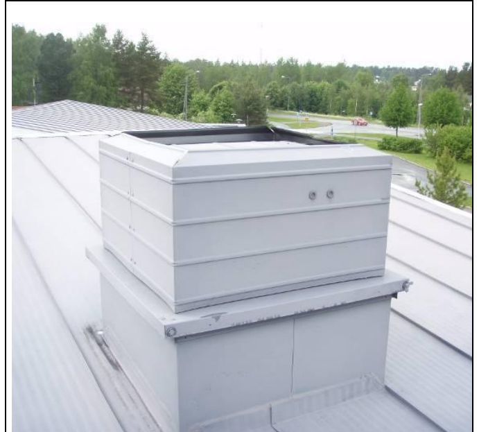
LVI-kuva 10. Yleiskuva vesikatolla olevista paikallispoistoista.
