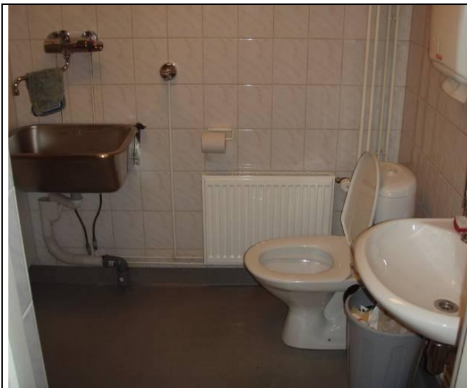
LVI- kuva 5. Yleiskuva vesi- ja viemärikalusteista.
