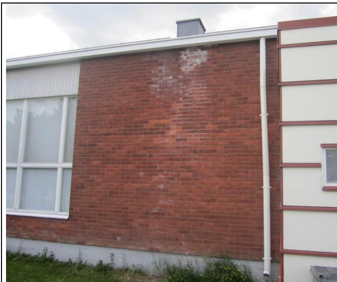
RAK-kuva 15 Julkisivun tiiliverhouksessa kalkki-juovia, jotka viittaavat rakenteessa olleeseen kosteuteen
