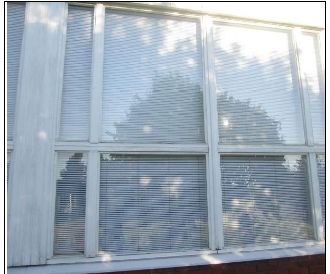
RAK-kuva 18 Ikkunarakenteita. Puuosien maalauspinnat hilseilevät.
