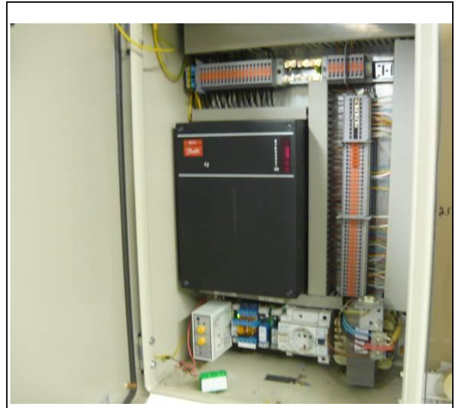
S- kuva 20. Yleiskuva rakennusautomaatiojärjestelmän alakeskuksesta.
