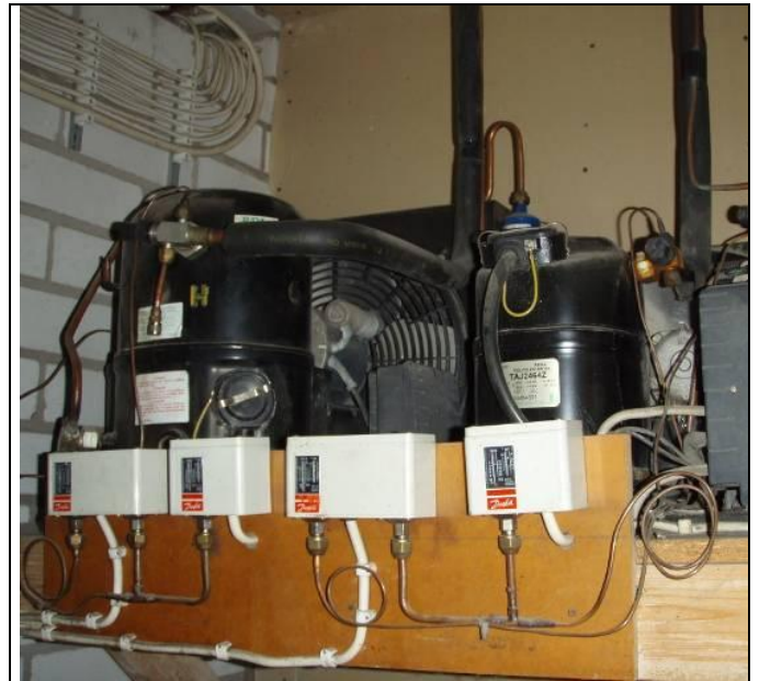
LVI-kuva 14. Yleiskuva keittiön kylmälaitteista.
