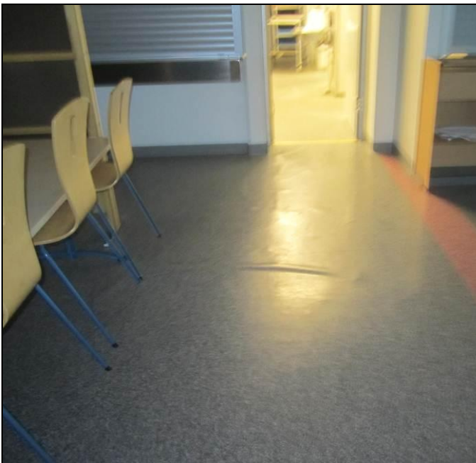
RAK-kuva 11 Ruokasalin lattiapinnoite kupruilee
