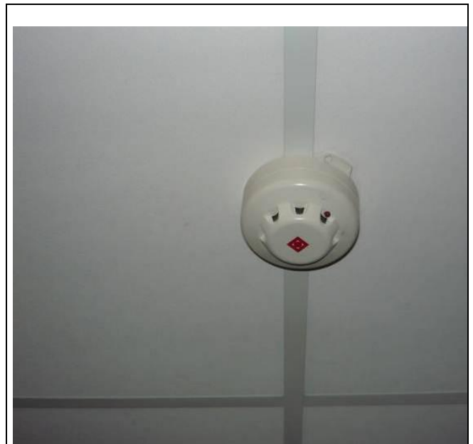
S- kuva 14. Yleiskuva käytävän palo-ovien ilmaisimesta.
