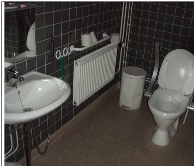
LVI- kuva 6. Yleiskuva vesi- ja viemärikalusteista
