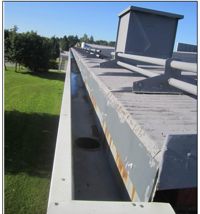
RAK-kuva 30 Vesikatteen maalauspinnat hilseilevät. Kouruissa on osin ruostevaurioita
