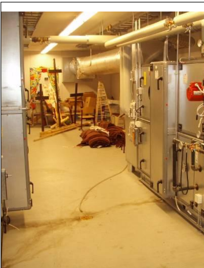
LVI- kuva 7. Yleiskuva TK1.1/PK1.1 koneesta.
