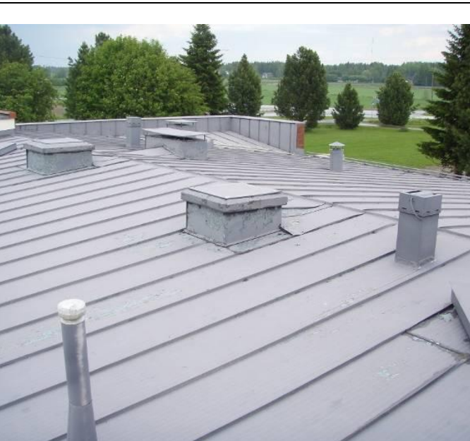
LVI-kuva 11. Yleiskuva vesikatolla olevista paikallispoistoista.
