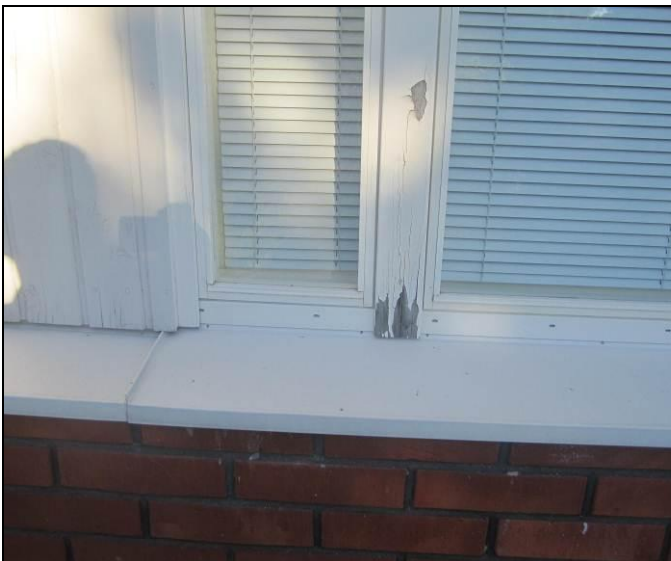
RAK-kuva 19 Ikkunarakenteita. Puuosien maalauspinnat hilseilevät.
