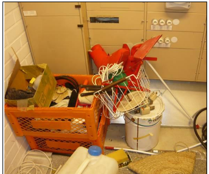
S-kuva 2. Yleiskuva pääkeskushuoneesta.
