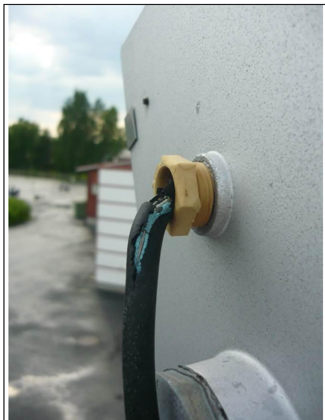
S- kuva 10. Kumikaapeli on vaarallinen ja välittömästi uusittava.
