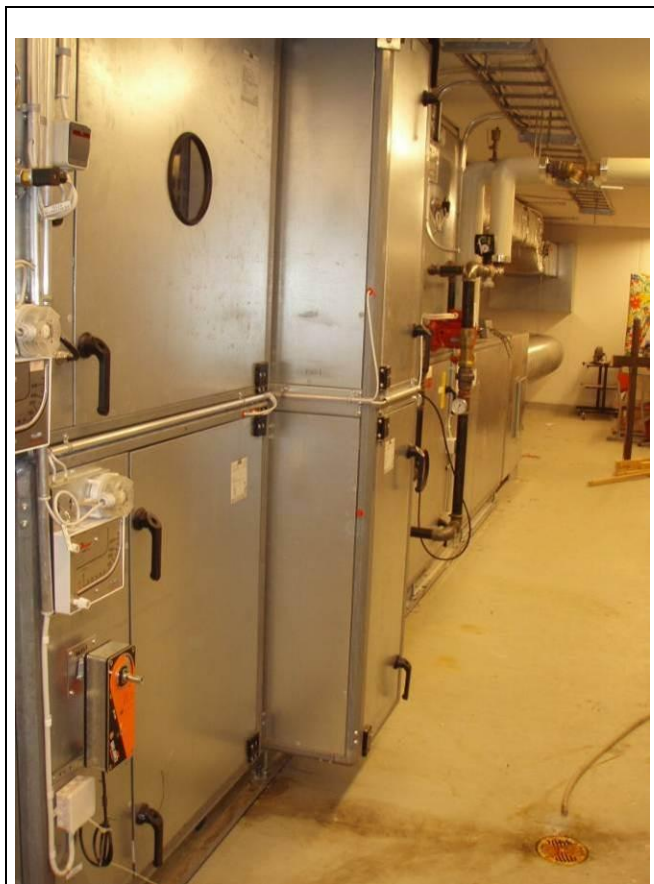
LVI- kuva 8. Yleiskuva TK1.2/PK1.2 koneesta.
