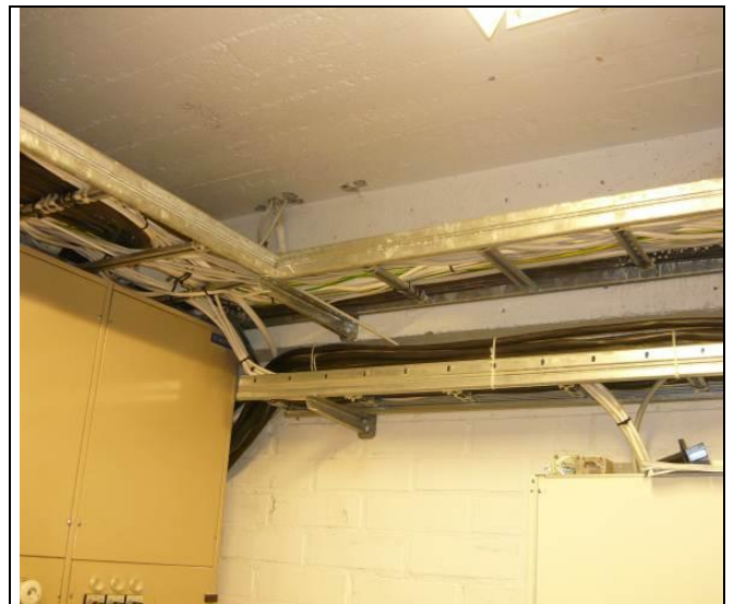
S- kuva 6. Yleiskuva kaapelihyllyistä.
