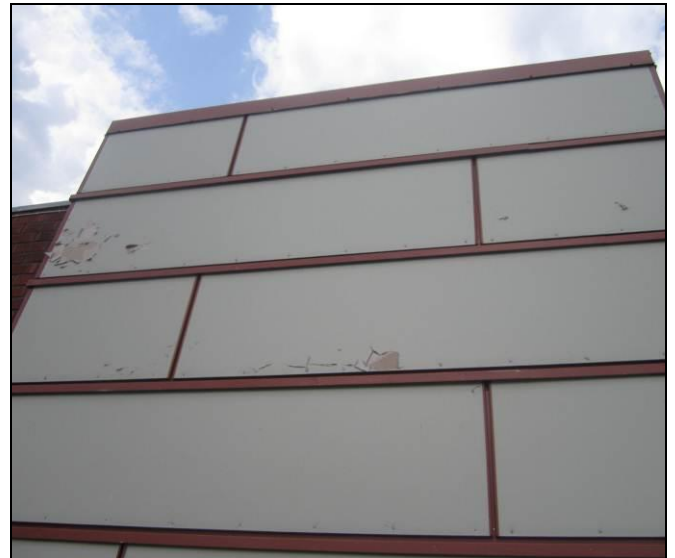
RAK-kuva 14 Levyverhousten osalla esiintyy maalauspinnoitteiden hilseilyä
