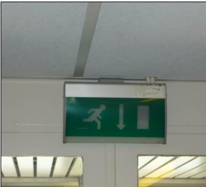
S-kuva 11. Yleiskuva pimeästä poistumistievalaisimesta.
