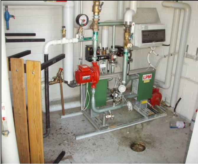
LVI- kuva 1. Yleiskuva lämmöntuotantolaitteista.
