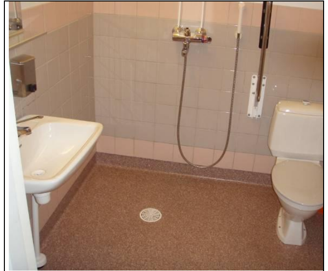
LVI- kuva 6. Yleiskuva vesi- ja viemärikalusteista.
