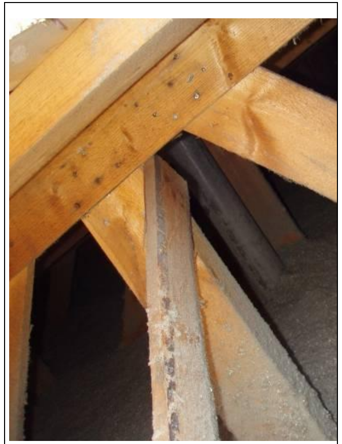
LVI- kuva 8. Tuuletusviemäri on eristämättä yläpohjassa.
