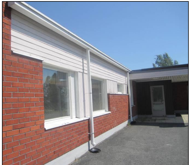
RAK-kuva 4 Kattovesien poistot on johdettu erilliseen sadevesijärjestelmään
