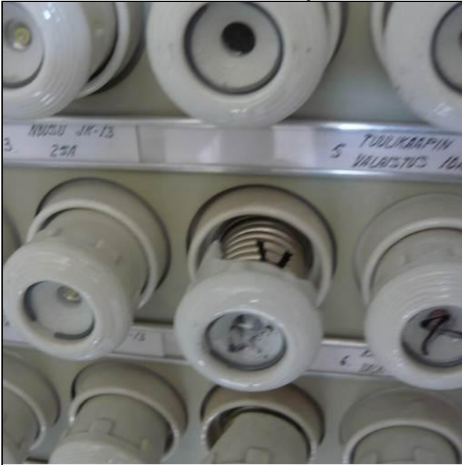
S-kuva 5. Rikkinäinen varokekansi tulee uusiksi.
