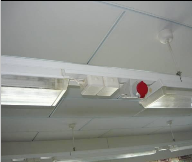
S-kuva 9. Yleiskuva teknisen työn opetustilan valaisimista.
