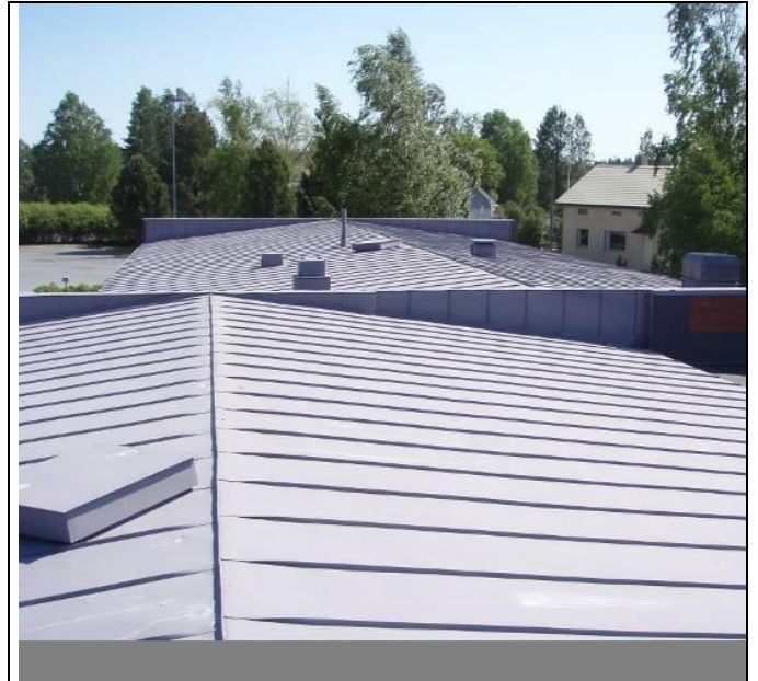
LVI- kuva 10. Yleiskuva vesikatolla olevista laitteista.
