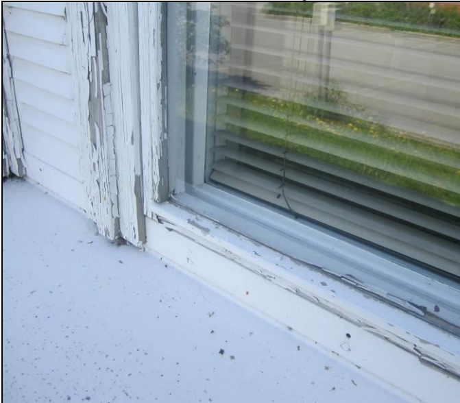
RAK-kuva 13 Ikkunoiden puuosissa on maalipinoitevaurioita. Vesipeltien maali-pinnat ovat kuluneet
