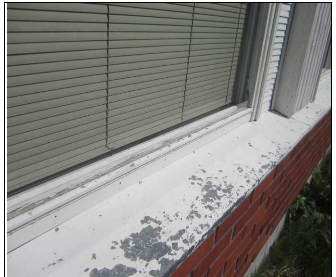
RAK-kuva 12 Ikkunoiden puuosissa on maalipinoitevaurioita. Vesipeltien maalipinnat ovat kuluneet
