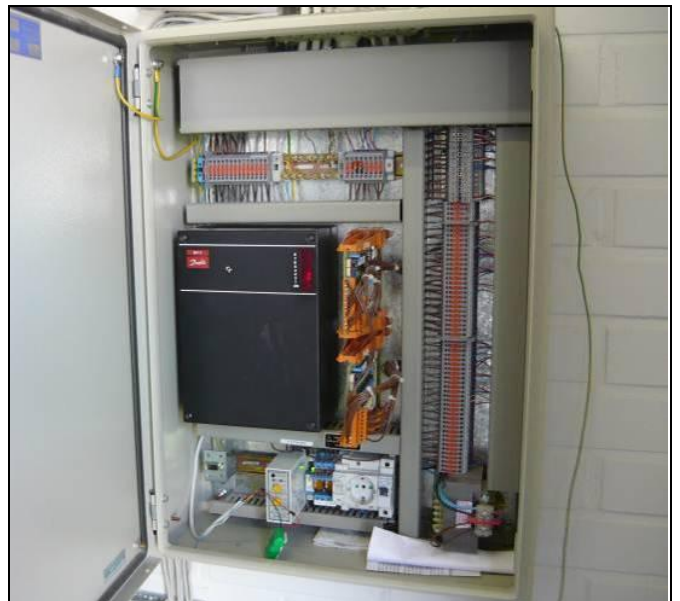
S-kuva 12. Yleiskuva rakennusautomaation alakeskuksesta.
