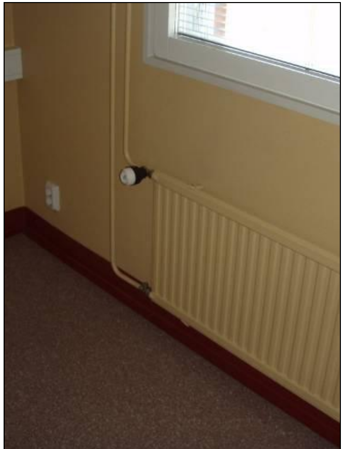
LVI- kuva 4. Yleiskuva lämpöpatterista ja patteriventtiilistä
