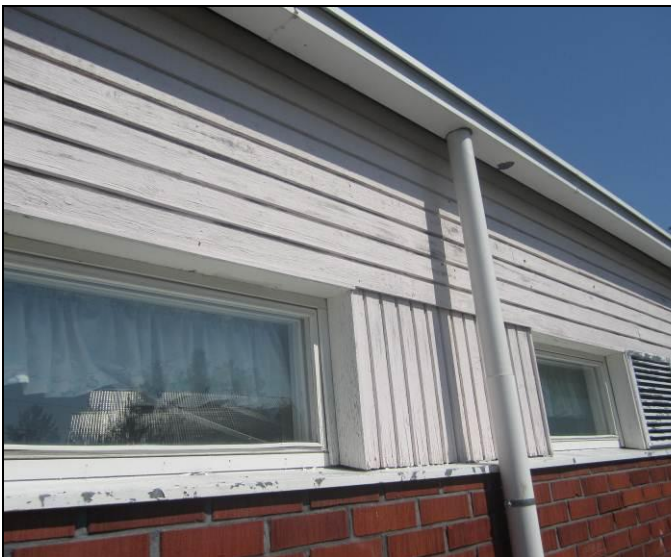
RAK-kuva 7 Julkisivun puuverhouksia. Puuverhousten maalipinnat ovat kuluneita
