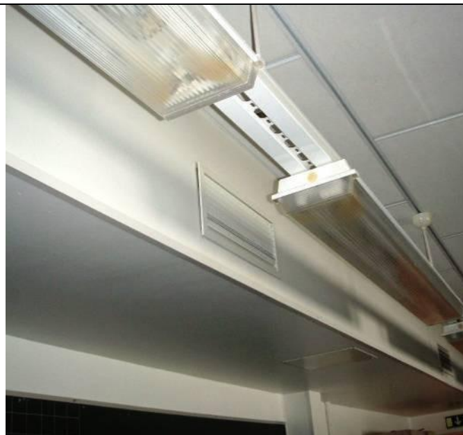
LVI- kuva 11. Tuloilmasäleet ovat osittain väännetty kiinni.
