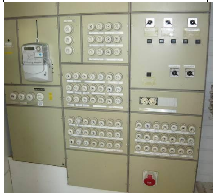
S-kuva 4. Yleiskuva pääkeskuksesta.
