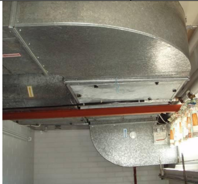
LVI- kuva 9. Yleiskuva tulo- ja poistoilmakoneesta.
