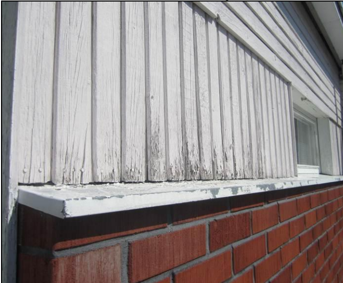
RAK-kuva 9 Julkisivun puuverhouksia. Puuverhousten maalipinnat ovat kuluneita
