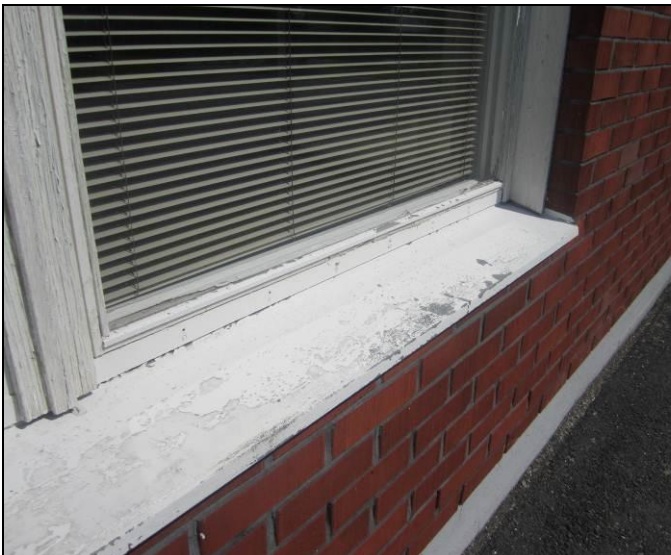
RAK-kuva 11 Ikkunoiden puuosissa on maalipinoitevaurioita. Vesipeltien maalipinnat ovat kuluneet
