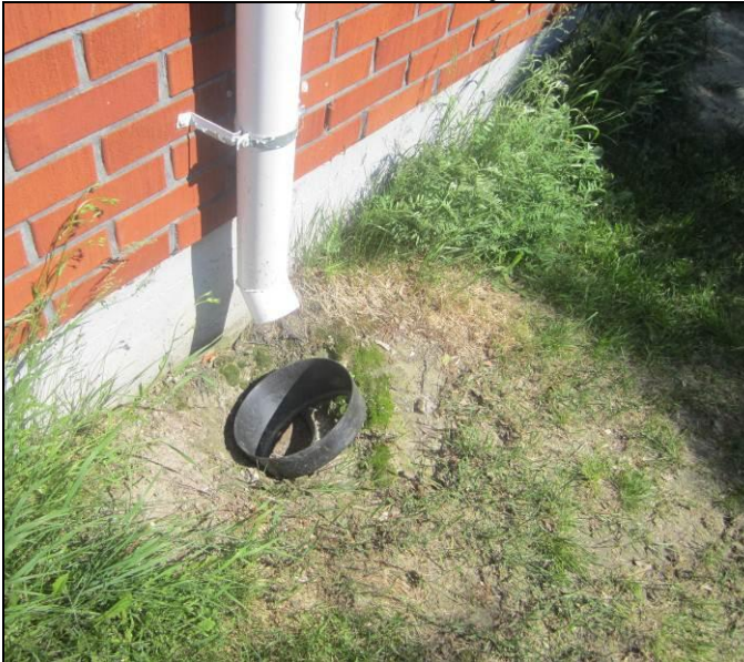
RAK-kuva 5. Vaurioitunut sadevesisuppilo
