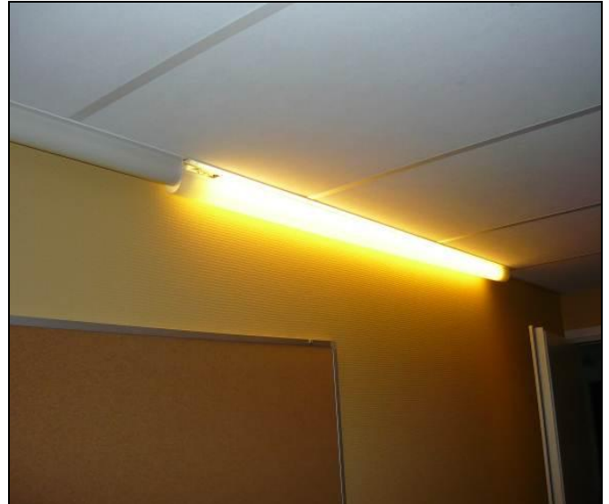
S-kuva 10. Käytävän valaisimen kupu on irronnut
