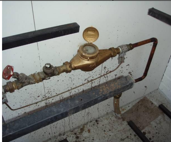
LVI- kuva 5. Yleiskuva vesimittarista ja pääsulkuventtiileistä
