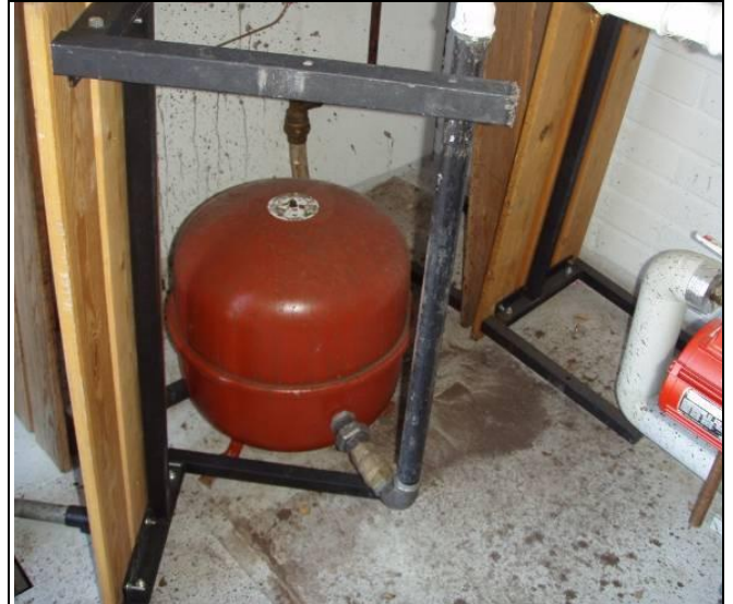
LVI- kuva 2. Yleiskuva varolaitteista.
