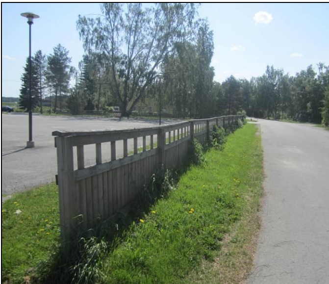
RAK-kuva 3 Puurakenteinen raja-aita. Aita on tyydyttäväkuntoinen
