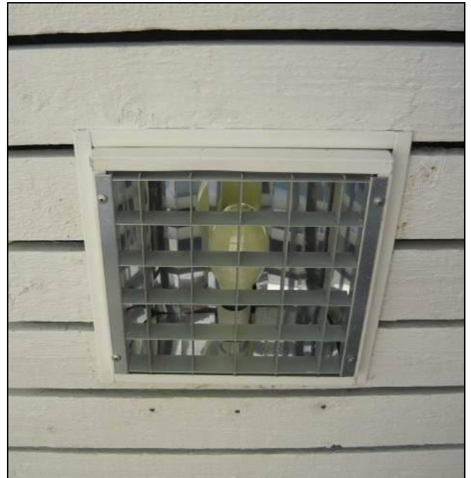
S-kuva 2. Yleiskuva sisäänkäynnin valaisimesta.
