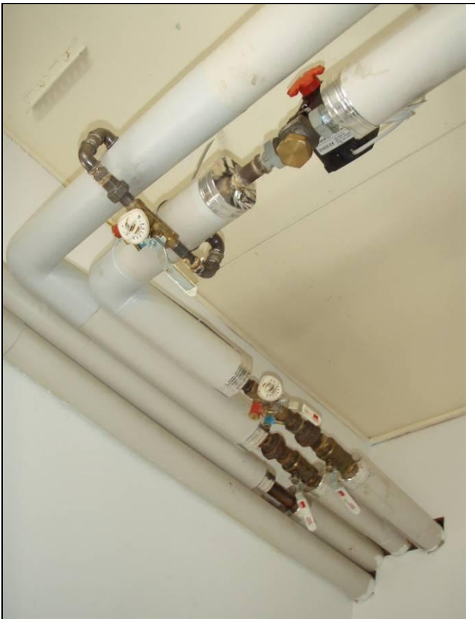
LVI- kuva 3. Yleiskuva lämpöverkoston linjaventtiileistä.
