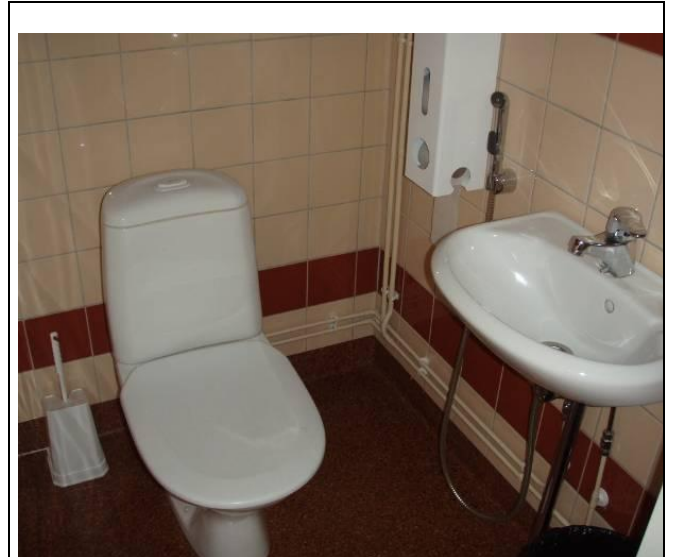
LVI- kuva 6. Yleiskuva vesi- ja viemärikalusteista
