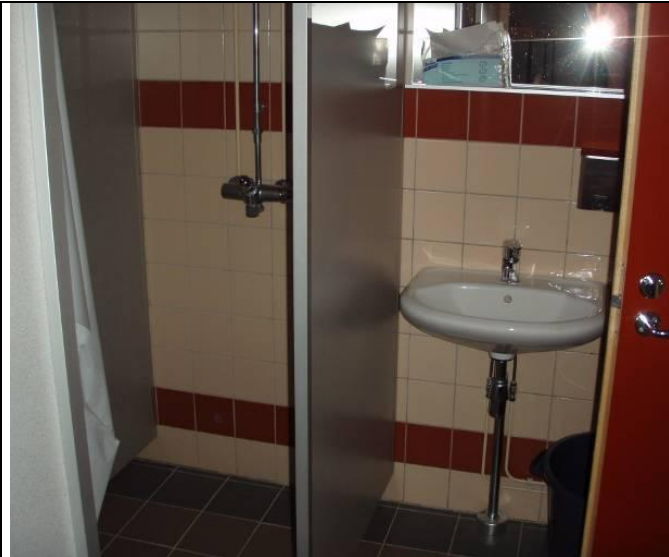
LVI- kuva 5. Yleiskuva vesi- ja viemärikalusteista.
