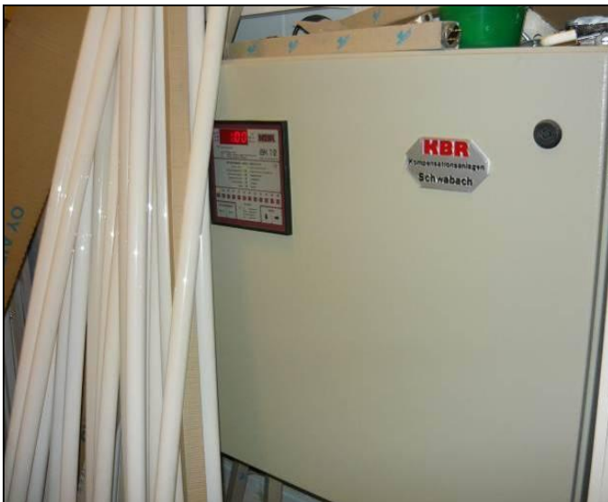
S- kuva 7. Yleiskuva kompensointiparistosta.
