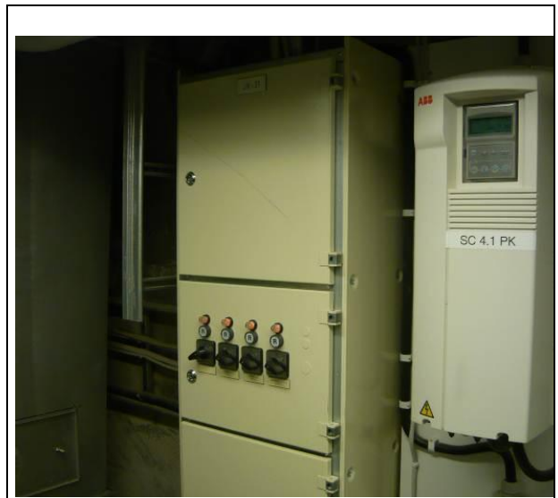
S- kuva 6. Yleiskuva IV-konehuoneen keskuksesta.
