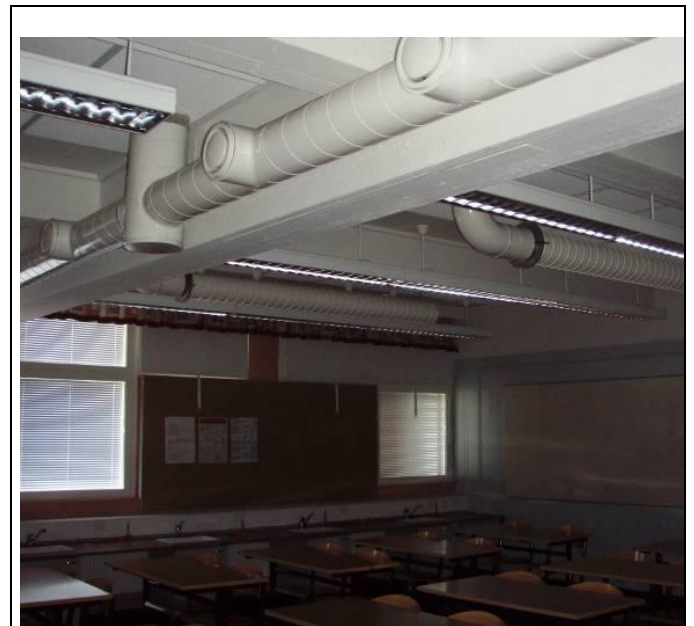
LVI- kuva 12. Yleiskuva luokkatilan päätte-elimistä.
