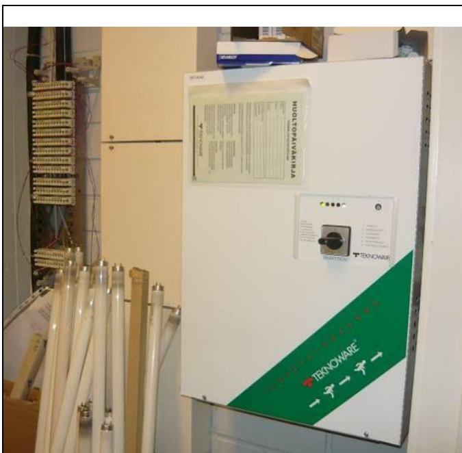
S-kuva 13. Yleiskuva turvavalaistuskeskuksesta.
