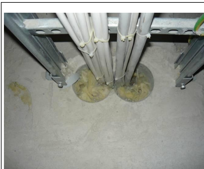
S- kuva 9. Lämpivientien palokatkot ovat puutteellisia.
