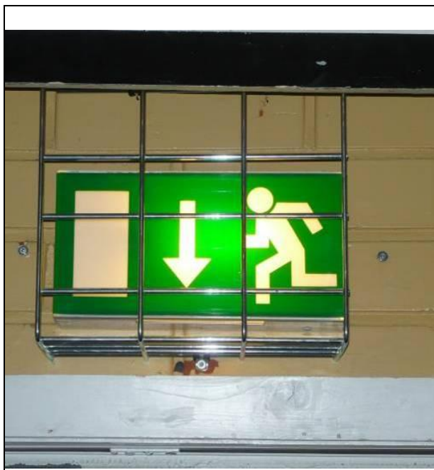
S-kuva 14. Yleiskuva poistumistievalaisimesta.
