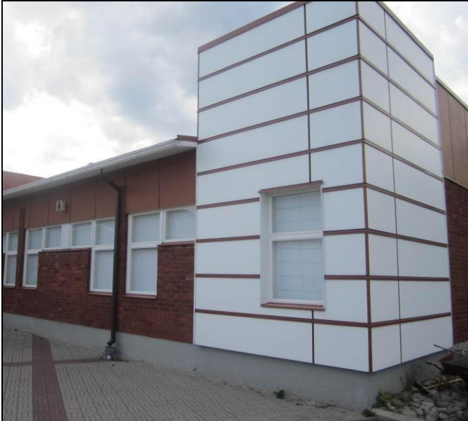
RAK-kuva 9 Levyverhoiltuja julkisivuja. Julkisivupinnat kokonaisuutena ovat tyydyttävässä kunnossa
