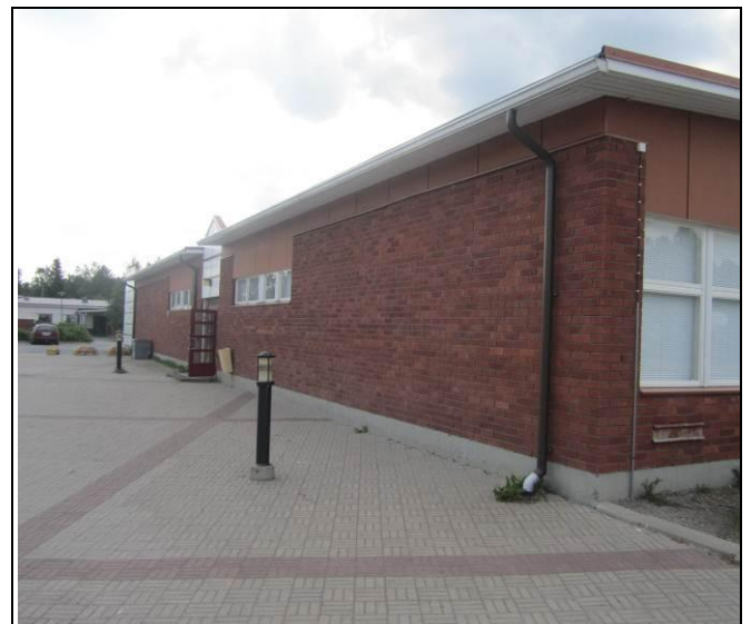
RAK-kuva 8 Tiili- ja levyverhoiltuja julkisivuja. Julkisivupinnat kokonaisuutena ovat tyydyttävässä kunnossa
