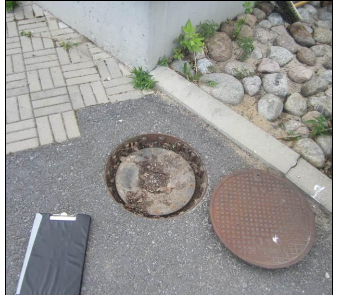
RAK-kuva 6. Salaojan tarkastuskaivo
