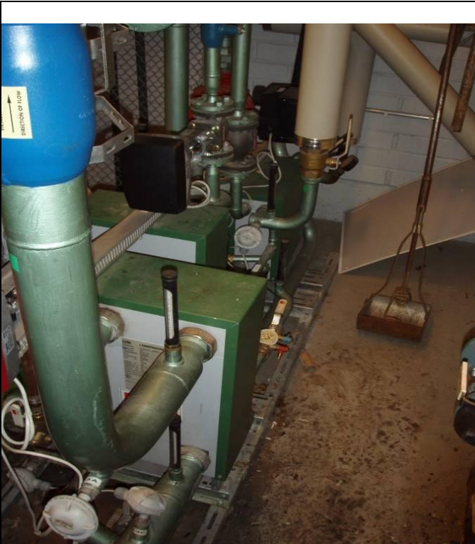
LVI- kuva 1. Yleiskuva lämmöntuotantolaitteista.
