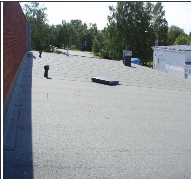
LVI- kuva 11. Yleiskuva vesikatolla olevista paikallispoistoista.
