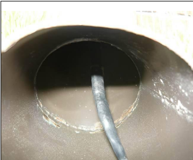
S- kuva 3. Yleiskuva syöksytorven sulanapitokaapelista.
