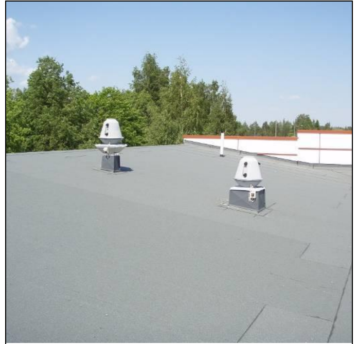
LVI- kuva 10. Yleiskuva vesikatolla olevista paikallispoistoista.
