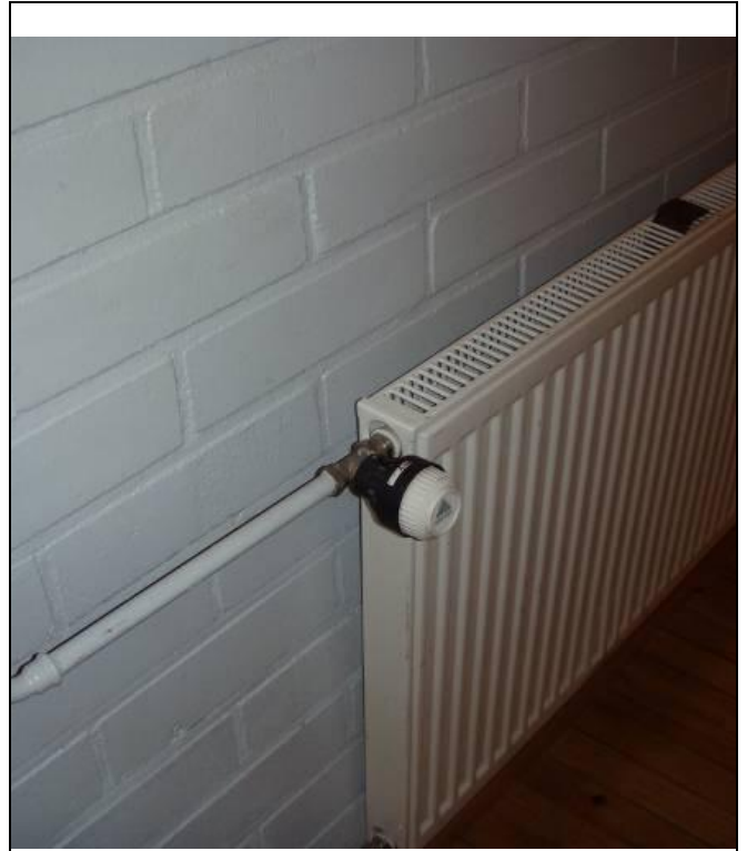
LVI- kuva 2. Yleiskuva patteriventtiilistä ja lämpöpatterista.
