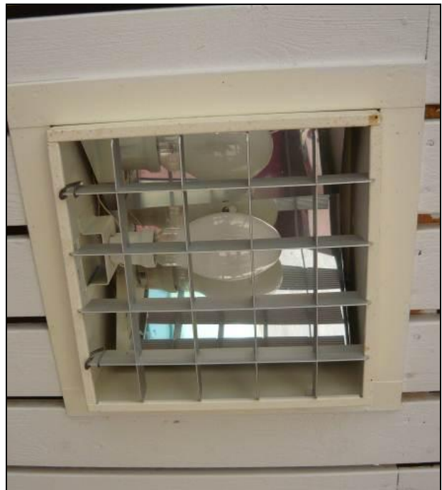
S- kuva 2. Yleiskuva sisäänkäynnin valaisimesta.
