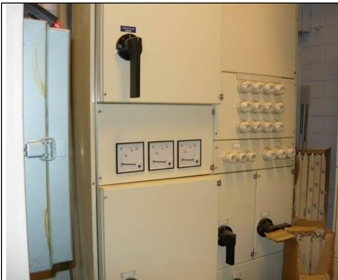
S- kuva 5. Yleiskuva pääkeskuksesta.
