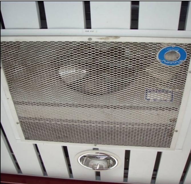
LVI- kuva 3. Yleiskuva tuulikaappikojeesta.
