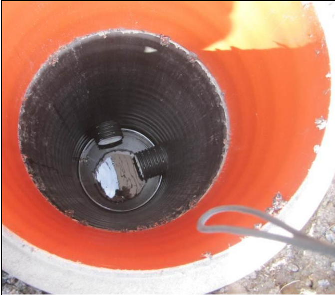
RAK-kuva 5. Salaojan tarkastuskaivo
