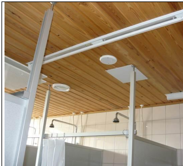
S-kuva 12. Osasta valaisimia puuttuu kupuja.
