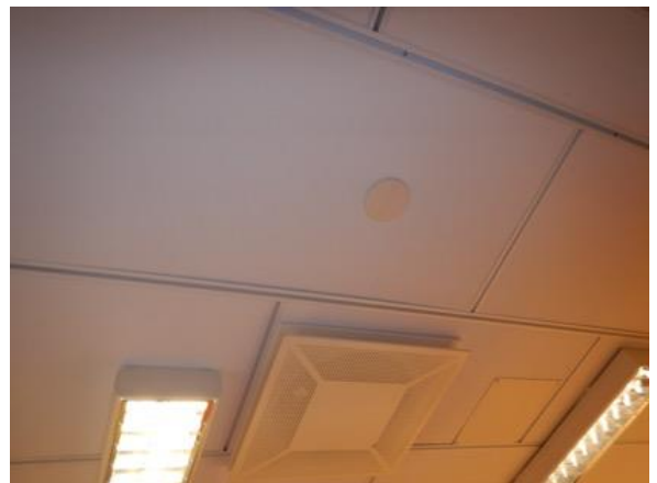
Kuva 62 Ilmanvaihdon pääte-elimissä on suojaamatonta mineraalivillaa.
