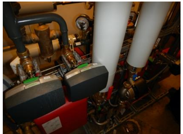
Kuva 53 Yleiskuva lämmönjakohuoneen laitteista.
