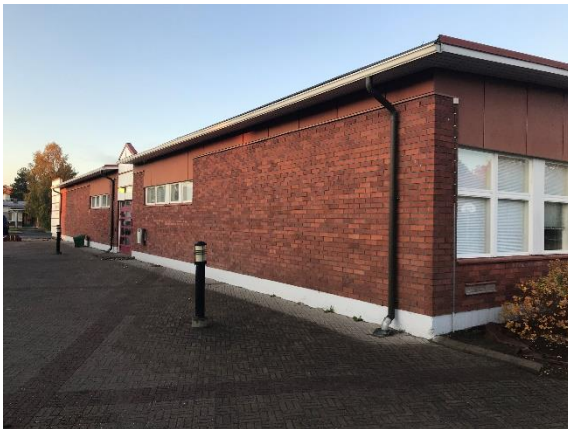
Kuva 6 Kattovesien poistot on johdettu syöksytorvista niiden alla olevien kaivojen kautta sadevesijärjestelmään.
