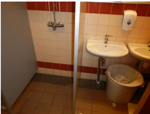
Kuva 57 Yleiskuva vesi- ja viemärikalusteista.
