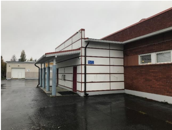
Kuva 26 Liikuntasalin pukuhuoneiden kohdalla oleva katoslippa.
