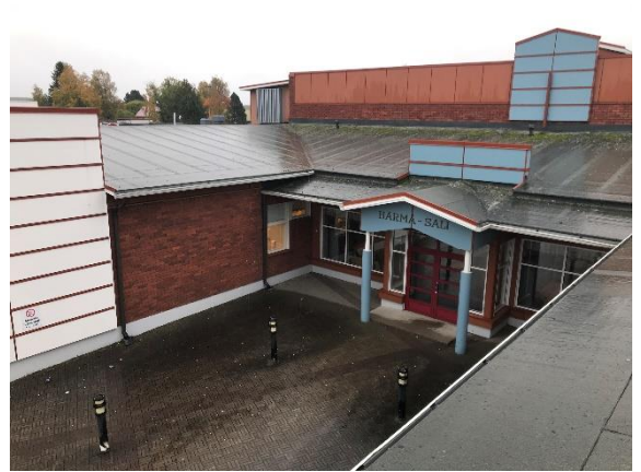
Kuva 9 Kattovesien poistot on johdettu syöksytorvista niiden alla olevien kaivojen kautta sadevesijärjestelmään.
