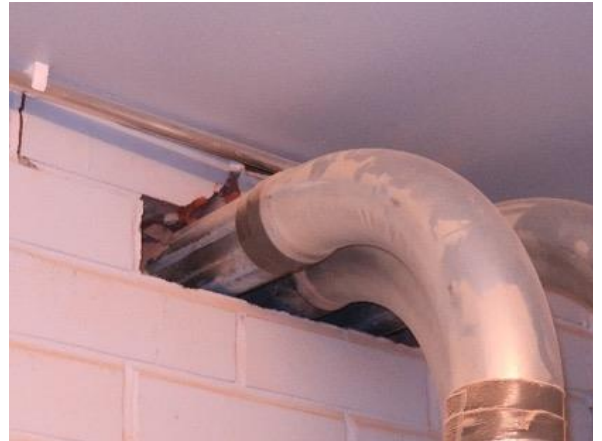
Kuva 64 Purunpoistotilan puutteellinen palokatko.
