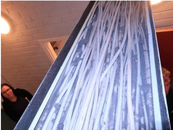
Kuva 63 Yleiskuva likaisesta kaapelihyllystä.
