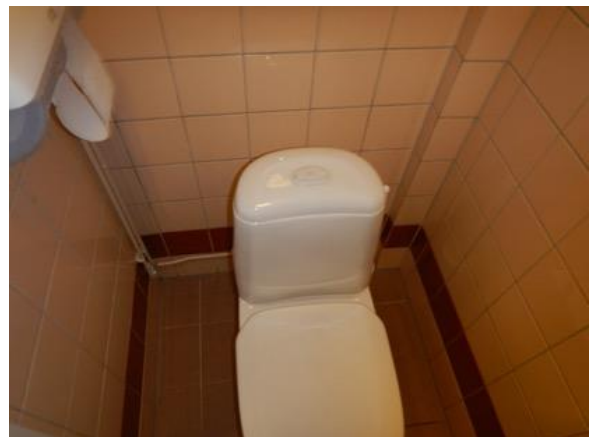
Kuva 58 Yleiskuva vesi- ja viemärikalusteista.
