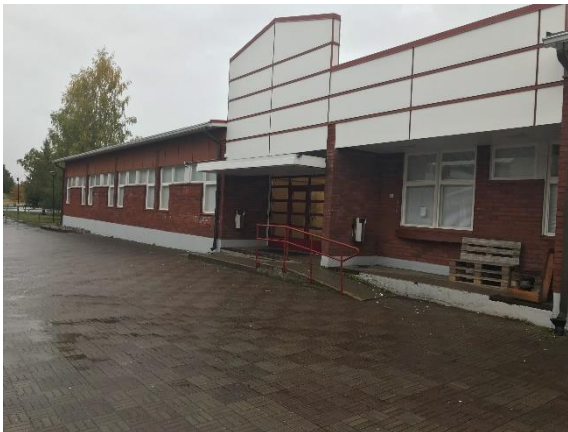
Kuva 8 Kattovesien poistot on johdettu syöksytorvista niiden alla olevien kaivojen kautta sadevesijärjestelmään.
