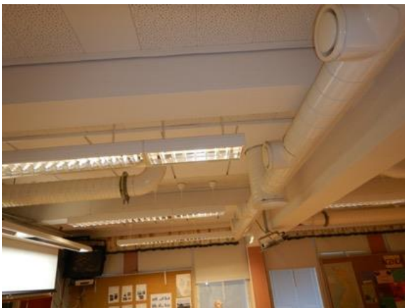
Kuva 61 Yleiskuva ilmanvaihdon pääte-elimistä.
