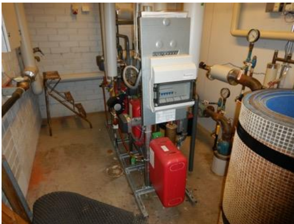
Kuva 52 Yleiskuva lämmönjakohuoneen laitteista.
