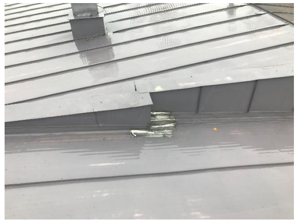
Kuva 28 Yleiskuva vesikatolta. Kulmauksessa on teippauksin paikattuja alueita (vuotojen seurauksena?).
