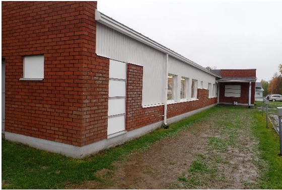
Kuva 14 Yleiskuva rakennuksen pohjoispuolen julkisivuista. Julkisivu on jonkin verran sammaloitunut.
