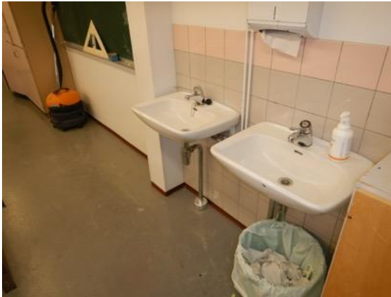
Kuva 45 Yleiskuva vesi- ja viemärikalusteista.
