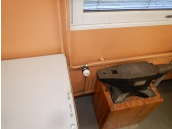
Kuva 42 Yleiskuva lämpöpatterista ja patteriventtiilistä.
