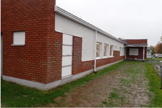
Kuva 6 Kattovesien poistot on toteutettu kattovesikouruista syöksytoria pitkin niiden alla oleviin kaivoihin.
