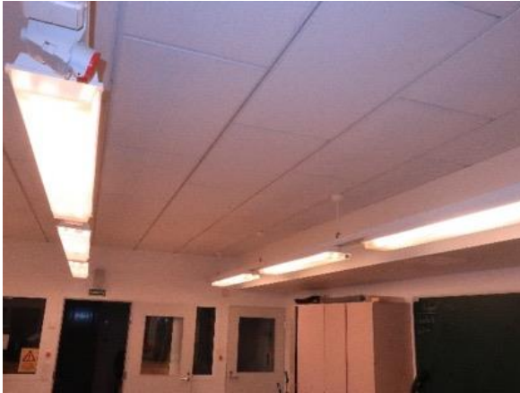
Kuva 56 Yleiskuva teknisen työn valaisimista.
