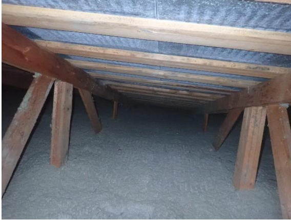
Kuva 31 Yleiskuva yläpohjatilasta. Vesikatteen alla ei ole aluskatetta. Yläpohjatilassa lämmöneristeen päällä on havaittavissa katteen kondensoinnista aiheutuneita vesijälkiä.
