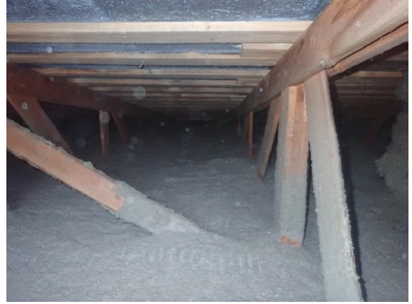
Kuva 32 Yleiskuva yläpohjatilasta. Vesikatteen alla ei ole aluskatetta. Yläpohjatilassa lämmöneristeen päällä on havaittavissa katteen kondensoinnista aiheutuneita vesijälkiä.
