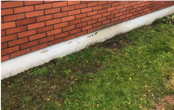
Kuva 12 Sadevesikourujen vuodon seurauksena kattovesiä roiskuu sokkeliin ja julkisivuun.
