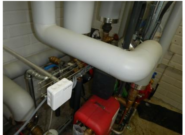
Kuva 41 Yleiskuva lämmönjakohuoneen laitteista.
