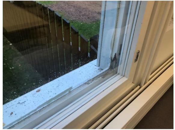
Kuva 21 Ikkunoiden ulkopuitteen puuosien maalipinnat ovat paikoin huonokuntoisia.
