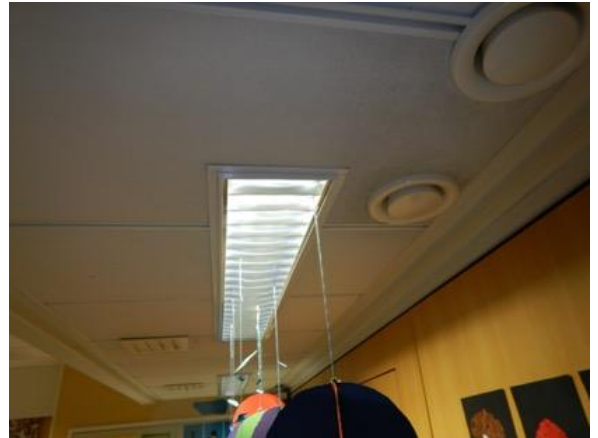
Kuva 50 Ilmanvaihdon pääte-elimissä on suojaamatonta mineraalivillaa.
