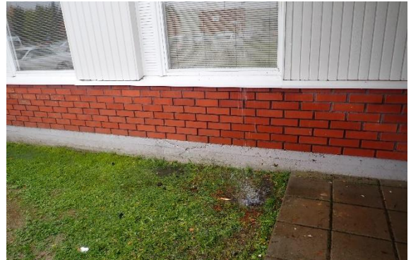
Kuva 13 Sadevesikourujen vuodon tai ylipadotuksen seurauksena kattovesiä roiskuu sokkeliin ja julkisivuun.
