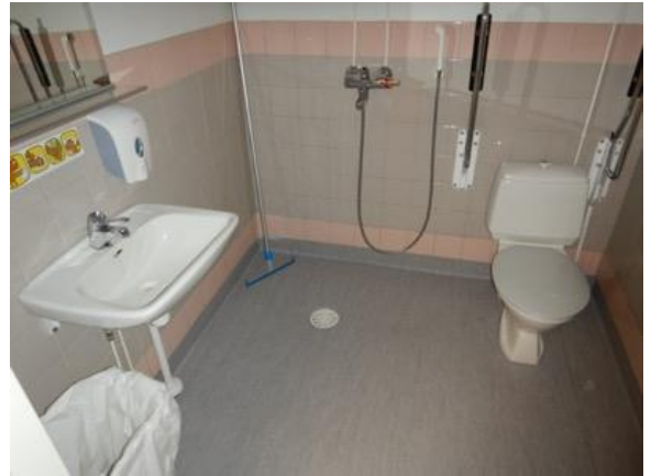
Kuva 46 Yleiskuva vesi- ja viemärikalusteista.
