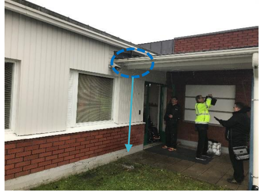
Kuva 7 Pohjoispuolen sisääntulokatoksen kattovesikouru vuotaa, vesi roiskuu ulkoseinää ja sokkeliä vasten.
