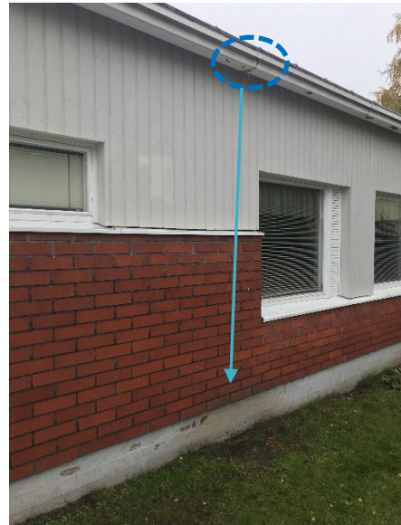
Kuva 9 Kattovesikouru vuotaa, vesi roiskuu ulkoseinää ja sokkeliä vasten.
