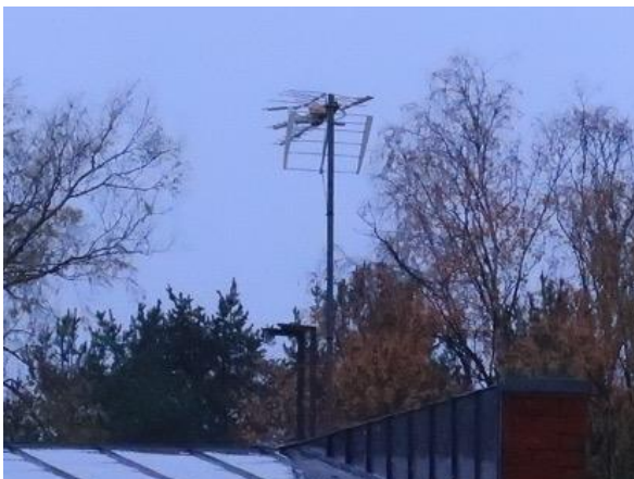
Kuva 60 Rakennuksen seinälle asennettu antenni.
