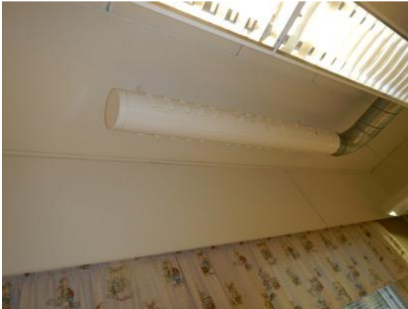
Kuva 49 Yleiskuva ilmanvaihdon pääte-elimistä.
