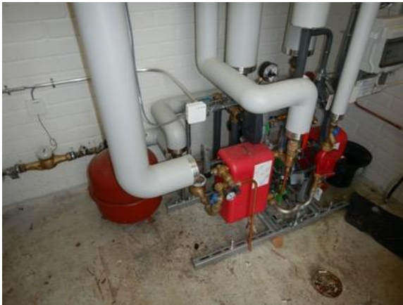
Kuva 40 Yleiskuva lämmönjakohuoneen laitteista.
