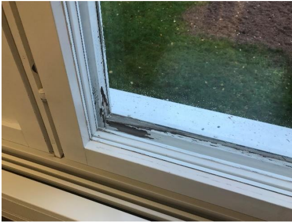
Kuva 20 Ikkunoiden ulkopuitteen puuosien maalipinnat ovat huonokuntoisia ja puuosissa on kosteudesta aiheutuvaa vaurioitumista.
