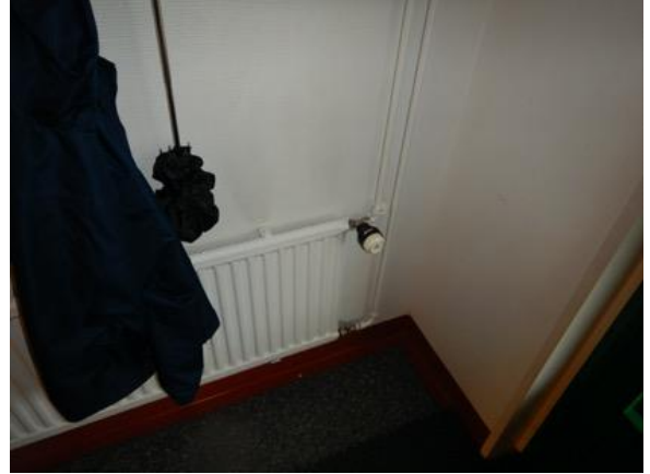
Kuva 43 Yleiskuva lämpöpatterista ja patteriventtiilistä.
